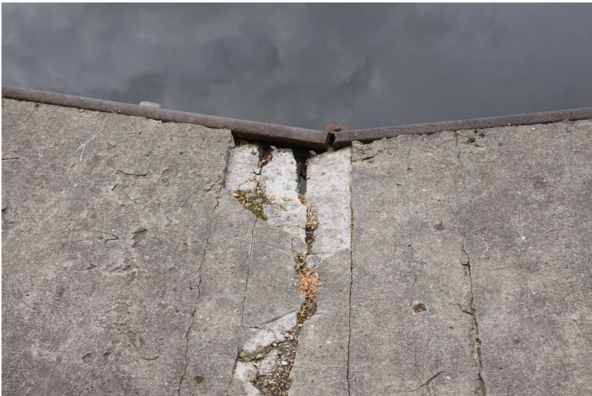
Fot. 15: Ubytek betonu w warstwie wylewki i rozpad betoników na załamaniu linii nabrzeża
