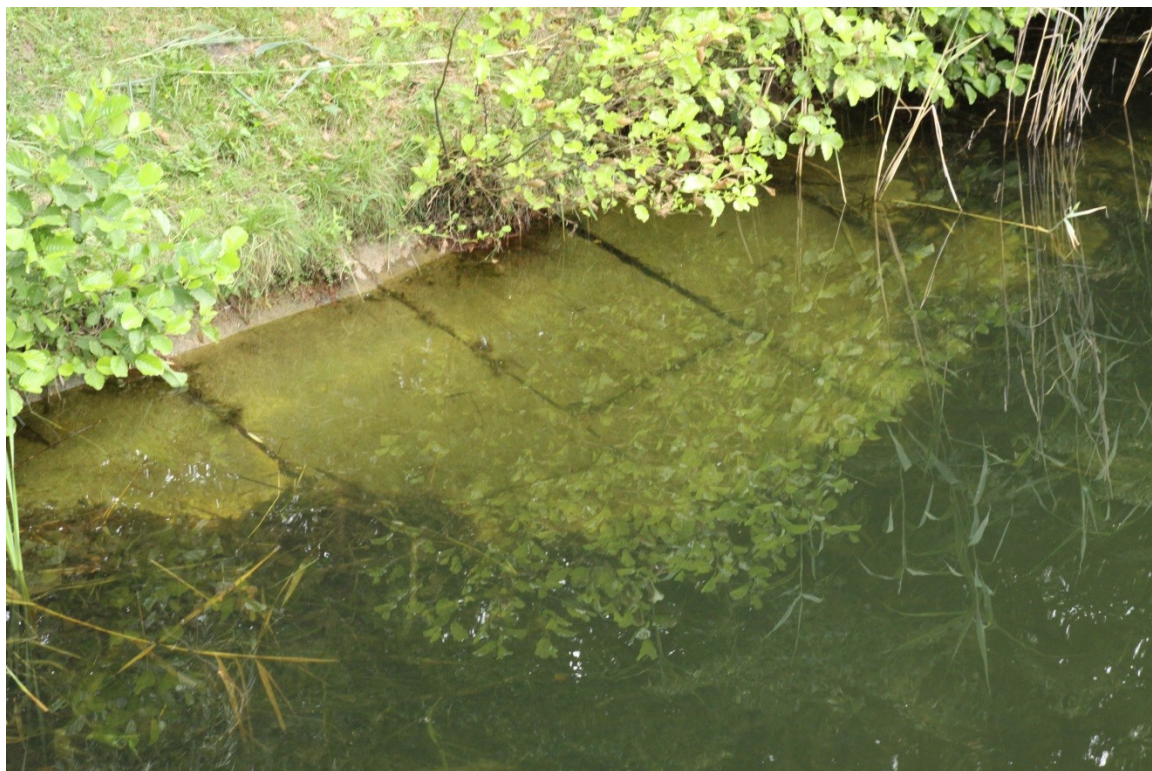
Fot. 18: Stan techniczny ubezpieczeń skarp
