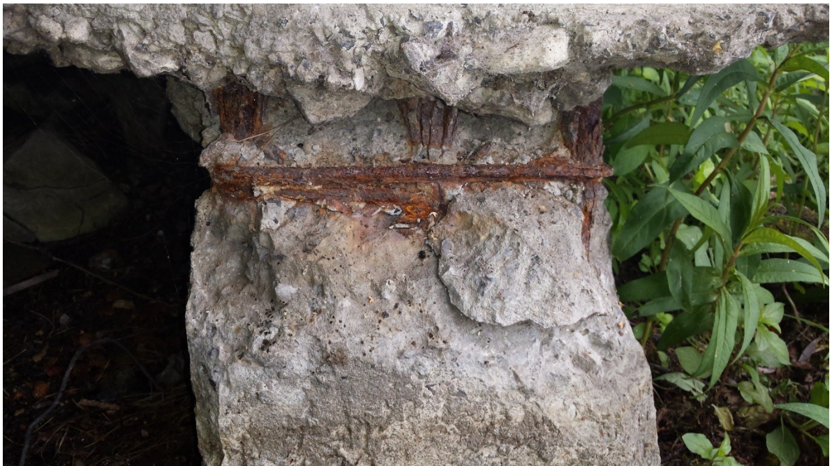
Fot. 10: Jw. Korozja połączenia podpory żelbetowej z palem fundamentowym
