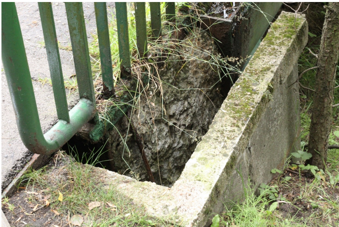
Fot. 8: Zachodnia strona kładki. Skorodowane bezgłowie – strona prawa
