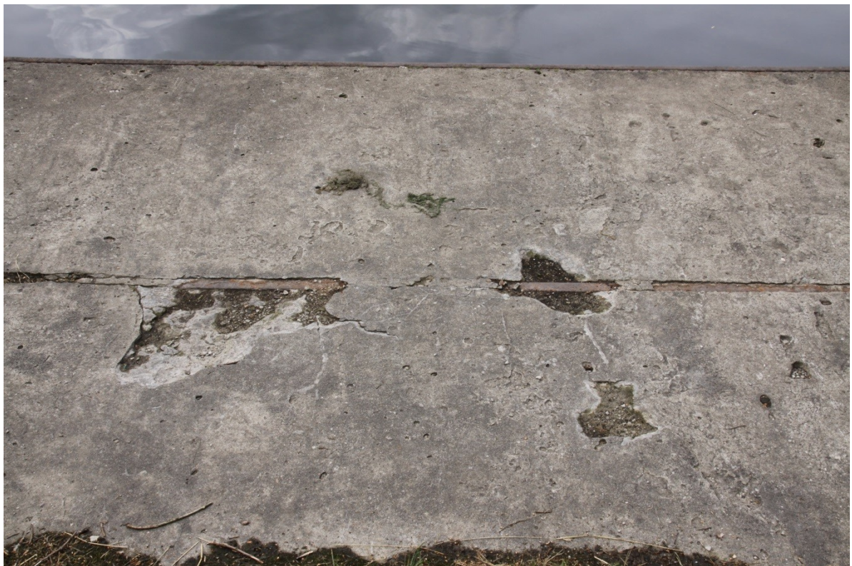
Fot. 17: Ubytek betonu w warstwie wylewki pokładu nabrzeża
