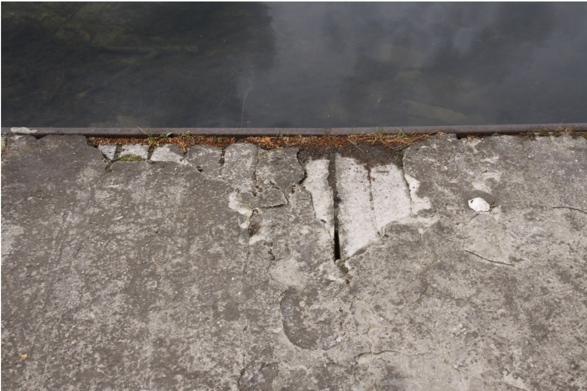
Fot. 16: Ubytek betonu w warstwie wylewki pokładu nabrzeża
