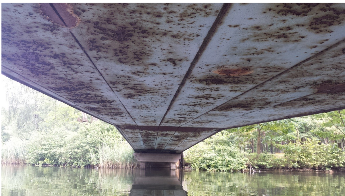
Fot. 3: Wyraźne ślady korozji powierzchniowej blachy spodniej konstrukcji kładki
