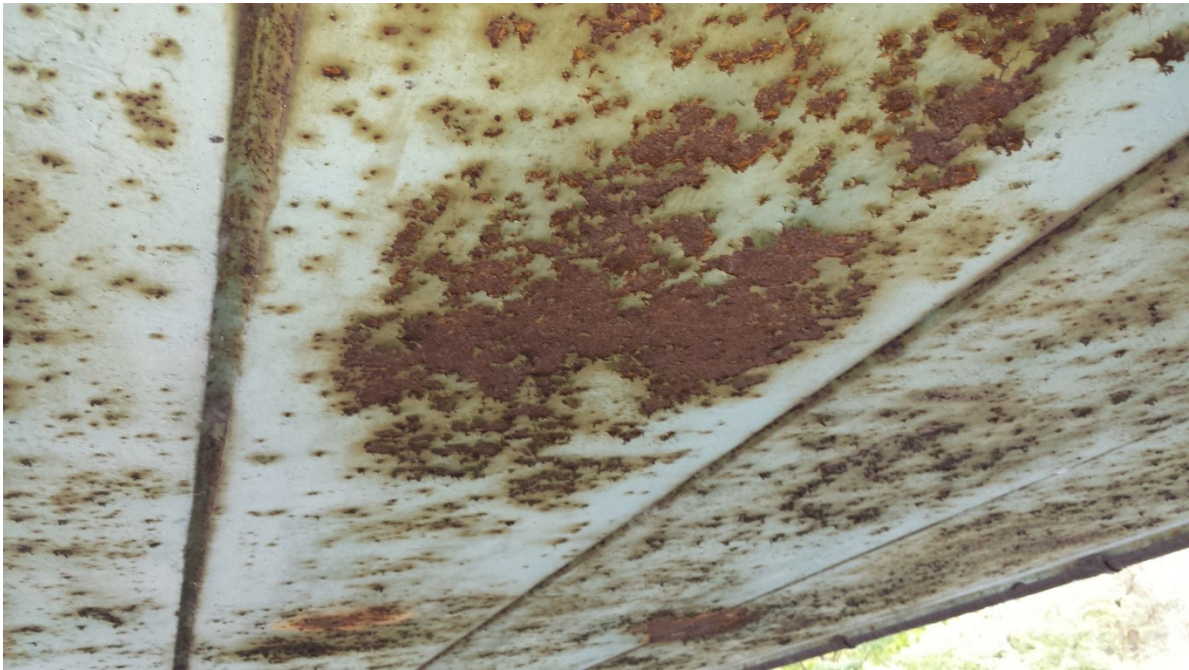
Fot. 4: Korozja powierzchniowa blachy spodniej konstrukcji kładki (zbliżenie)
