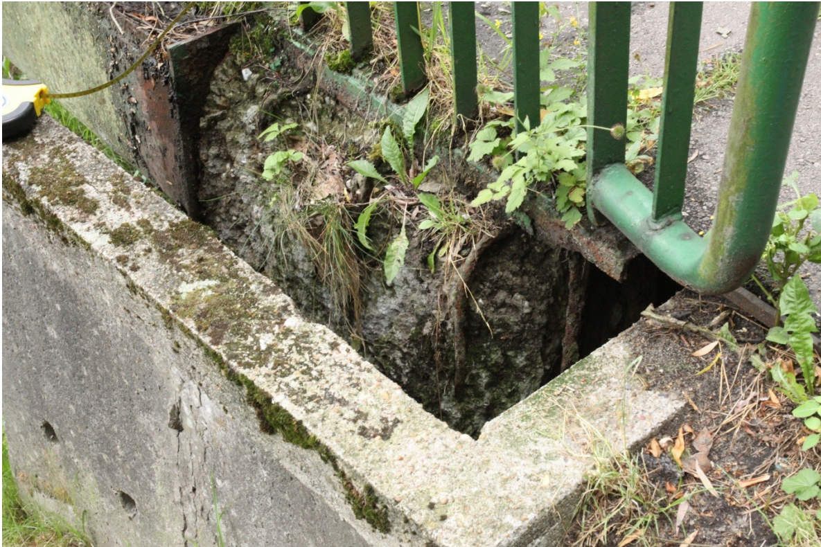
Fot. 7: Zachodnia strona kładki. Skorodowane bezgłowie – strona lewa
