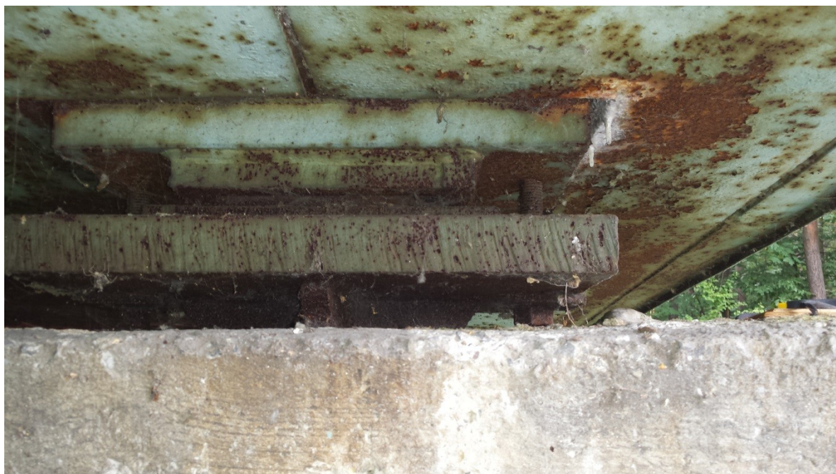
Fot. 6: Korozja konstrukcji stalowej kładki oraz podbudowy stalowej na podporze żelbetowej
