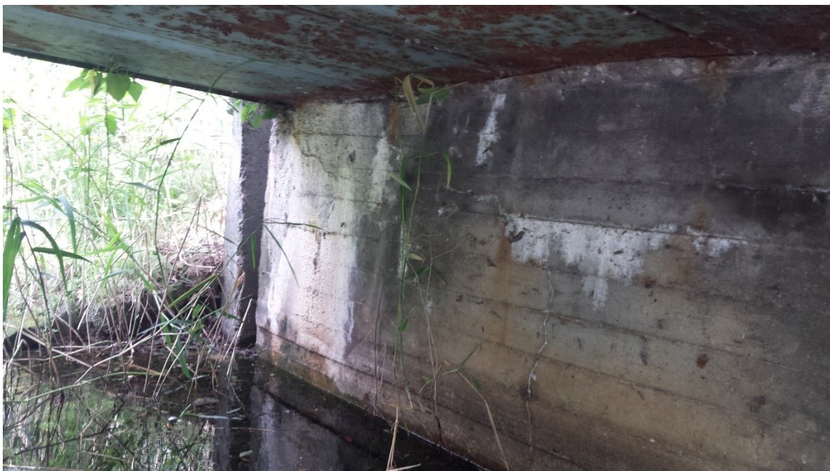
Fot. 5: Groźna korozja konstrukcji stalowej kładki w węzłowi
