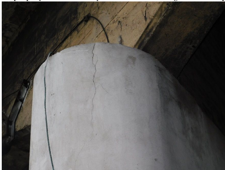
Fot. 15 Widok na górną część podpory w osi C od strony prawej. Widoczne zarysowanie na powierzchni.
