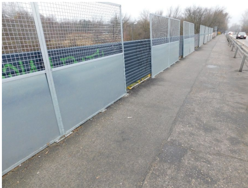
Fot. 30 Widok na blachy i osłony przeciwporażeńowe zamontowane po lewej stronie wiaduktu.
