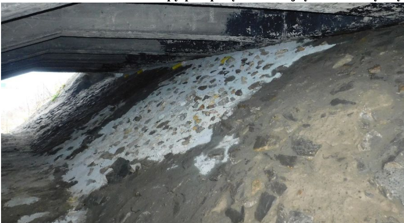
Fot. 35 Widok na umocnienie skarpy pod przeslem skrajnym od strony Sosnowca.
