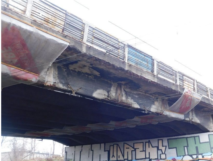
Fot. 6 Widok ogólny na przęsło przedskrajne od strony Sosnowca od strony prawej. Widoczne znaczne uszkodzenia dźwigara skrajnego i wspornika podchodnikowego.
