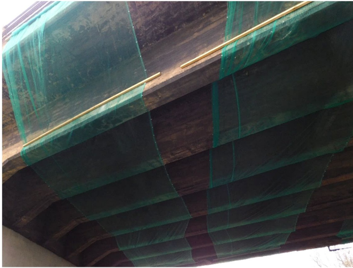
Fot. 7 Widok ogólny od strony prawej na przęsło przedskrajne od strony Mysłowic. Widoczne przebarwienia na powierzchniach betonowych.
