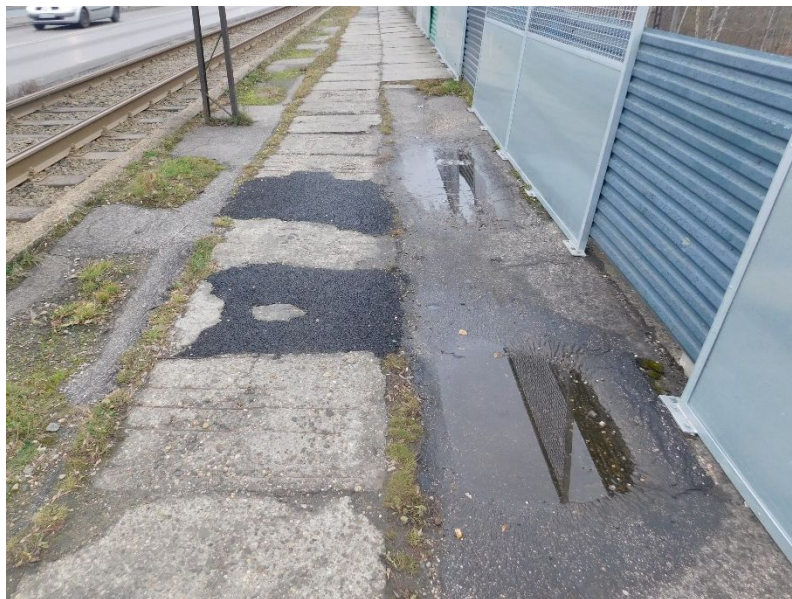
Fot. 27 Widok na chodnik prawy. Widoczne ubytki betonu płyt chodnikowych i odsłonięte zbrojenie oraz spękania, nierówności i zastoiska wody na nawierzchni bitumicznej.
