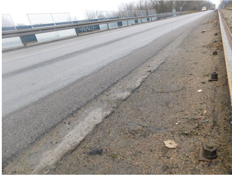
Fot. 23 Widok na krawędź jezdni przy torowisku tramwajowym. Widoczne nagromadzenie zanieczyszczeń.
