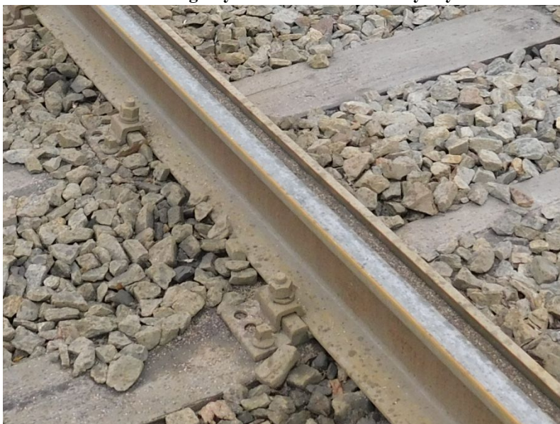
Fot. 26 Widok na zamocowanie szyny tramwajowej do podkładu drewnianego. Widoczny brak wkrętów.
