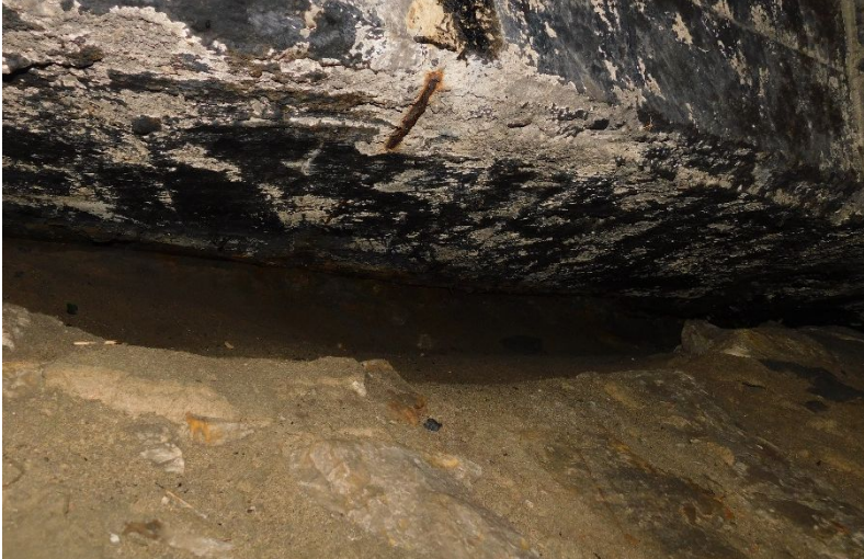
Fot. 33 Widok na skarpe pod poprzecznica skrajna przeszła skrajnego od strony Myslowic. Widoczne ubytki gruntu pod poprzecznica.
