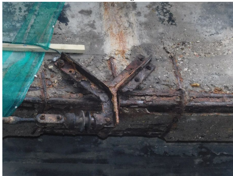
Fot. 37 Widok na element zamocowania trakcji kolejowej – widoczna zaawansowana korozja kształownika i ubytek stali.
