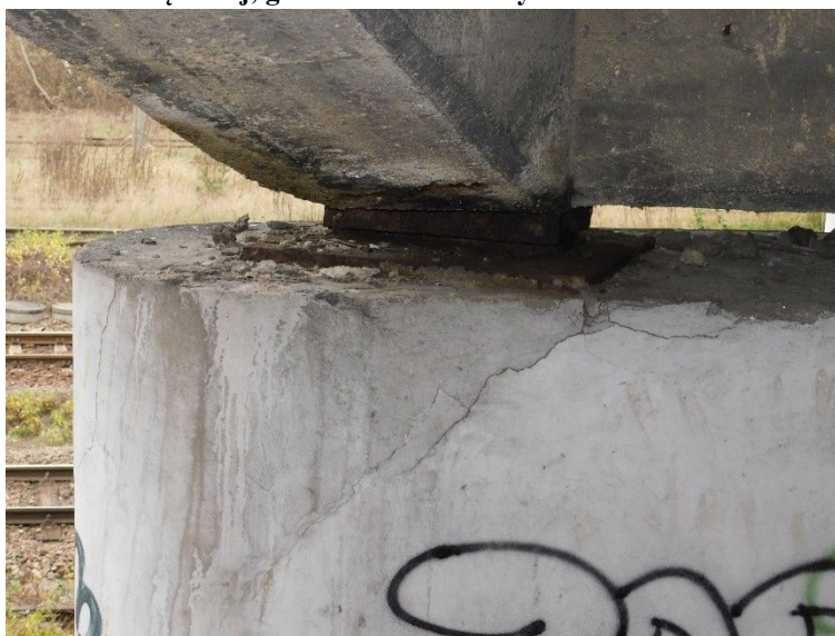
Fot. 13 Widok na fragment podpory w osi A pod łożyskiem dźwigara skrajnego lewego. Widoczne zarysowania na powierzchni podpory oraz zanieczyszczenie ławy podłożyskowej.
