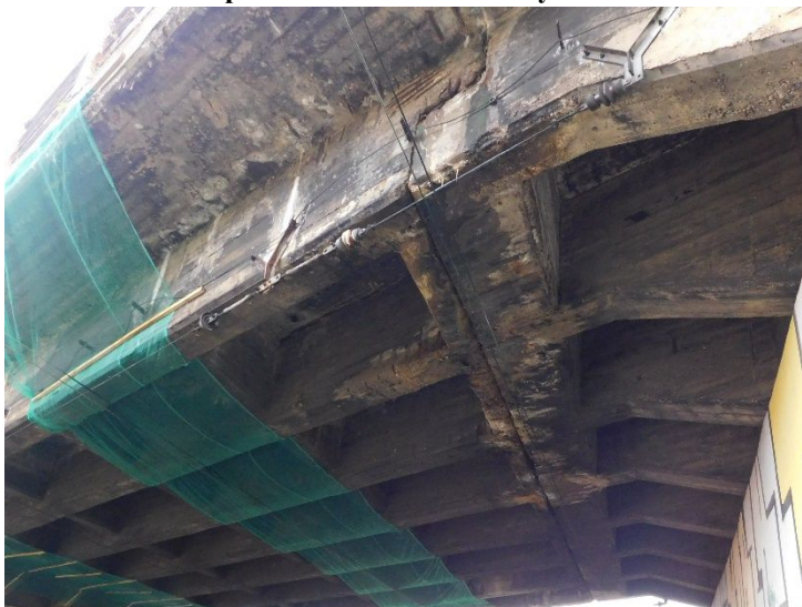
Fot. 8 Widok na przęsło środkowe od strony prawej. Widoczne przebarwienia betonu na spodniej powierzchni poprzecznicy przęsła wspornikowego oraz na bocznej powierzchni dźwigara skrajnego głównego i wspornika podchodnikowego świadczące o korozji betonu.
