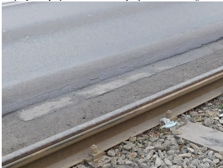
Fot. 24 Widok na krawędź jezdni przy torowisku tramwajowym. Widoczne podłużne zarysowania nawierzchni.
