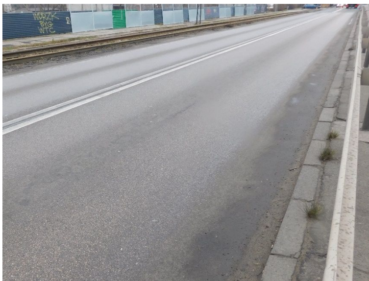
Fot. 22 Widok ogólny na jezdnię na obiekcie od strony Mysłowic. Widoczne koleiny na całej długości obiektu oraz nagromadzenie zanieczyszczeń przy krawężniku chodnika lewego.
