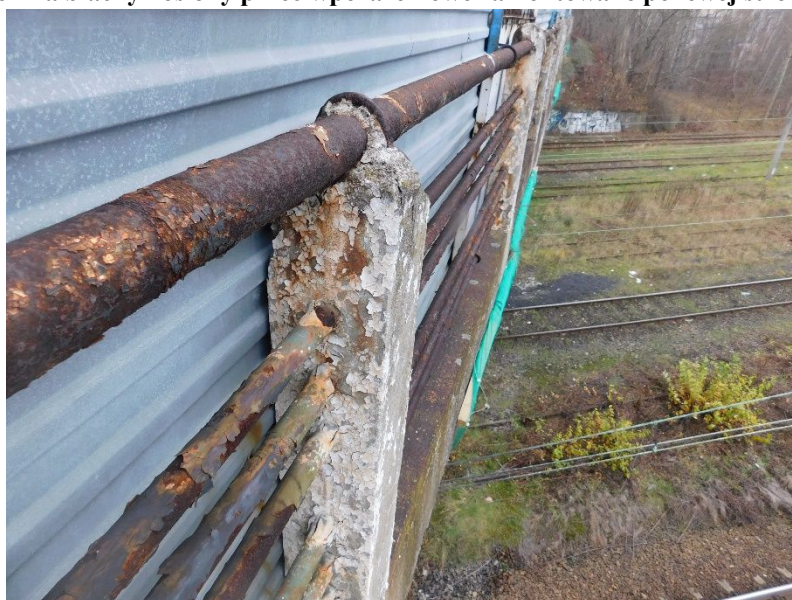
Fot. 31 Widok na balustradę po prawej stronie obiektu nad przesłem skrajnym od strony Sosnowca. Widoczna zaawansowana korozja oraz znaczne ubytki betonu, a także zaawansowana korozja elementów stalowych balustrady.
