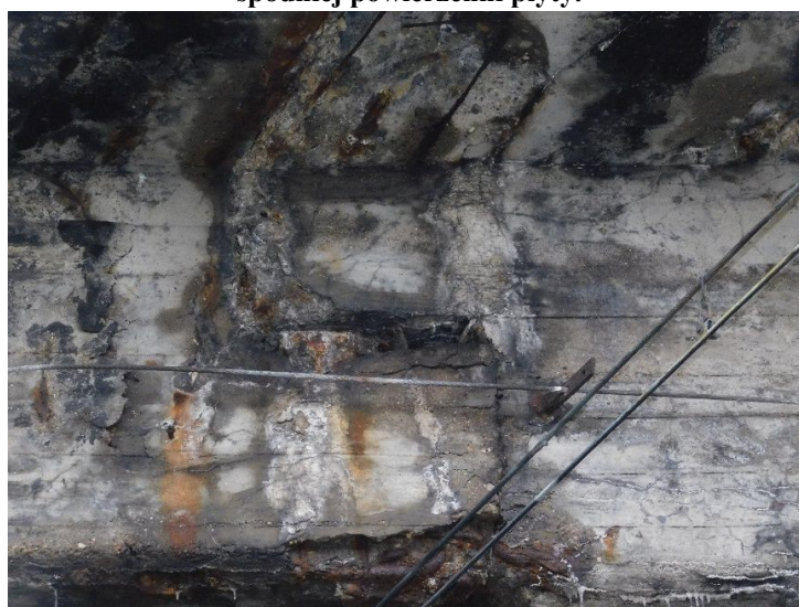
Fot. 11 Widok na przegub gerberowski w belce skrajnej lewej w prześle środkowym. Widoczne krawędziowe ubytki betonu, zaawansowana korozja betonu i stalowych elementów przegubu.
