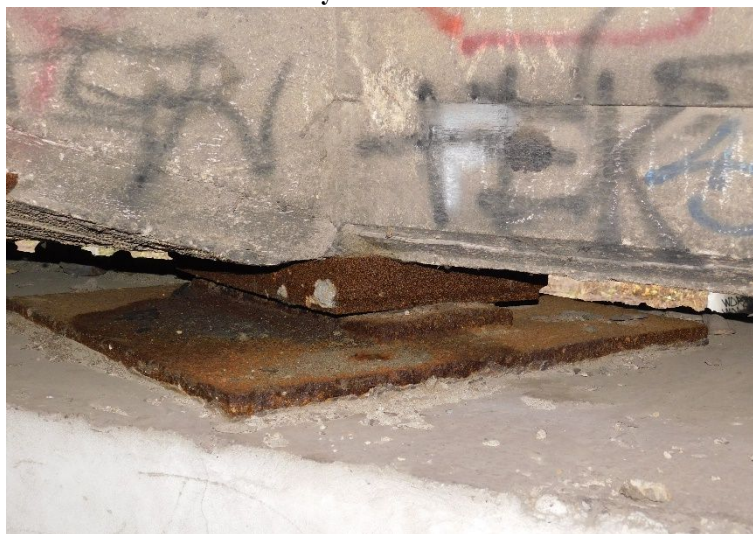
Fot. 21 Widok na łożysko pod belką wewnętrzną na podporze w osi D. Widoczna korozja powierzchniowa na całym elemencie.
