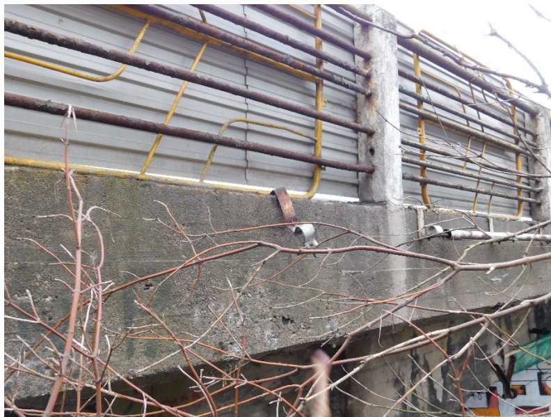
Fot. 40 Widok na osłonę urządzenia obcego przy gzymsie lewym. Widoczny miejscowy brak rury osłonowej.
