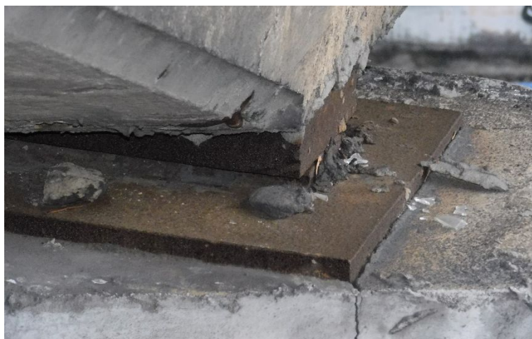
Fot. 20 Widok na łożysko pod belką skrajną prawą na podporze w osi A. Widoczna korozja powierzchniowa na całym elemencie.
