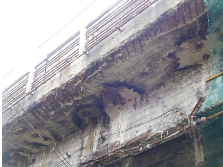
Fot. 9 Widok na wspornik prawy w prześle środkowym. Widoczne rozległe ubytki betonu i odsłonięte zbrojenie, a także przebarwienia, wylugowania i wysolenia na powierzchni betonu świadczące o zaawansowanej korozji.
