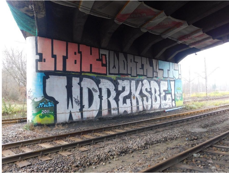
Fot. 14 Widok ogólny na podporę w osi B od strony Sosnowca. Widoczne graffiti na całej powierzchni podpory.
