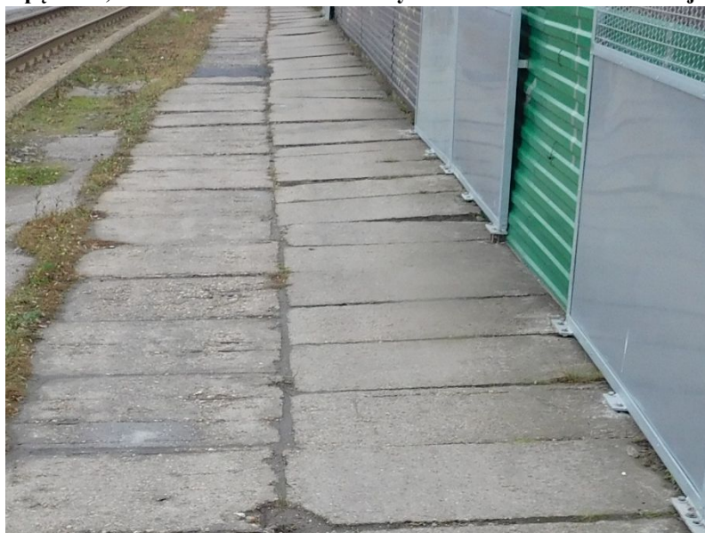
Fot. 28 Widok na chodnik prawy. Widoczne przemieszczenia płyt chodnikowych względem siebie.
