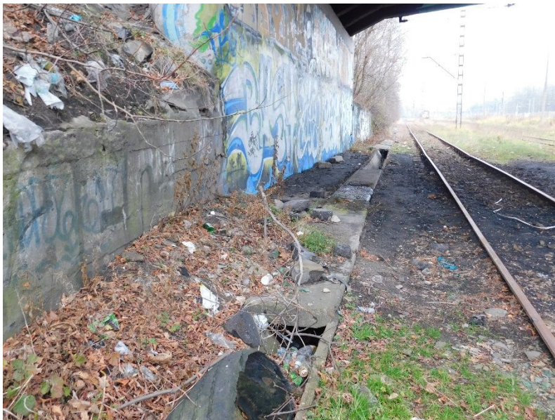
Fot. 38 Widok na przestrzeń podmostową przy podporze w osi D. Widoczne przemieszczenie żelbetowych płyt i miejscowe zaśmiecenie
