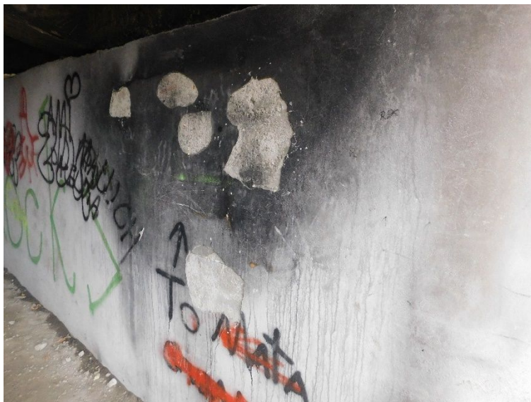
Fot. 12 Widok powierzchni podpórę w osi A od strony Sosnowca. Na korpusie filara widoczne ubytki warstwy zewnętrznej, graffiti oraz zanieczyszczenie osadami.
