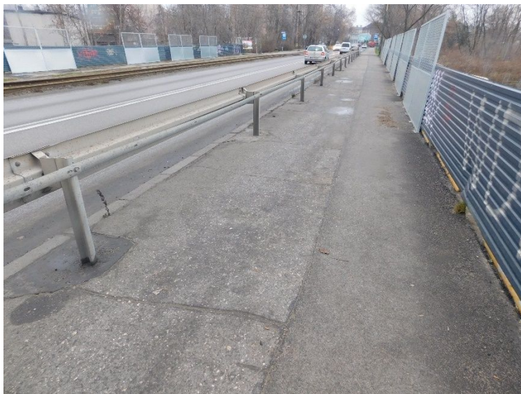
Fot. 29 Widok na chodnik lewy. Widoczne nierówności, spękania, ubytki nawierzchni bitumicznej chodnika oraz miejscową vegetację roślin przy krawężniku i gzymsie.
