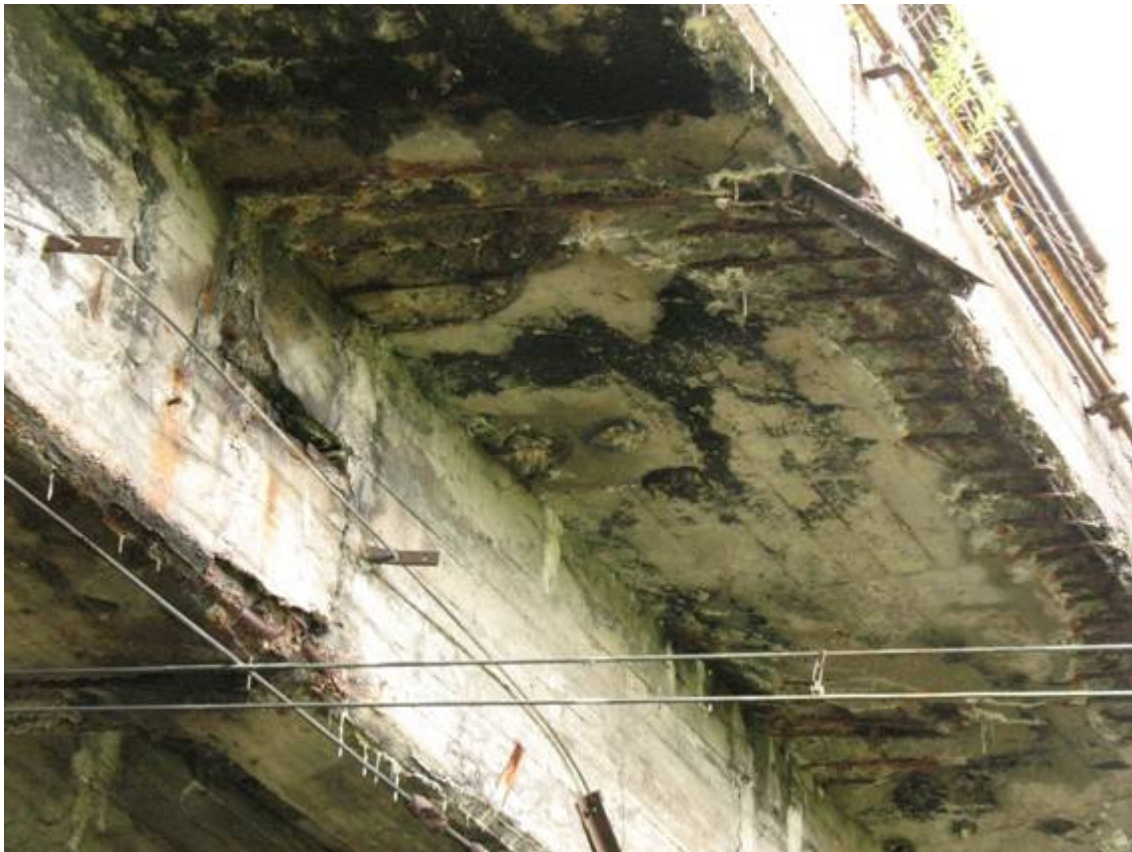
Fot. 9. Widok wspornika i belki w sąsiedztwie przegubu. Korozja betonu i stali. Wykwity, stalaktyty i wegetacja porostów na powierzchni betonu
