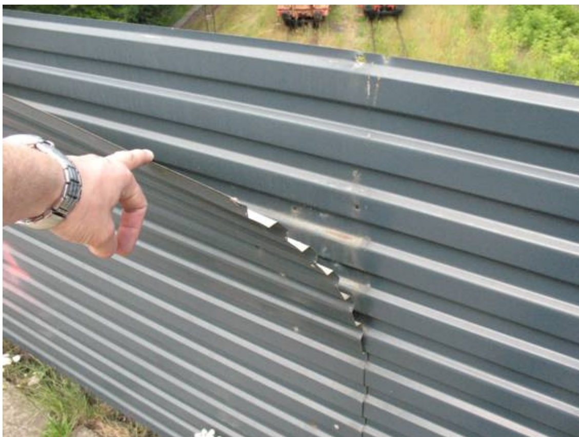
Fot. 29. Blacha trapezowa, uszkodzenie mocowań. Górna krawędź (pochwyt) zbyt ostra.
