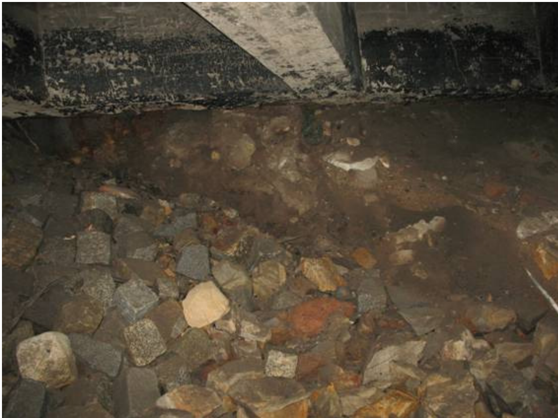
Fot. 21. Ubytek nasypu pod płytą przejściową. Osunięcie się materiału kamiennego. Występuje stałe sączenie się wody. Po opadach występuje rwący potok.
