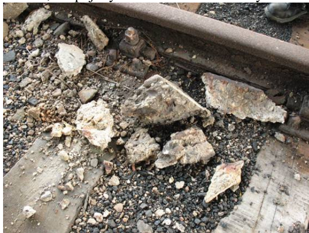
Próbki, odspojonych elementów betonowych
