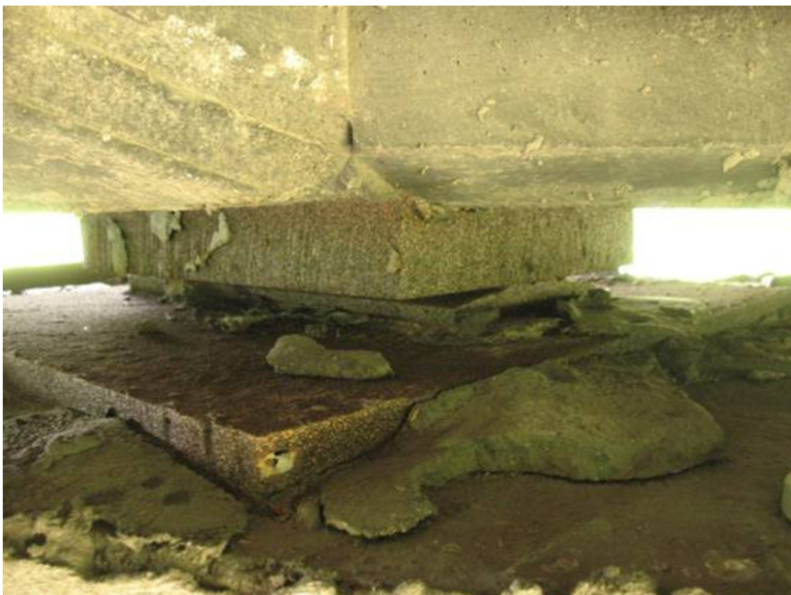
Fot. 20. Łóżysko stalowe. Korozja powierzchniowa.
