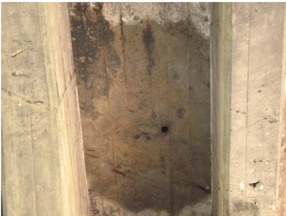
Fot. 25. Widok na płytę pomostu od spodu. Szczegół zawilgocenia płyty w sąsiedztwie sączka. Ubytki betonu z odstąpieniem zbrojenia. Korozja zbrojenia. Wykwity na powierzchni betonu.
