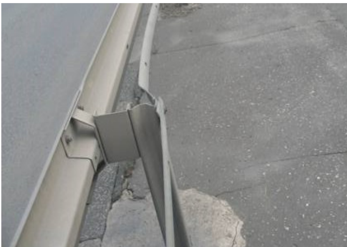
Fot. 34. Widok na barierę energochłonną. Deformacja bariery. Widoczne rysy na nawierzchni chodnika.
