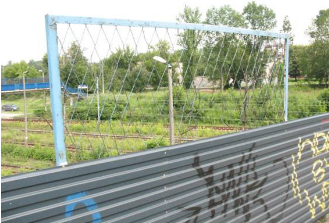
Fot. 31. Bariera przeciwporażeniowa - widoczne ubytki wykratowania, zbyt mała szerokość bariery (nie spełnia obowiązujących przepisów).
