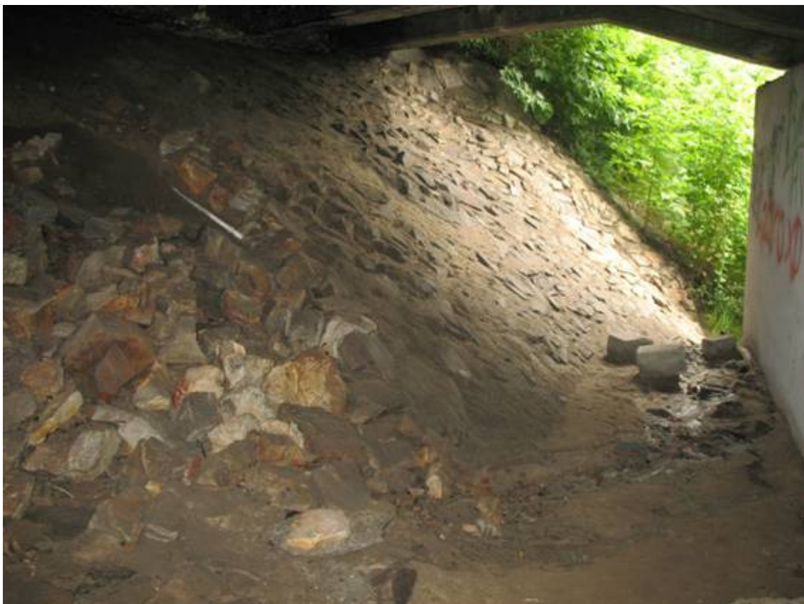
Fot. 22. Widok pod wspornikiem od strony północnej. Ubytek nasypu pod płytą przejściową. Osunięcie się materiału kamiennego. Występuje stałe sączenie się wody.
