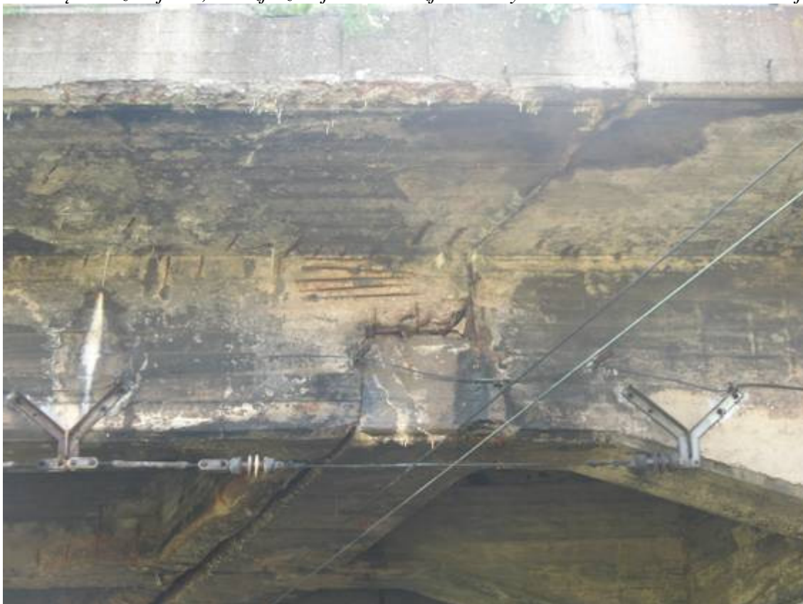
Fot. 22. Przęsło nr 3 szczegół uszkodzenia żebra od strony zachodniej w sąsiedztwie przegubu. Widoczne wykwitki, osady i zacieki na powierzchni betonu. Ubytki betonu z odstonięciem zbrojenia, korozja zbrojenia. Korozja stalowych elementów mocowania trakcji.
