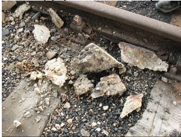
Próbki, odspojonych elementów betonowych
