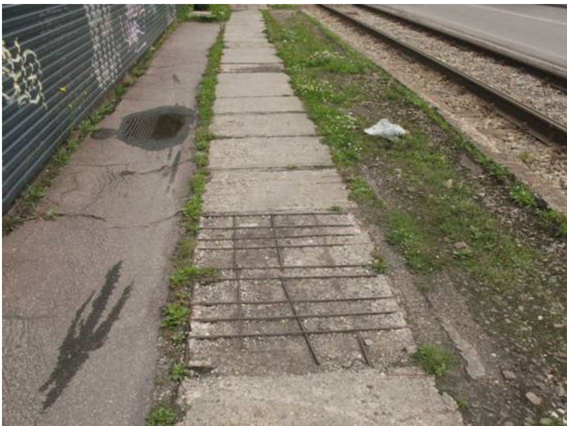
Fot. 26. Widok na płytę chodnika po stronie zachodniej. Ubytki betonu z odsłonięciem zbrojenia.
