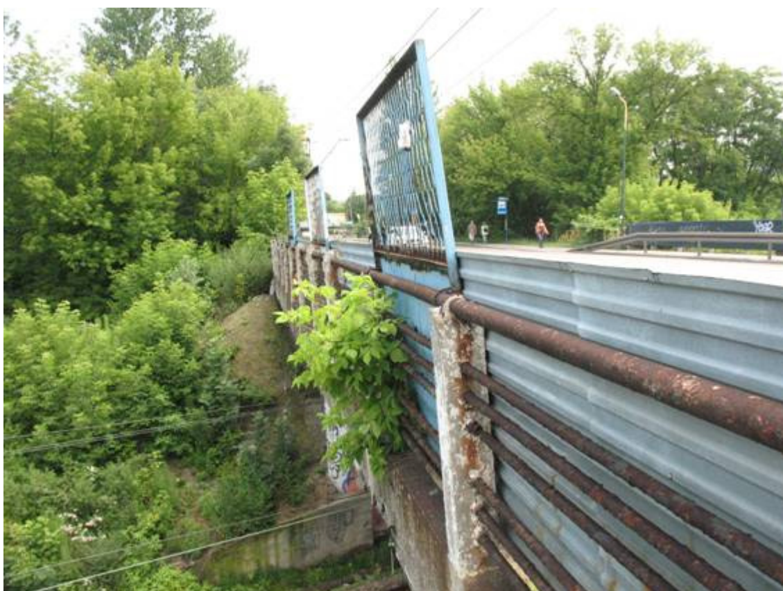
Fot. 30. Widok bariery stalowo-betonowej. Korozja stali, ubytki betonu, deformacje. Zabrudzenia na powierzchni betonu. Wegetacja roślin.
