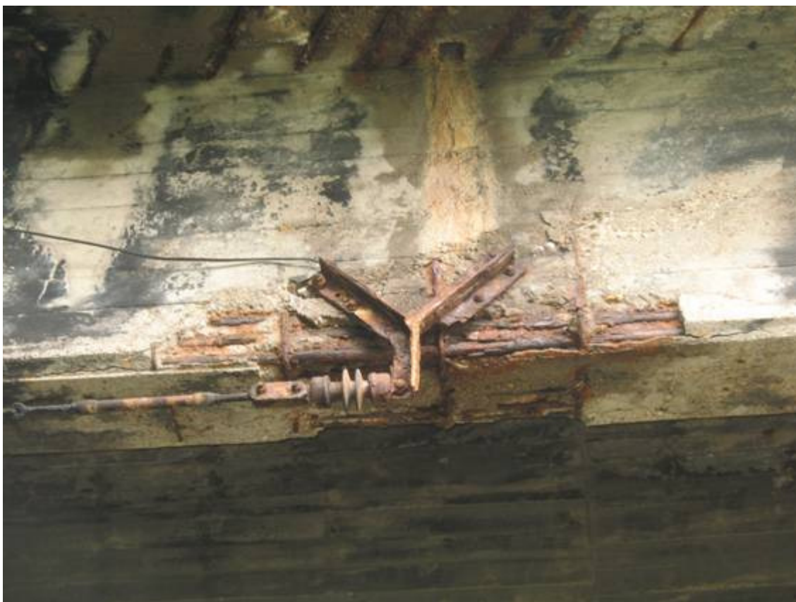
Fot. 16. Szczegół, korozja elementów sieci kolejowej. Widoczny sączek spuszcający wodę na powierzchnię dźwigara skrajnego.
