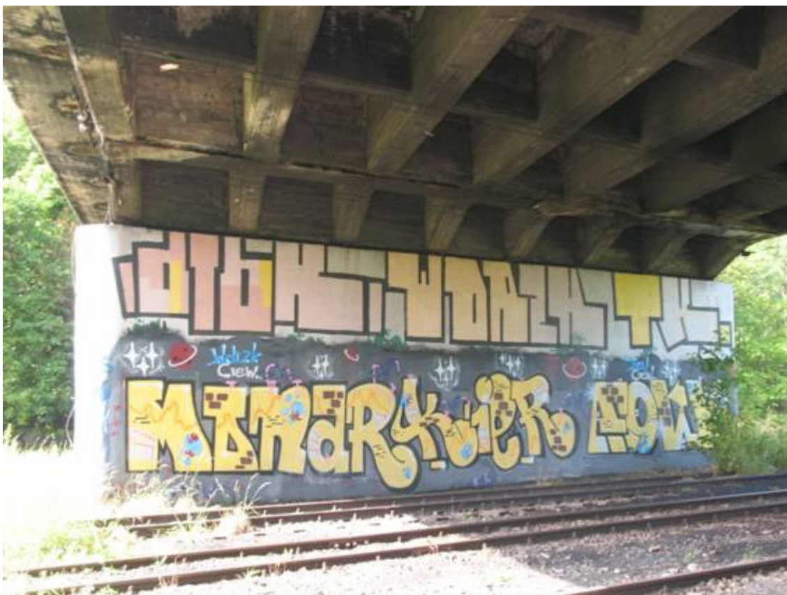
Fot. 13. Widok na podporę nr 3. Zabrudzenia na powierzchni betonu (graffiti).
