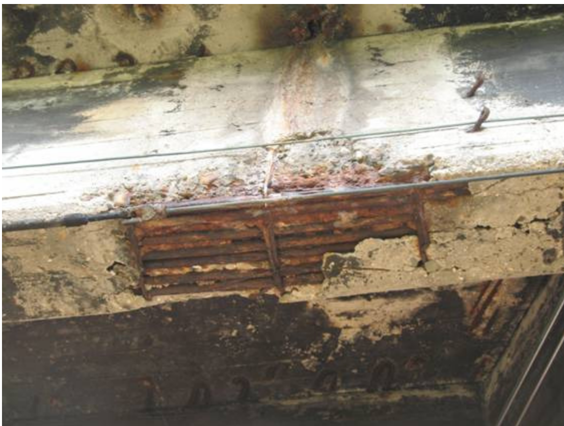
Fot. 19. Przęsło nr 2 szczegół uszkodzenia żebra od strony wschodniej. Widoczne wykwity i osady na powierzchni betonu. Ubytki betonu z odstonięciem zbrojenia, korozja zbrojenia.
