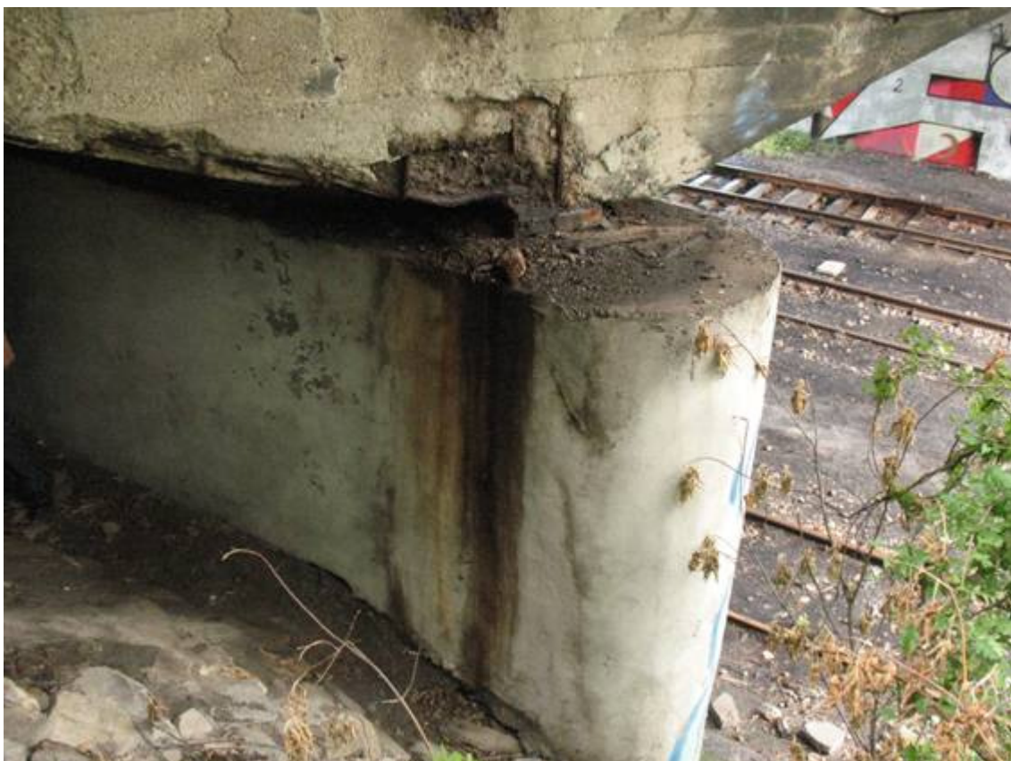
Fot. 18. Widok na żebro i podporę w sąsiedztwie łożyska. Zacieki i wykwyty na powierzchni betonu. Ubytki betonu z odsłonięciem zbrojenia, korozja zbrojenia. Korozja stali łożyska.
