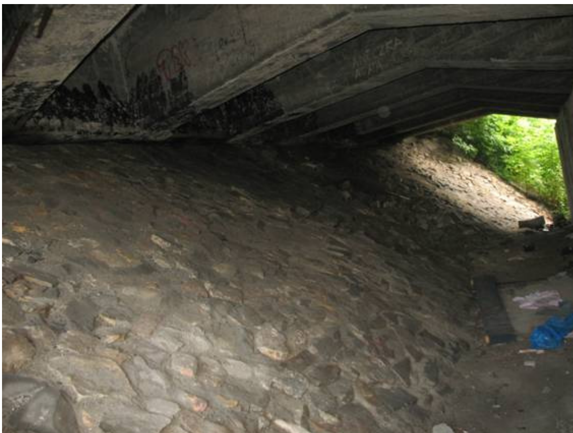
Fot. 9. Widok konstrukcji i przestrzeni pod obiektem w przęśle nr 1. Widoczne wykwyty i osady na powierzchni betonu. Ubytki betonu z odstąpieniem zbrojenia. Wymywanie bruku kamiennego umocnienia skarpy.
