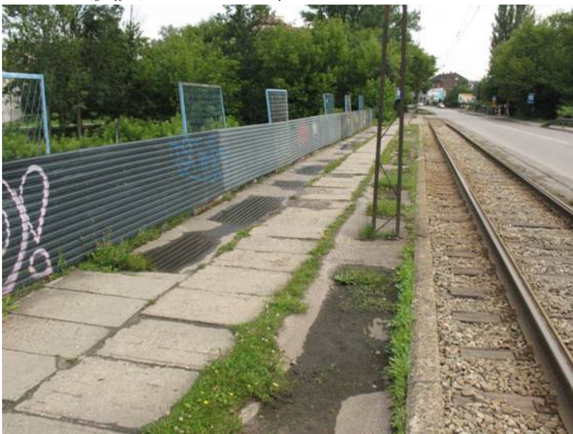
Fot. 8. Widok na chodnik po stronie zachodniej. Widoczne zabrudzenia na blasze trapezowej (graffiti). Odkształcenia, zaleganie wody i wegetacja roślinności na nawierzchni chodnika. Korozja i braki powierzchni malarskich słupa trakcyjnego. Ubytki betonu z odstonięciem zbrojenia. Korozja odstoniętego zbrojenia.
