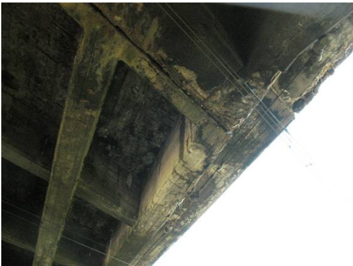
Fot. 12. Widok na przegub i płytę pomostu w przęśle środkowym. Zacieki, wykwyty, korozja prętów zbrojeniowych, korozja powierzchniowa betonu.
