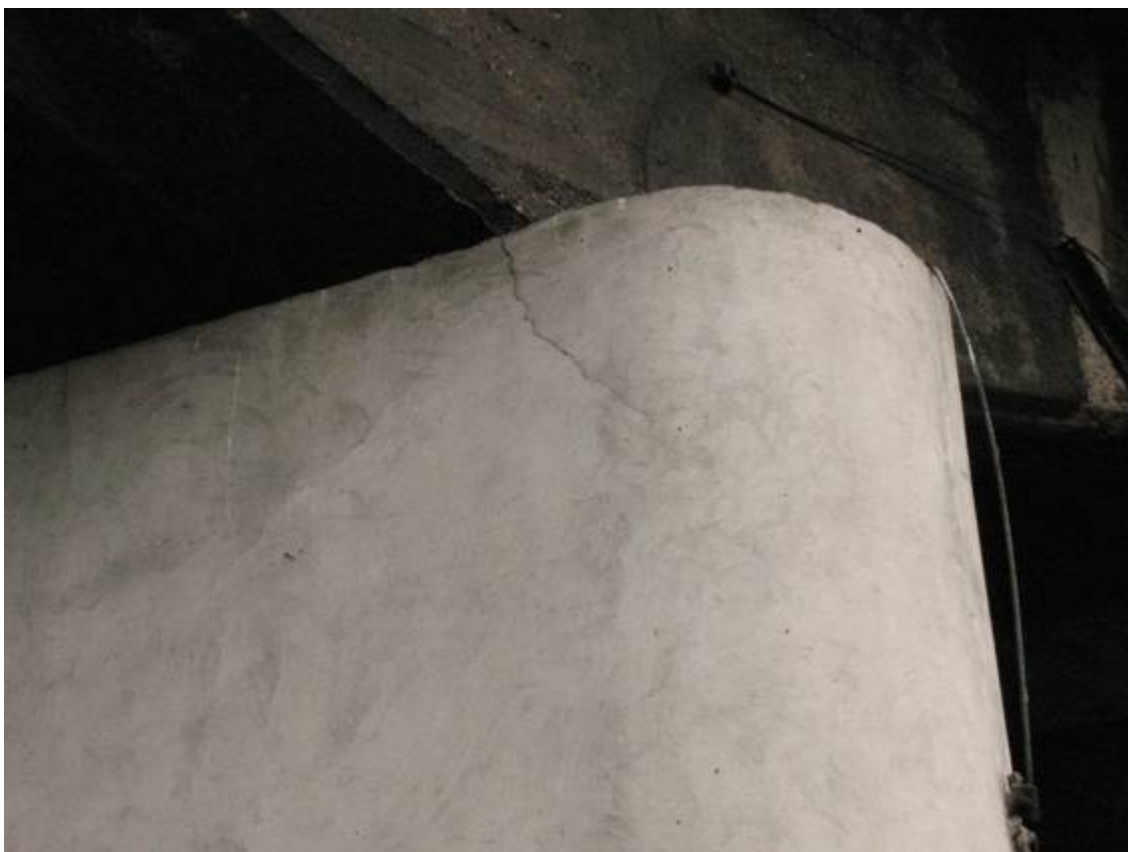
Fot. 18. Podpora nr 3, szczegół od strony północno-wschodniej. Widoczna rysa na powierzchni betonu.
