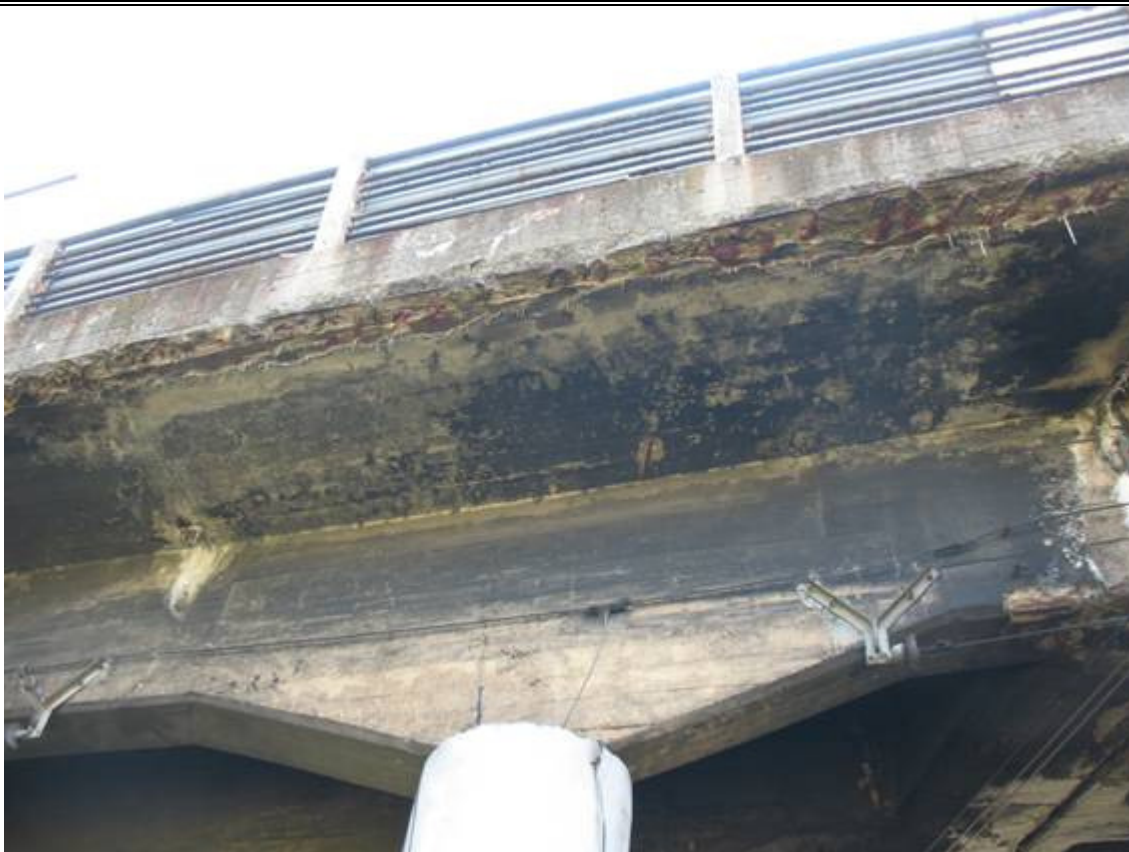
Fot. 5. Wykwity, stalaktyty, korozja zbrojenia i betonu na wsporniku płyty pomostu od strony wschodniej. Widoczny wylot sączka na powierzchni belki.
