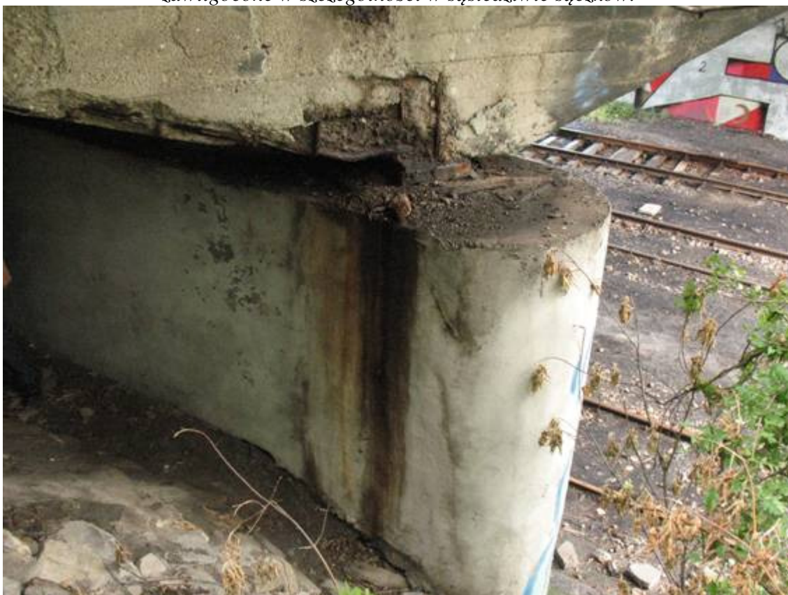
Fot. 28. Widok na żebro i podporę w sąsiedztwie łóżyska. Zacieki i wykwity na powierzchni betonu. Ubytki betonu z odsłonięciem zbrojenia, korozja zbrojenia. Korozja stali łóżyska.
