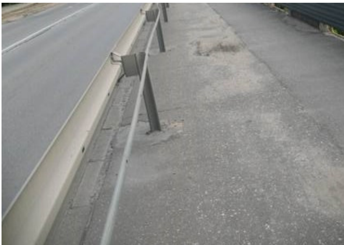
Fot. 24. Widok chodnika po stronie wschodniej. Widoczne deformacje nawierzchni chodnika.
