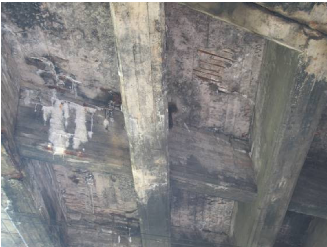
Fot. 13. Widok płytę pomostu i żebro. Ubytki betonu, korozja prętów zbrojeniowych, zacieki, wykwyty.
