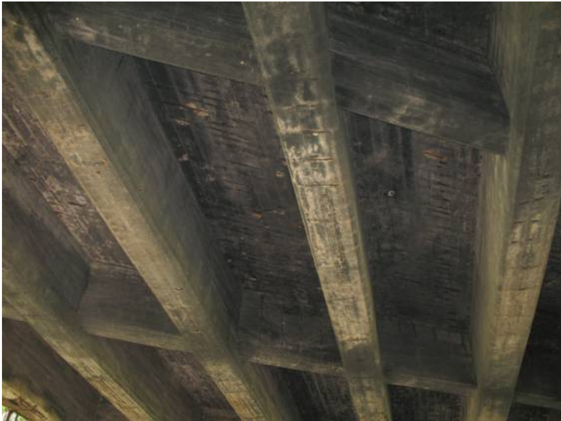
Fot. 7. Płyta pomostu, widok od dołu. Białe wykwity na powierzchni betonu. Ubytki betonu z odsłonięciem zbrojenia. Korozja zbrojenia.
