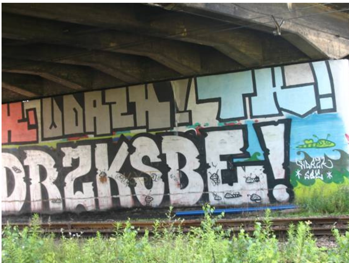
Fot. 6. Podpora pośrednia od strony północnej. Graffiti.
