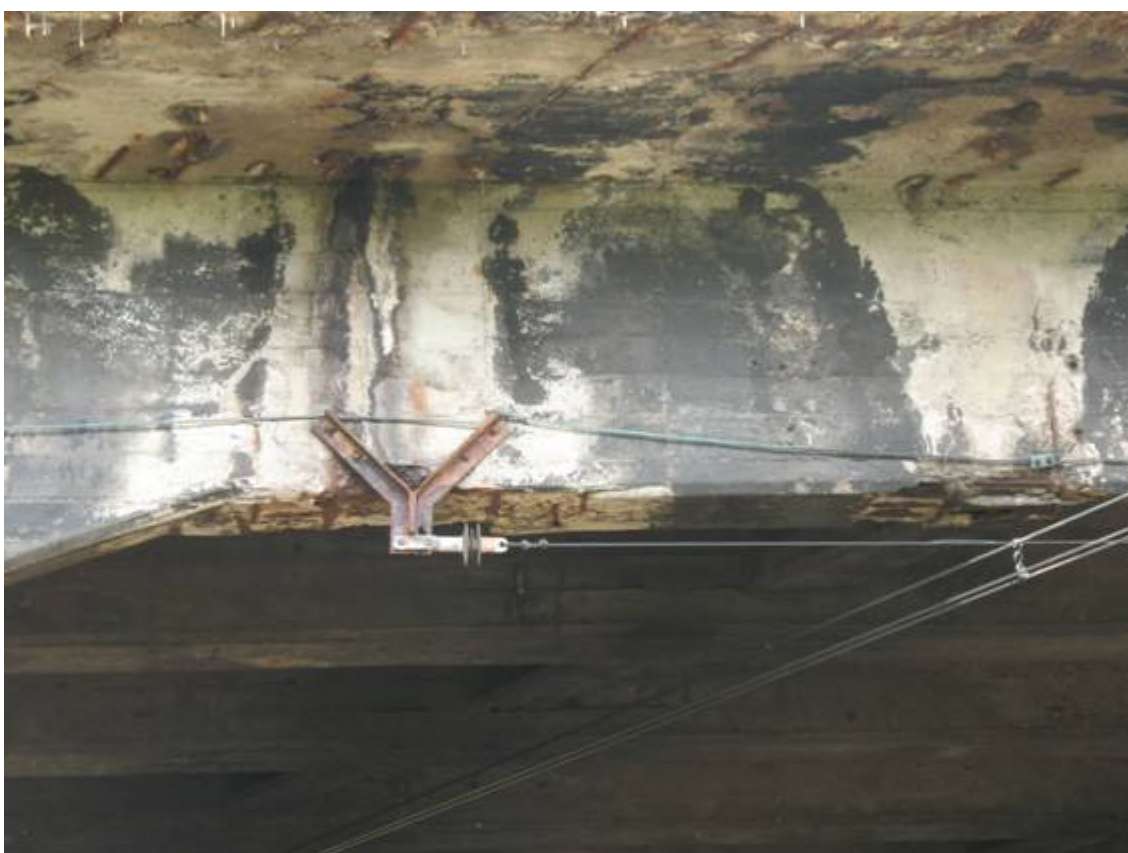
Fot. 20. Przęsło nr 2 szczegół uszkodzenia żebra od strony wschodniej. Widoczne wykwity, osady i zacieki na powierzchni betonu. Ubytki betonu z odstonięciem zbrojenia, korozja zbrojenia. Korozja stalowych elementów mocowania trakcji.
