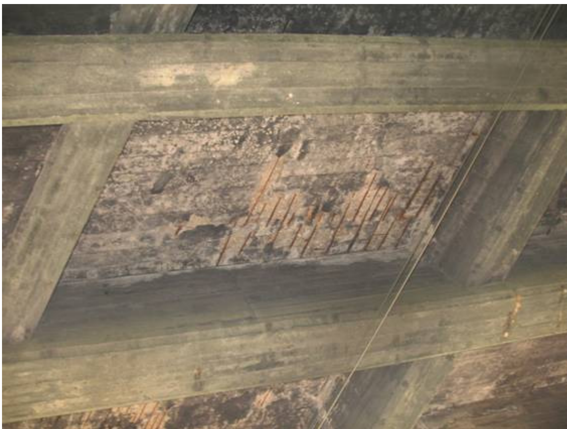
Fot. 25. Widok na płytę pomostu od spodu. Szczegół w przęśle nr 4. Widoczne wykwity osady i zacieki na powierzchni betonu. Ubytki betonu z odstąpieniem zbrojenia, korozja zbrojenia.
