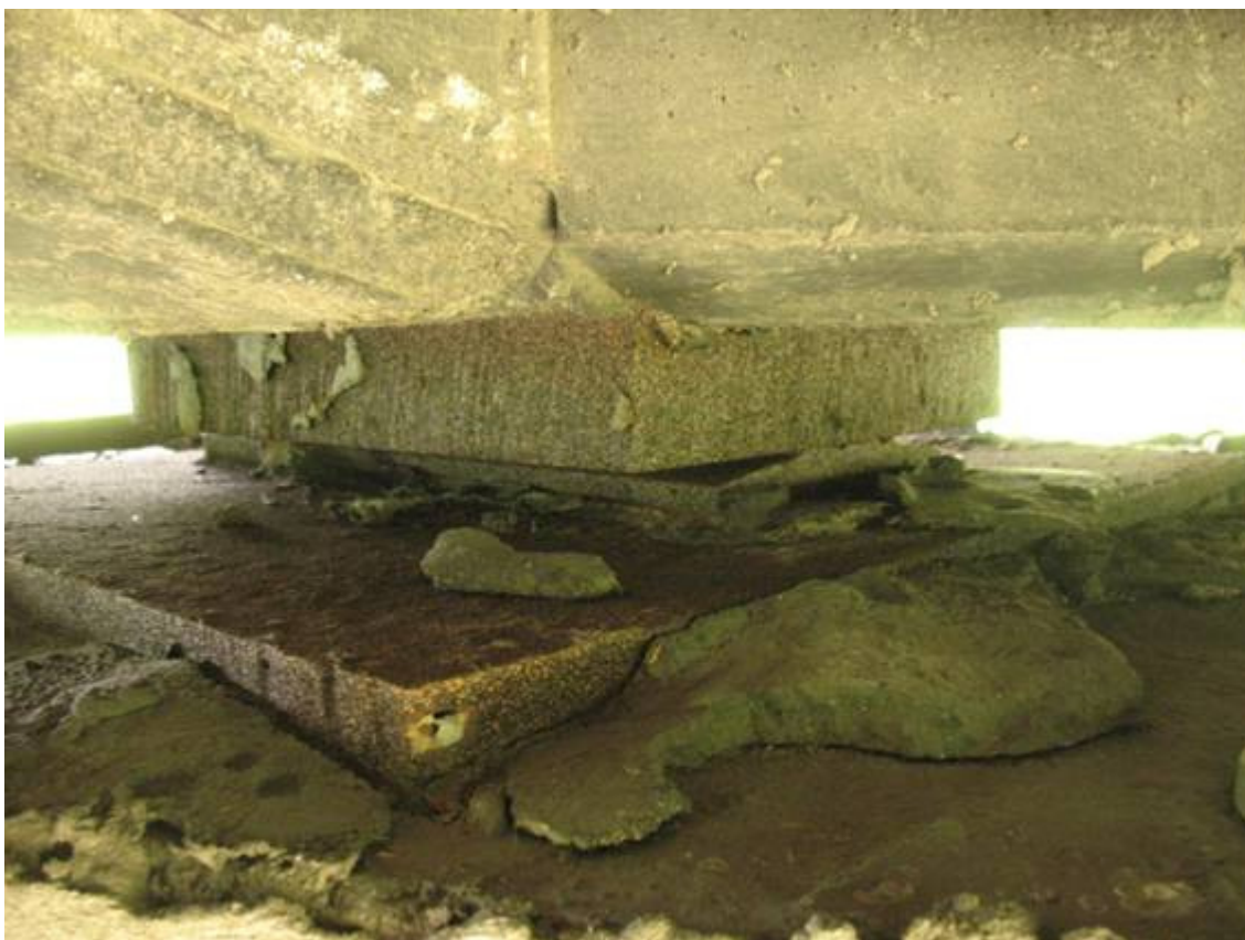
Fot. 29. Łożysko stalowe. Korozja powierzchniowa.
