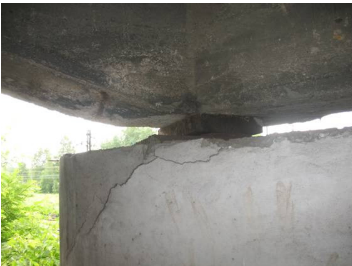
Fot. 16. Podpora nr 1, szczegół od strony północno- wschodniej. Widoczna rysa na powierzchni betonu. Widoczne zabrudzenia betonu, mocowanie trąkcyj do konstrukcji.
