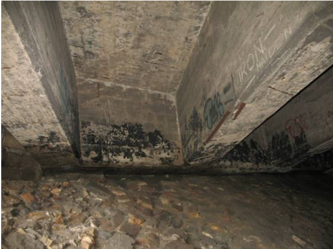
Fot. 19. Na konstrukcje wspornika. Zacieki i wykwyty na powierzchni betonu. Ubytki betonu wraz z odsłonięciem zbrojenia. Zabrudzenia w postaci graffiti.
