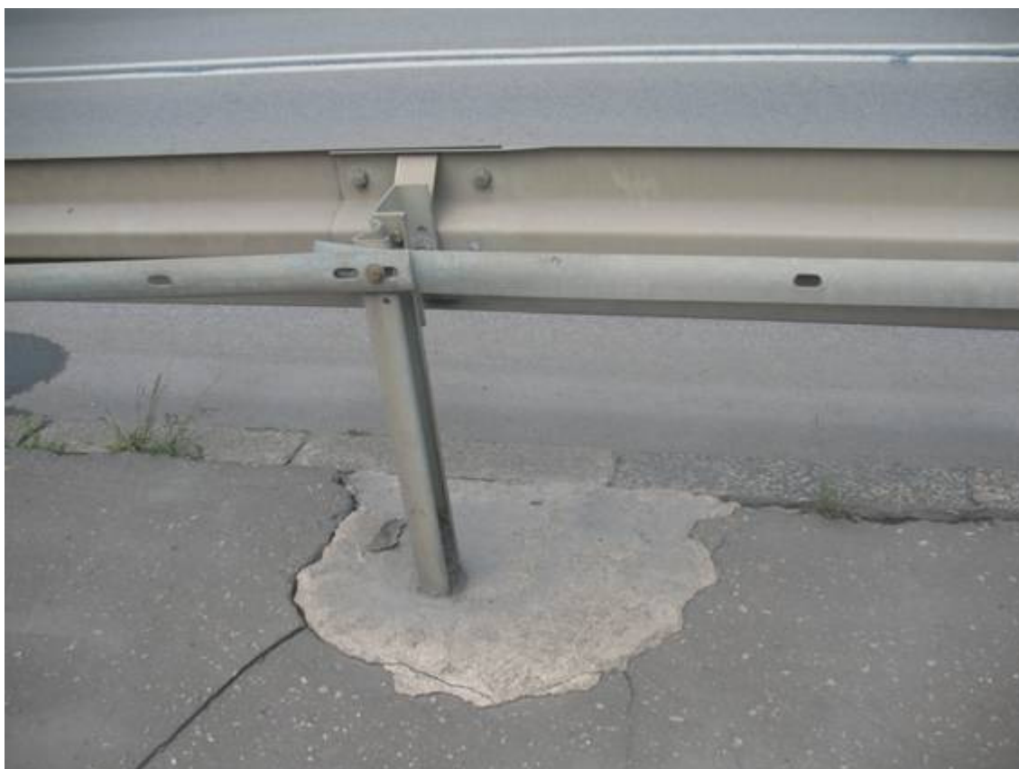
Fot. 27. Widok na mocowanie bariery energochłonnej do powierzchni chodnika po stronie zachodniej. Widoczne pęknięcia nawierzchni.
