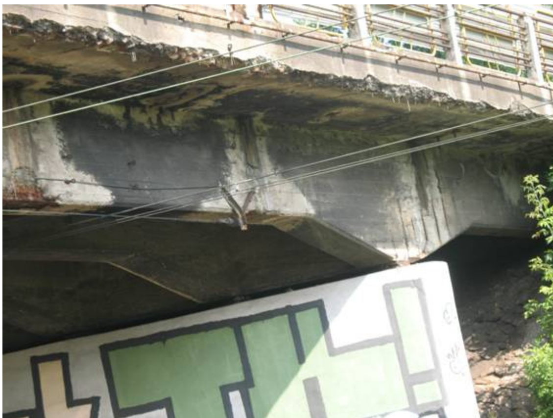
Fot. 14. Widok na wspornik od strony południowej. Widoczne wykwyty i zacieki na powierzchni betonu. Korozja betonu i prętów zbrojeniowych.
