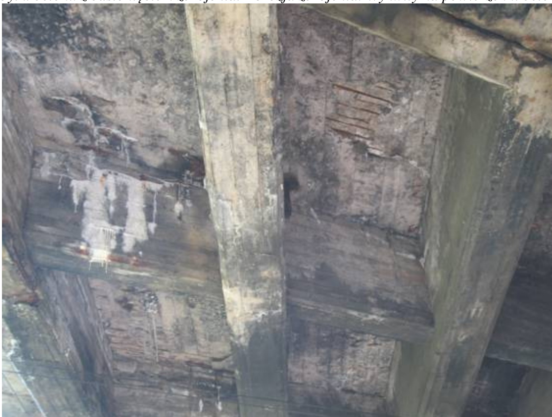
Fot. 25. Widok na płytę pomostu od spodu. Szczegół w przęśle nr 3. Widoczne wykwity osady i zacieki na powierzchni betonu. Ubytki betonu z odstąpieniem zbrojenia, korozja zbrojenia.
