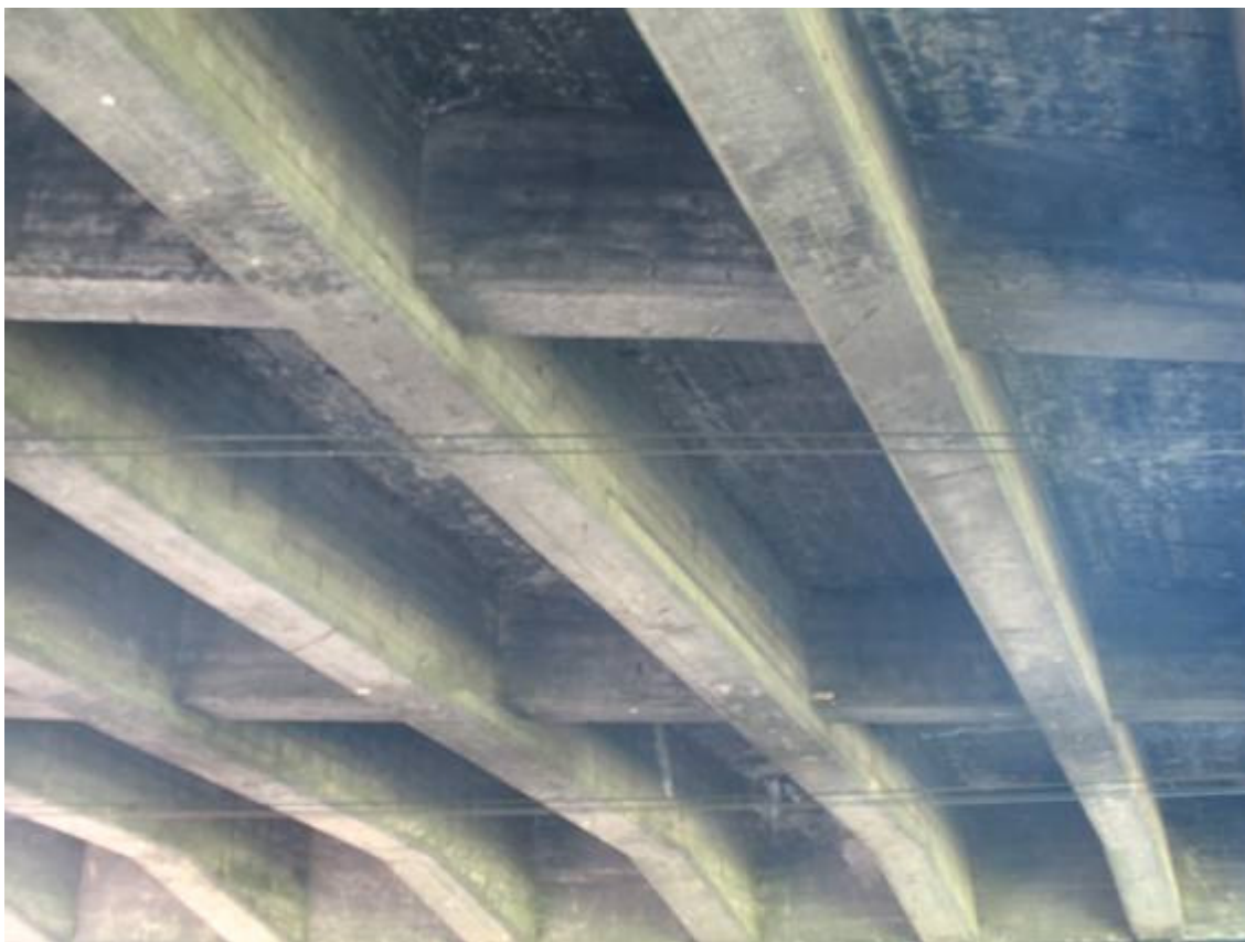
Fot. 10. Widok ustroju nośnego od spodu, przęsto nr 2. Widoczne wykwyty i osady na powierzchni betonu. Ubytki betonu z odstąpieniem zbrojenia. Zbliżenie tralki do konstrukcji.
