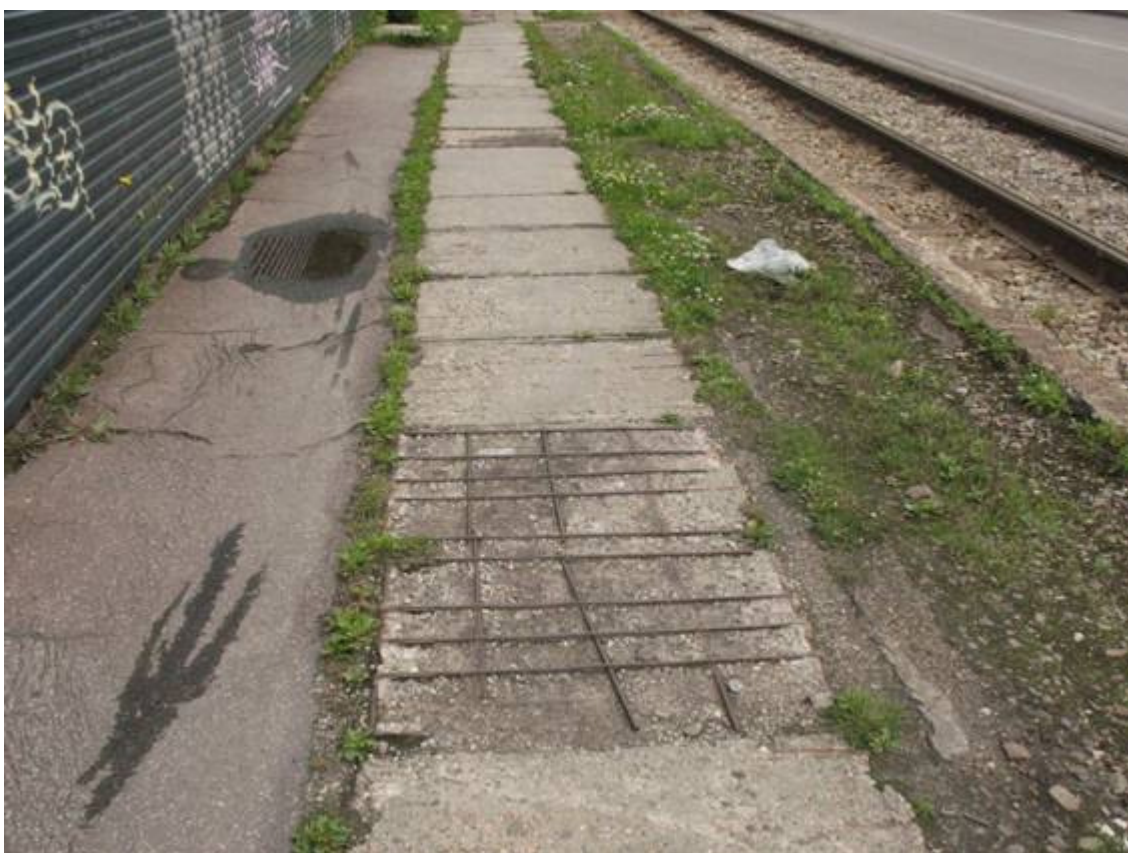
Fot. 32. Widok na płytę chodnika po stronie zachodniej. Ubytki betonu z odstąpieniem zbrojenia. Korozja odstąpiętego zbrojenia. Deformacje powierzchni chodnika.
