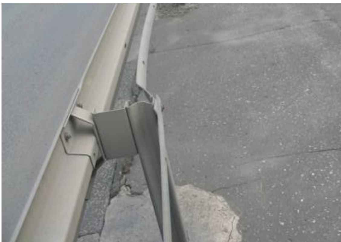
Fot. 28. Widok na barierę energochłonną. Deformacja pasa profilowego bariery.
