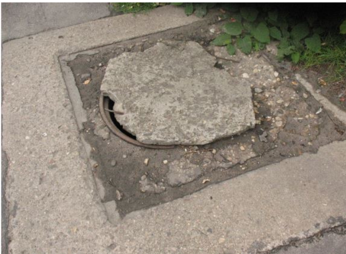
Fot. 32. Widok studzienki na dojeździe od centrum (strona wschodnia). Brak pokrywy studzienki. Niebezpieczeństwo dla użytkowników ciągu pieszego.
