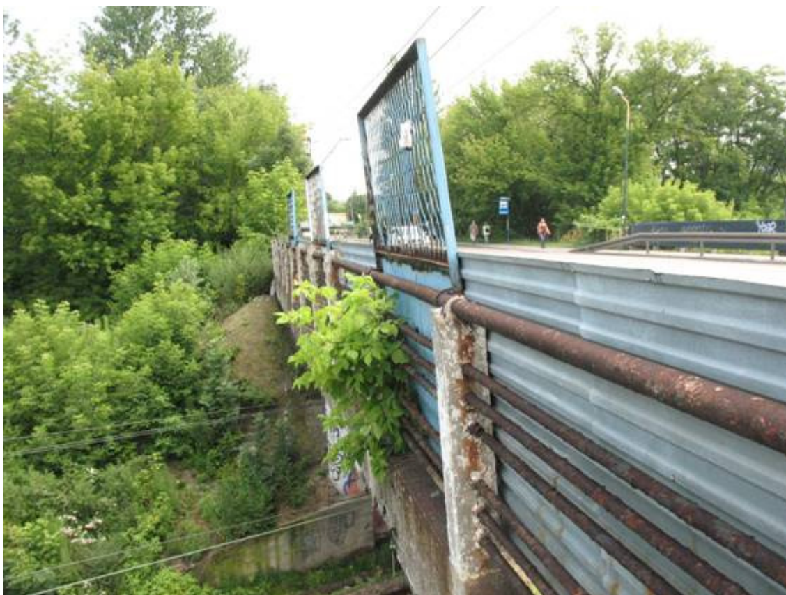
Fot. 36. Widok bariery stalowo-betonowej. Korozja stali, ubytki betonu. Zabrudzenia na powierzchni betonu. Wegetacja roślin. Widoczna bariera przeciwporażeniowa, miejscowe braki powłok malarskich oraz korozja.
