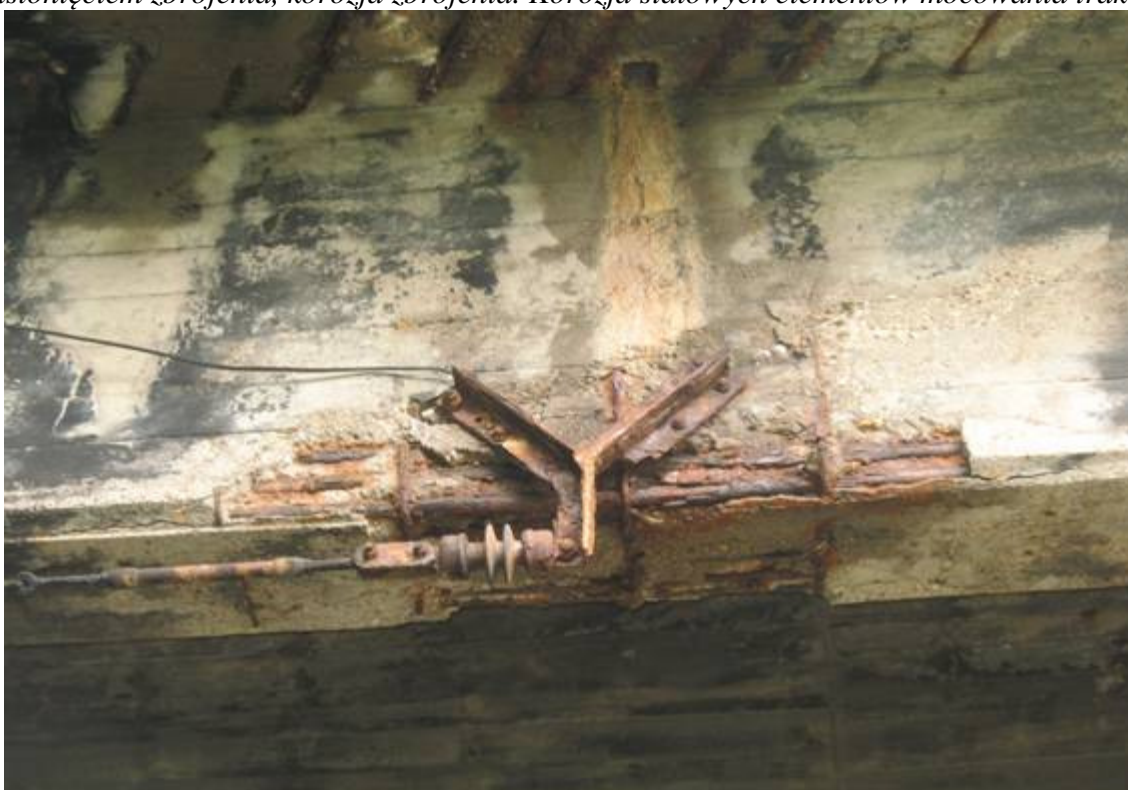
Fot. 24. Przęsło nr 4 szczegół uszkodzenia żebra od strony wschodniej. Widoczne wykwity osady i zacieki na powierzchni betonu. Ubytki betonu z odstonięciem zbrojenia, korozja zbrojenia. Korozja stalowych elementów mocowania trakcji. Wylot sączka bezpośrednio na konstrukcję.
