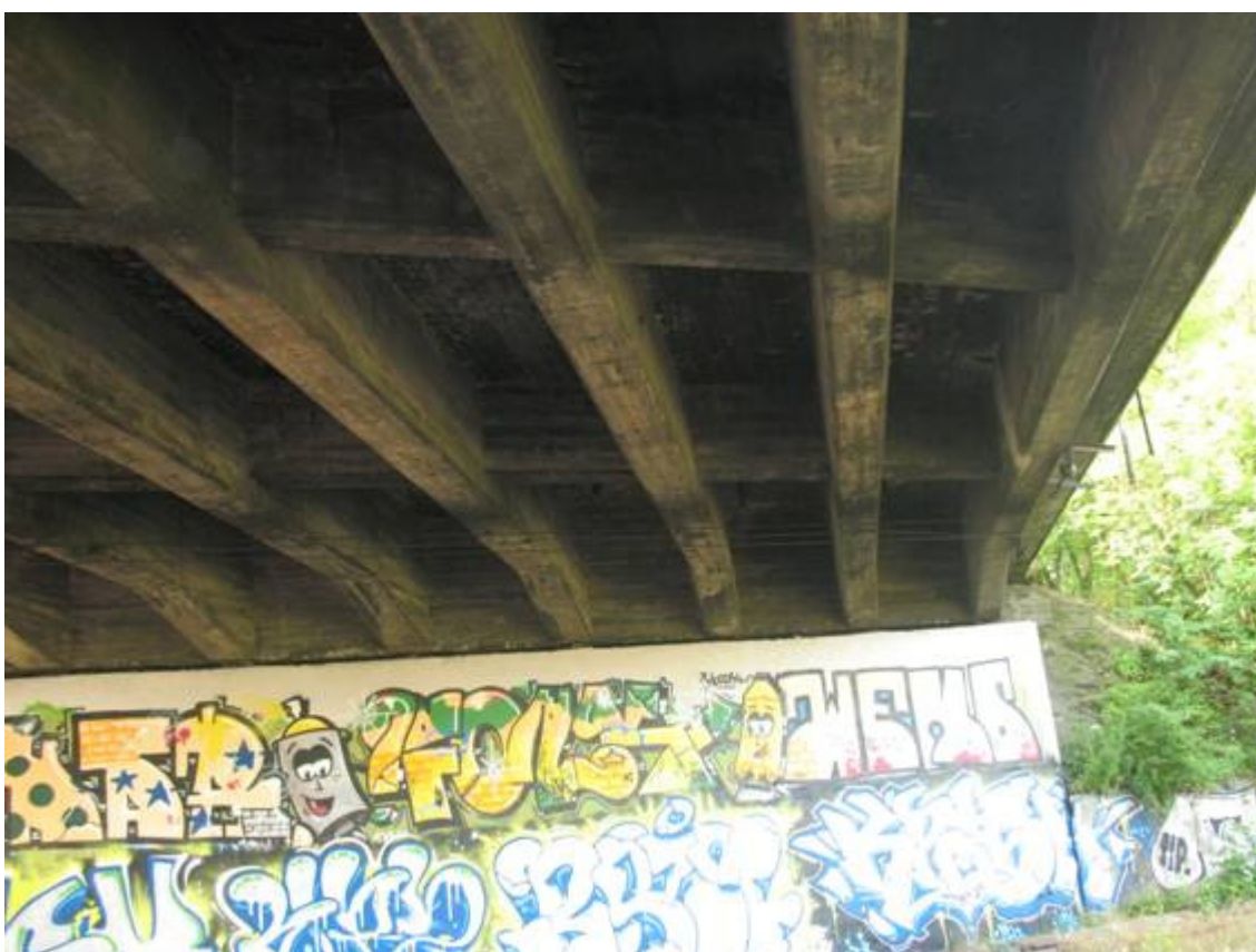
Fot. 12. Widok ustroju nośnego od spodu, prześto nr 4 oraz podpora nr 4. Widoczne wykwyty i osady na powierzchni betonu. Ubytki betonu z odstonięciem zbrojenia. Zbliżenie przewodów trakcji kolejowej do konstrukcji. Zabrudzenia na powierzchni betonu (graffiti).
