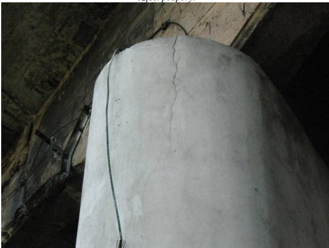
Fot. 18. Podpora nr 2, szczegół od strony północno-wschodniej. Widoczna rysa na powierzchni betonu.
