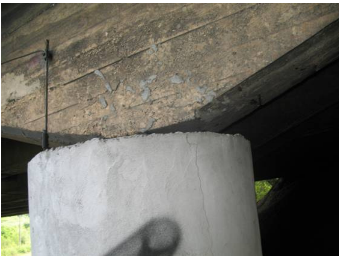
Fot. 18. Podpora nr 4, szczegół od strony zachodniej. Widoczna rysa na powierzchni betonu. Widoczne zabrudzenia betonu, mocowanie trójki do konstrukcji.
