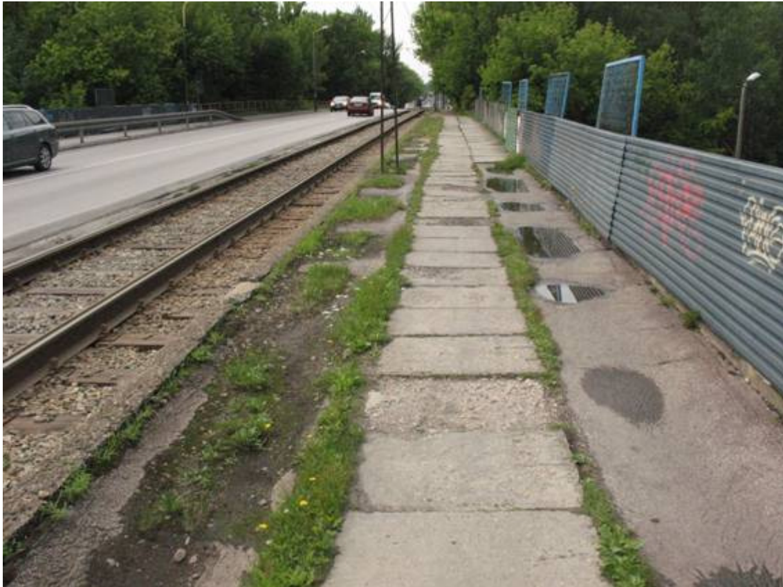
Fot. 25. Widok chodnika po stronie wschodniej. Widoczne deformacje nawierzchni chodnika. Gromadzenie się wody w deformacjach. Wegetacja roślin. Graffiti na blasze.
