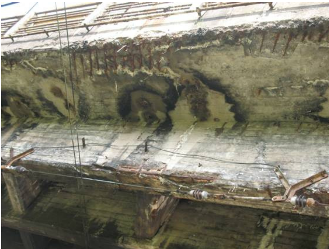
Fot. 27. Widok wspornik pomostu od spodu. Widoczne wykwity osady i zacieki na powierzchni betonu. Ubytki betonu z odsłonięciem zbrojenia, korozja zbrojenia. Elementy betonowe silnie zawilgocone w szczególności w sąsiedztwie sączków.
