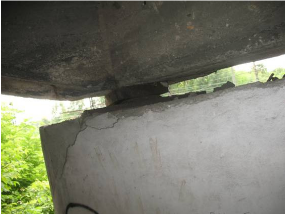
Fot. 17. Zarysowanie i ubytki betonu w strefie przypodporowej. Korozja stali łożyska.
