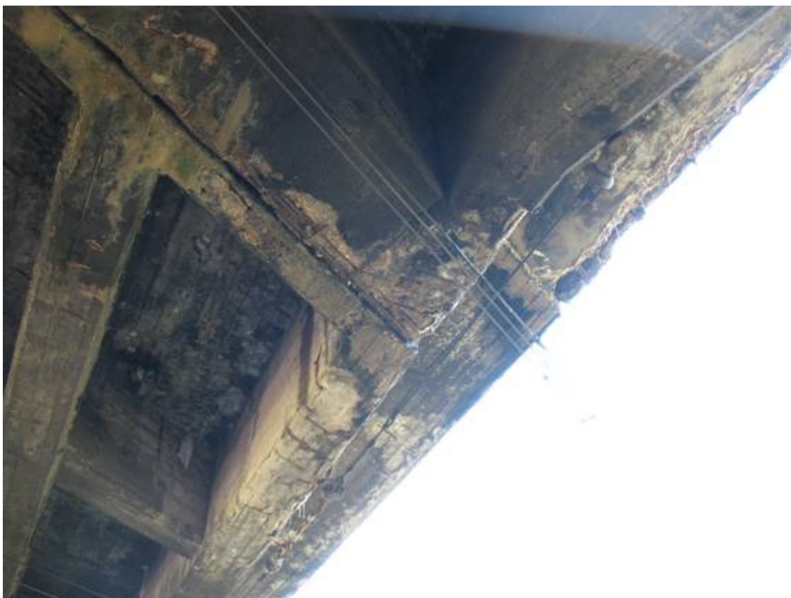
Fot. 23. Przęsło nr 3 szczegół uszkodzenia żebra od strony zachodniej w sąsiedztwie przegubu. Widoczne wykwity osady i zacieki na powierzchni betonu. Ubytki betonu z odstonięciem zbrojenia, korozja zbrojenia. Korozja stalowych elementów mocowania trakcji.
