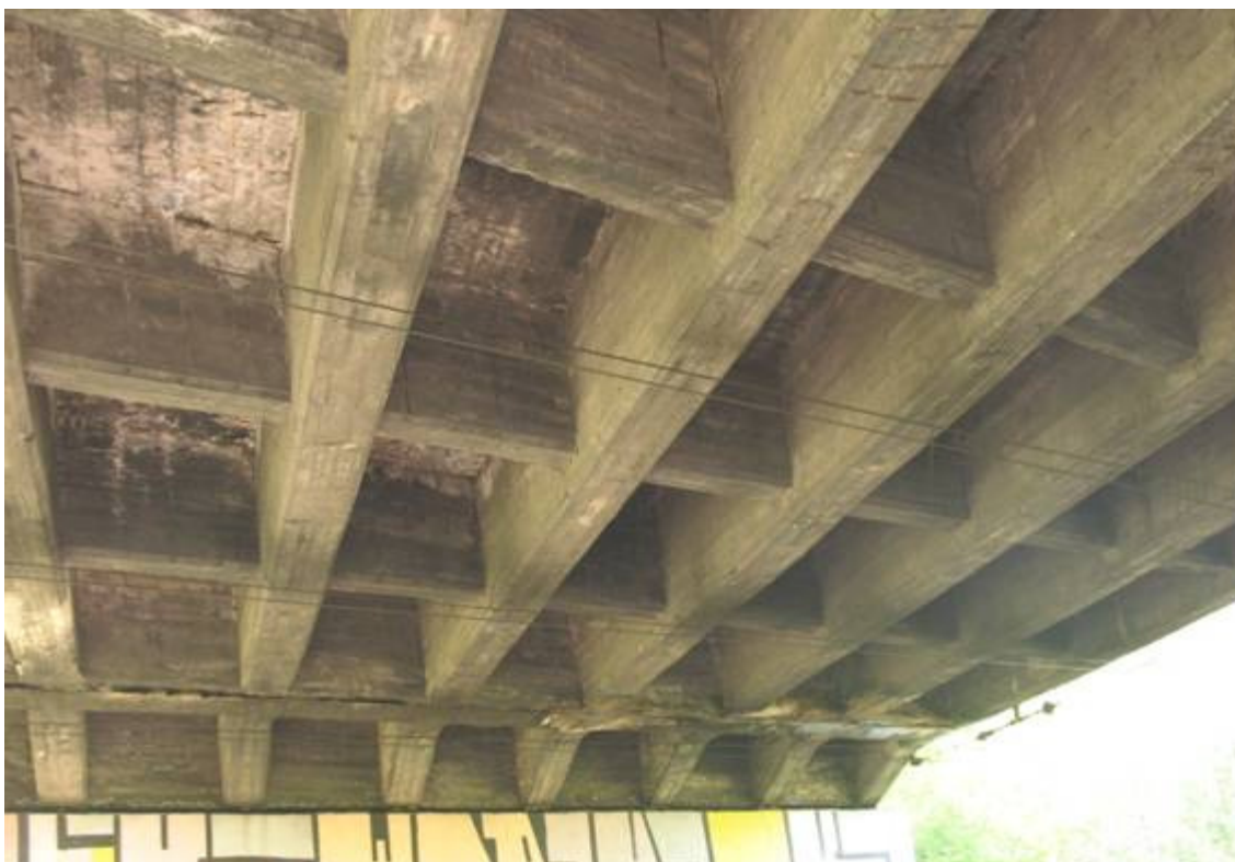
Fot. 11. Widok ustroju nośnego od spodu, prześto nr 3. Widoczne wykwyty i osady na powierzchni betonu. Ubytki betonu z odstonięciem zbrojenia. Zbliżenie trakcji do konstrukcji. Przemoczona konstrukcja i znaczna degradacja w sąsiedztwie dylatacji.
