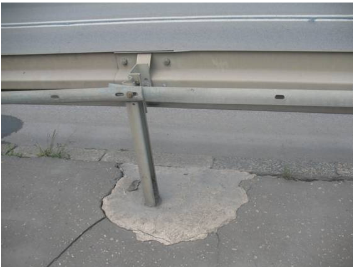
Fot. 33. Widok na mocowanie bariery energochłonnej do powierzchni chodnika po stronie zachodniej. Widoczne pęknięcia nawierzchni.
