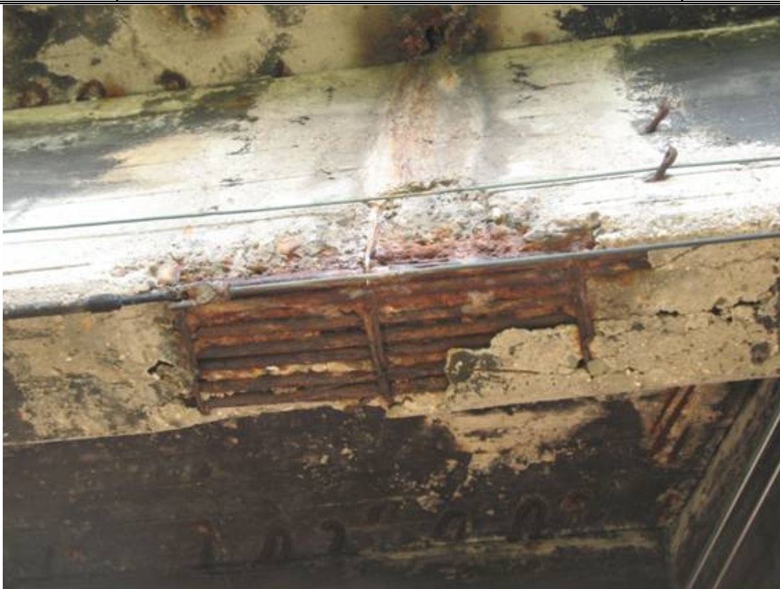
Fot. 15. Szczegół - ubytek betonu i zaawansowana korozja stali zbrojeniowej. Beton przemoczony, odpada z konstrukcji - niebezpieczeństwo !!
