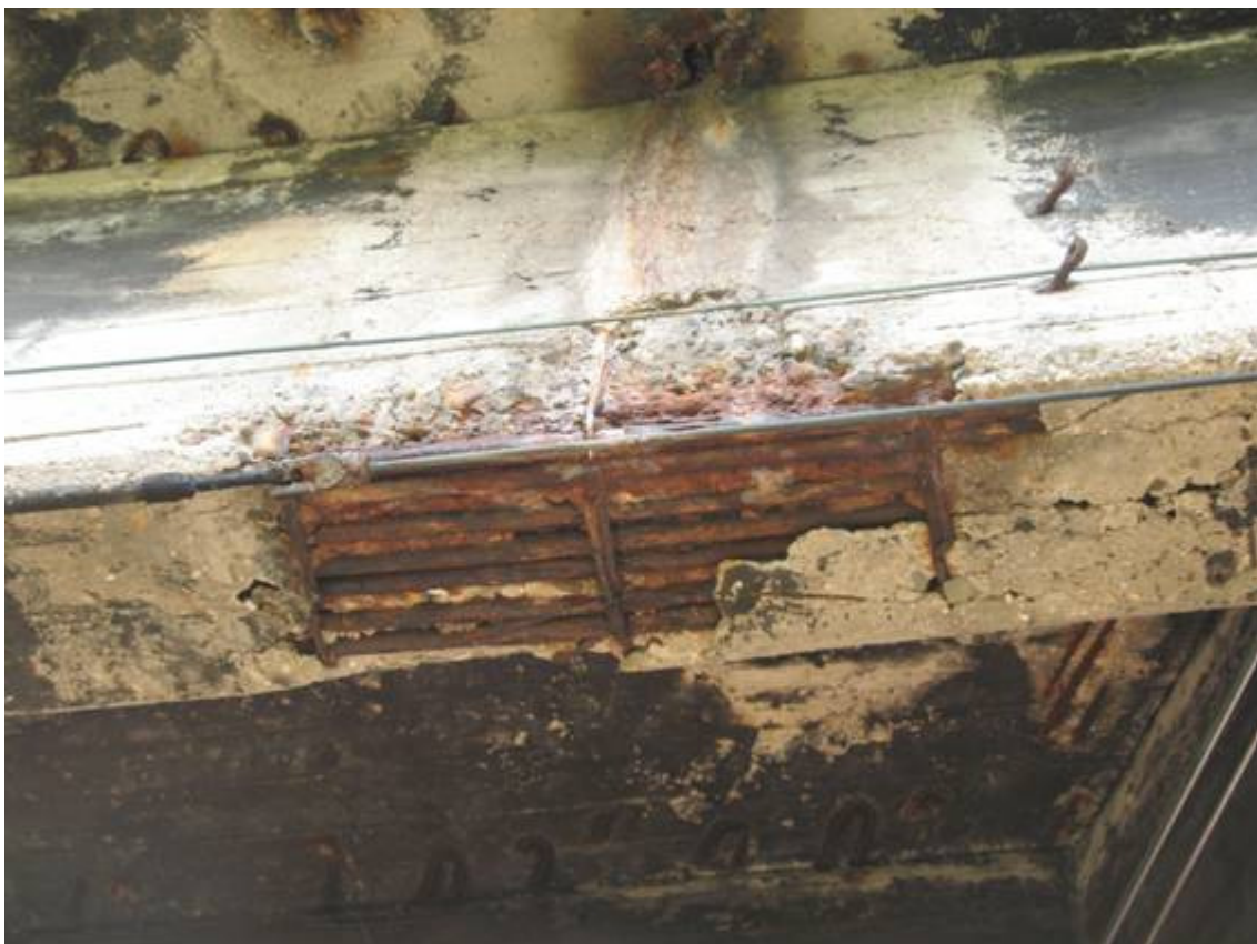
Fot. 10. Widok żebro od strony zachodniej. Korozja betonu i zbrojenia. Sączone zrzucanie wody bezpośrednio na element. Brak wymaganego rozstawu prętów między sobą.
