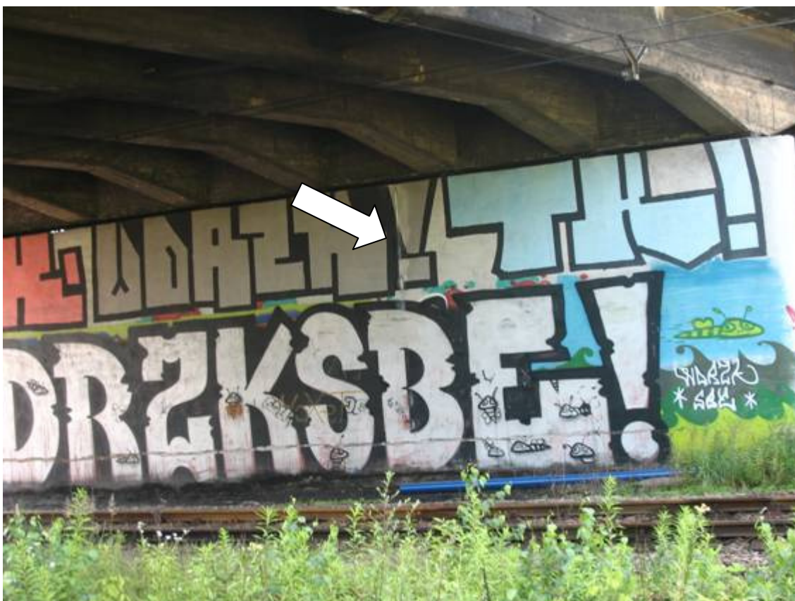
Fot. 14. Widok na podporę nr 2. Zabrudzenia na powierzchni betonu (graffiti). Widoczna rysa na powierzchni betonu.
