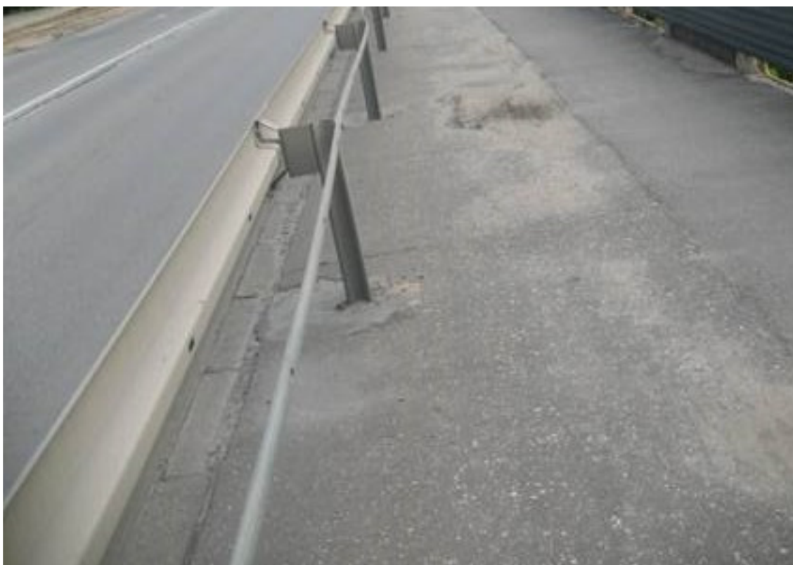
Fot. 30. Widok chodnika po stronie wschodniej. Widoczne deformacje nawierzchni chodnika.
