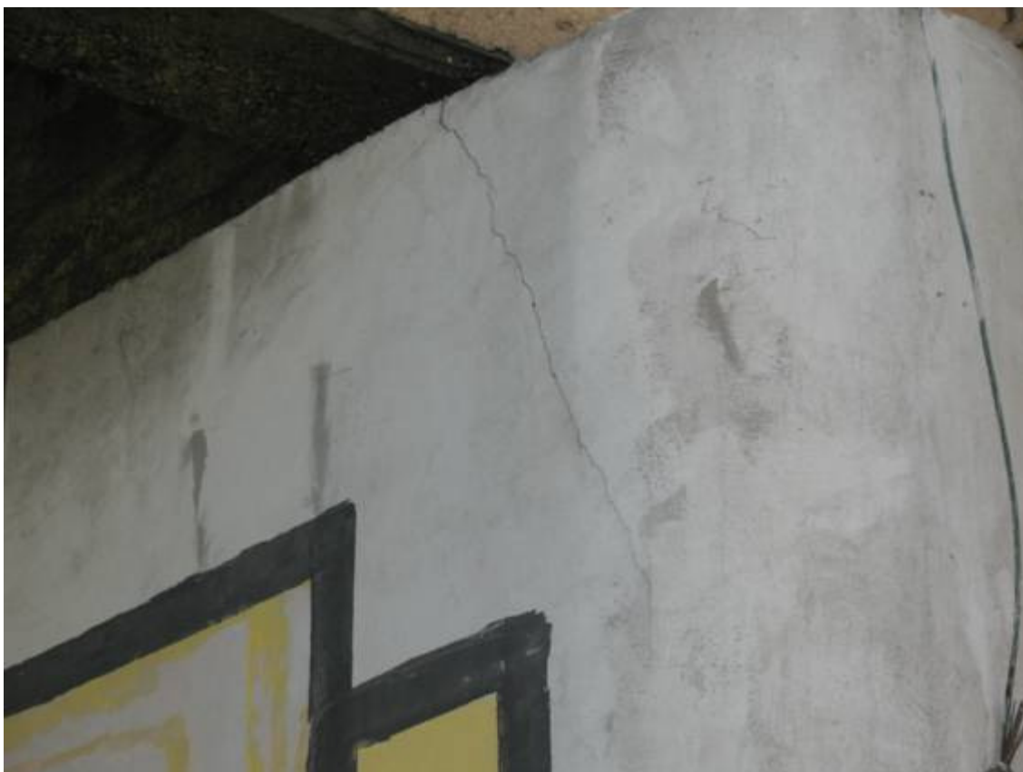
Fot. 17. Podpora nr 2, szczegół od strony południowo-wschodniej. Widoczna rysa na powierzchni betonu. Widoczne zabrudzenie betonu. Niewielkie zawilgocenie betonu w górnej części podpory.
