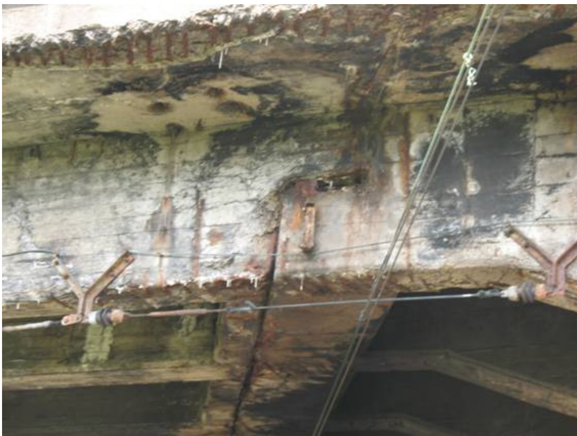
Fot. 21. Przęsło nr 3 szczegół uszkodzenia żebra od strony wschodniej w sąsiedztwie przegubu. Widoczne wykwitki(stalaktyty), osady i zacieki na powierzchni betonu. Ubytki betonu z odstonięciem zbrojenia, korozja zbrojenia. Korozja stalowych elementów mocowania trakcji.
