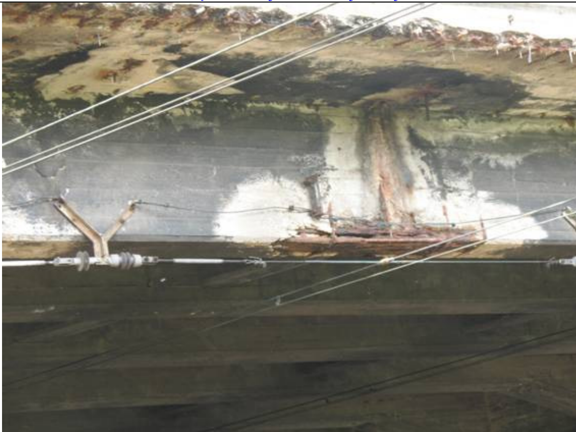
Fot. 8. Ubytki betonu, korozja prętów, zacieki na belce skrajnej od strony zachodniej. Wylot sączka na powierzchnię belki. Wykwity i stalaktyty na wsporniku.
