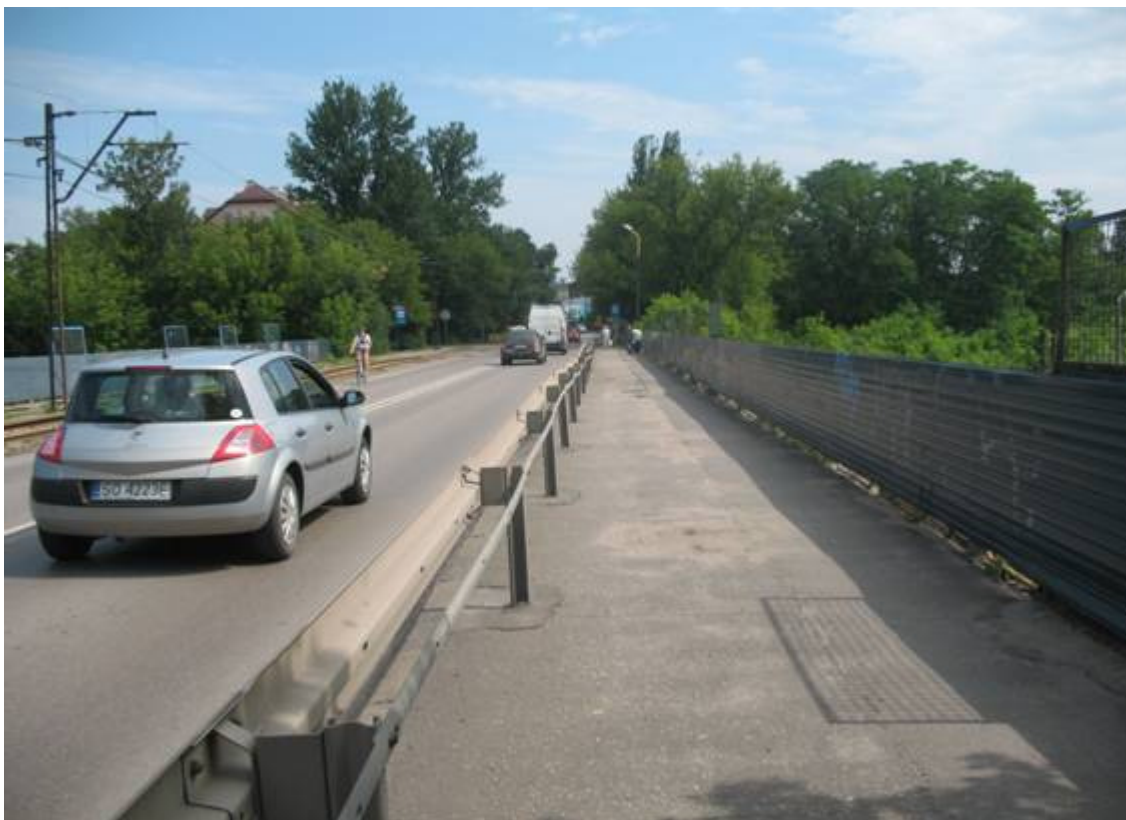
Fot. 7. Widok na chodnik po stronie wschodniej. Widoczne zabrudzenia na blasze trapezowej (graffiti). Odkształcenia i zarysowania nawierzchni chodnika.
