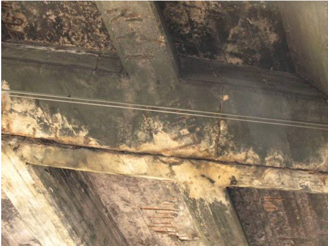
Fot. 11. Widok na przegub w przęśle środkowym. Zacieki, wykwyty, korozja prętów zbrojeniowych, korozja powierzchniowa betonu.
