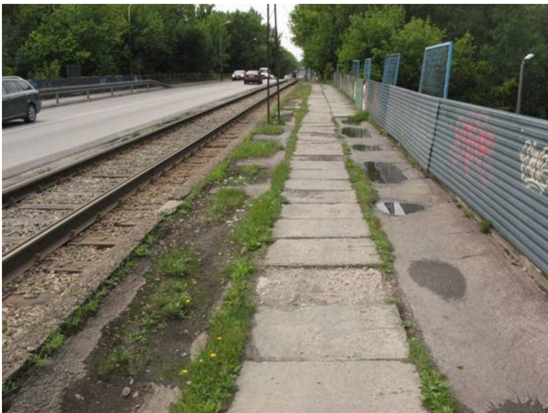
Fot. 31. Widok chodnika po stronie wschodniej. Widoczne deformacje nawierzchni chodnika. Gromadzenie się wody w deformacjach. Wegetacja roślin. Graffiti na blasze trapezowej.
