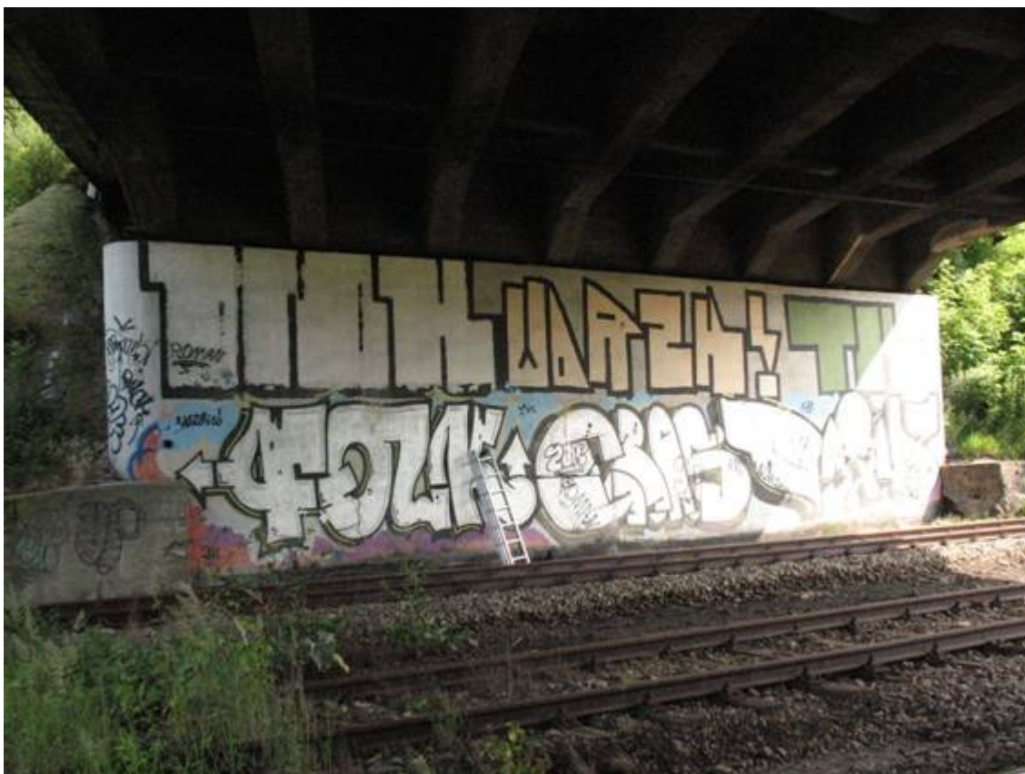
Fot. 15. Widok na podporę nr 2. Zabrudzenia na powierzchni betonu (graffiti).
