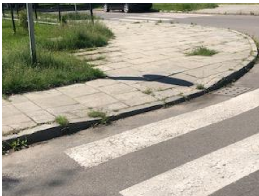
Rysunek 20. Stan techniczny istniejących krawężników przy przejściu dla pieszych na ul. Komandosów. Widok w kierunku ul. Minerów.
