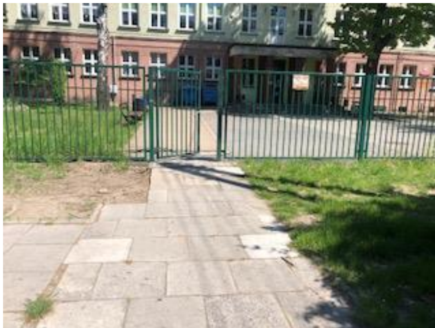
Rysunek 4. Stan techniczny istniejącego chodnika przy ogrodzeniu Szkoły Podstawowej nr 36..
