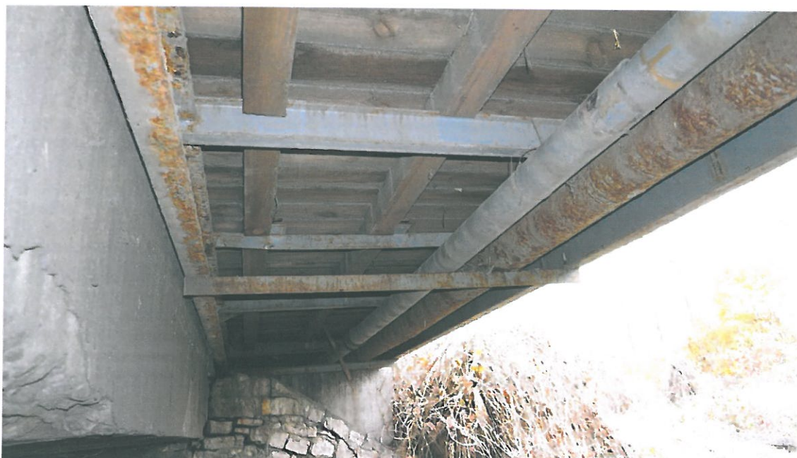
Fot. 16 Widok konstrukcji kładki od spodu - widoczna kolidująca infrastruktura techniczna w rurach osłonowych
