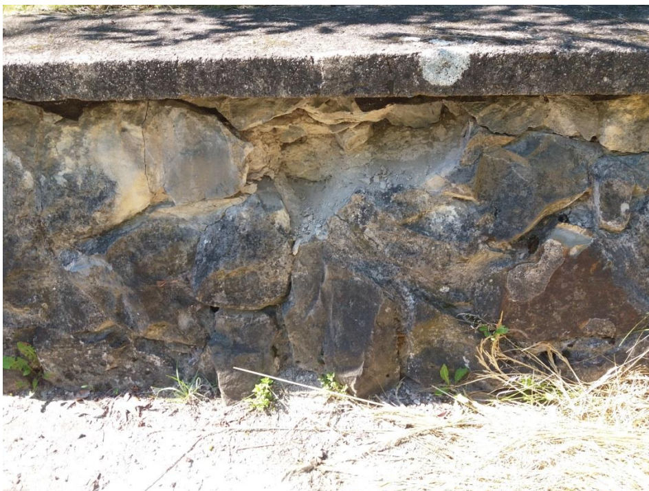
Rysunek 6. Widok na ścianę fontanny, miejsce w złym stanie stan technicznym, widoczne ubytki kamieni. (Źródło: własne).
