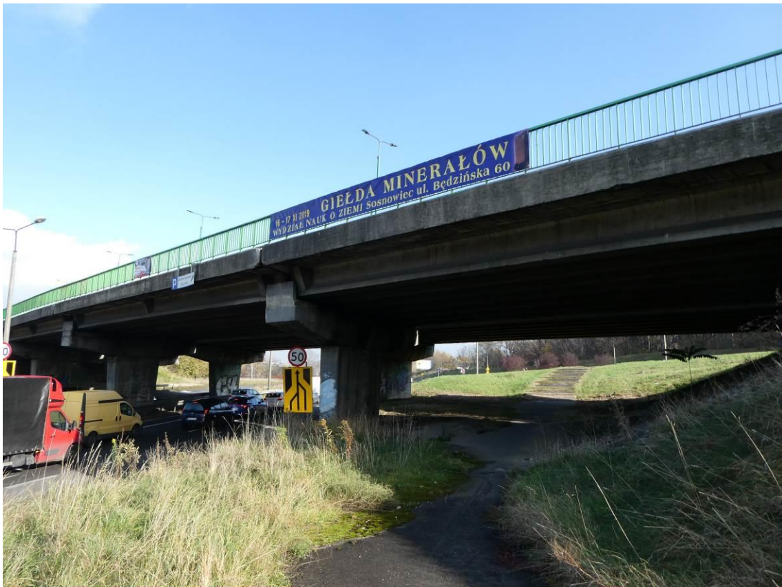
Fot. 1. Widok na obiekt. Korozja na gzymsach, wegetacja roślin przy obiekcie.
