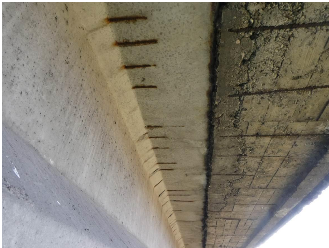
Fot. 11. Ubytki betonu na dźwigarze, korozja prętów zbrojeniowych.
