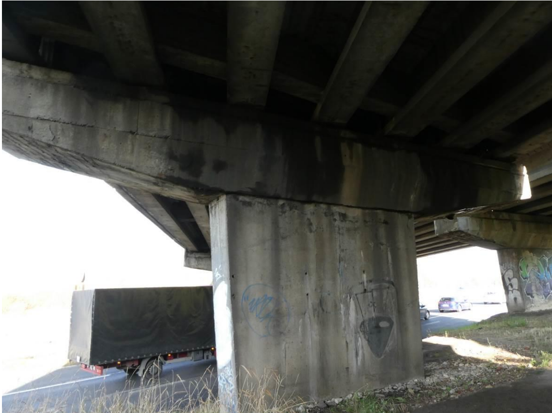
Fot. 9. Znaczne zacieki na oczępie podpory pośredniej. Odspojenie otuliny betonowej na filarze.
