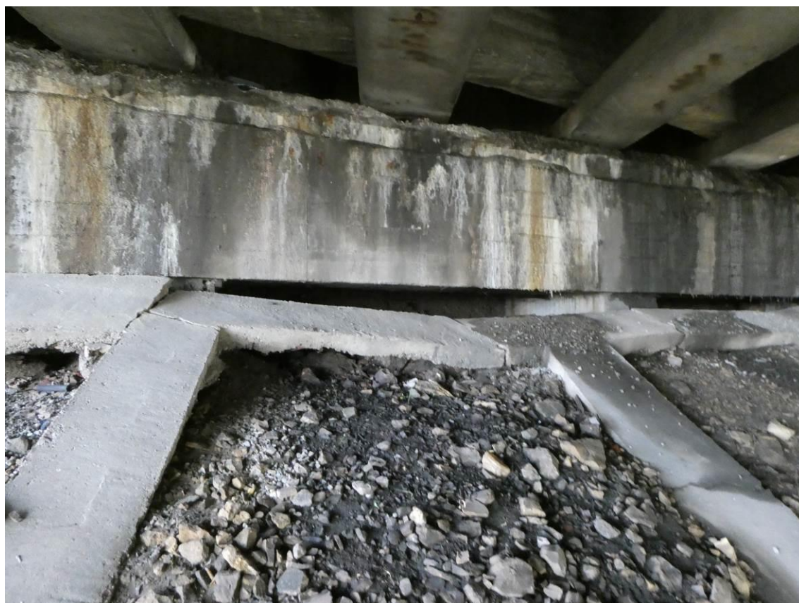
Fot. 12. Znaczne osady i zacieki na przyczółku. Pęknięcie i przemieszczenie umocnienia skarpy.
