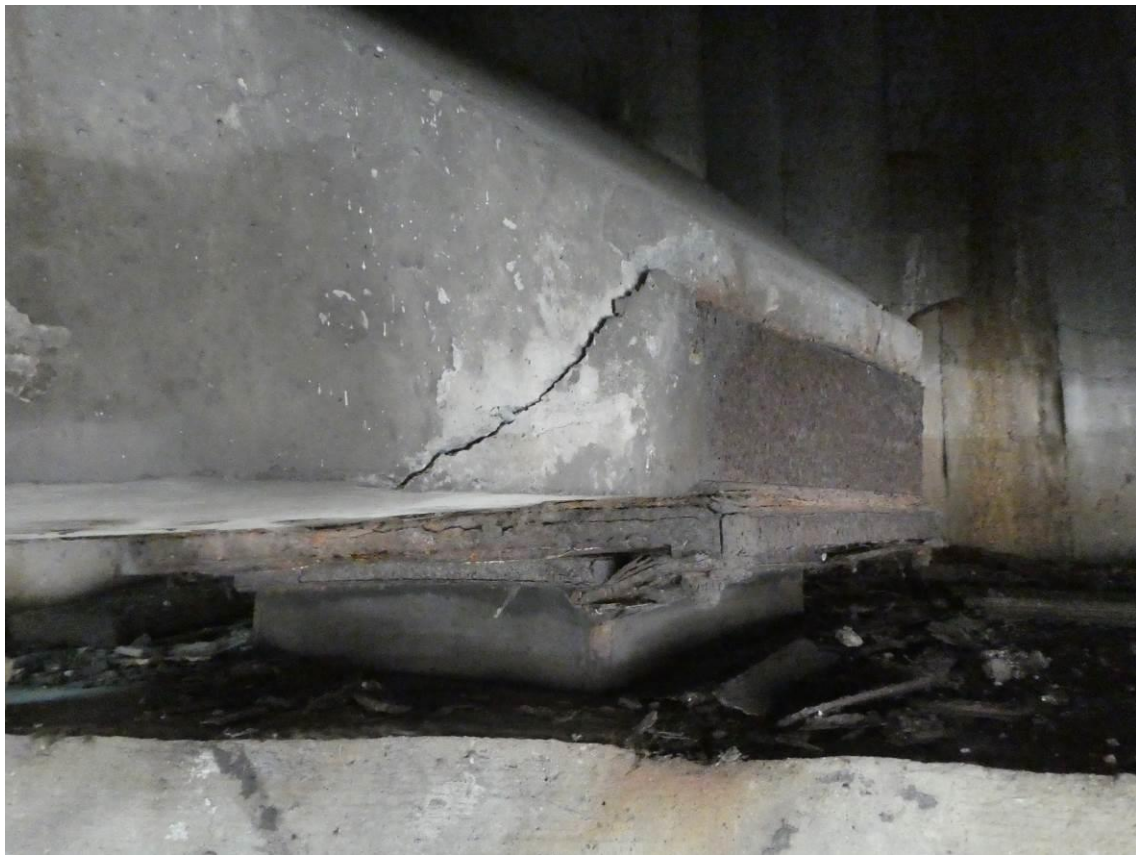
Fot. 3. Widok na łożysko elastomerowe. Rozwarstwienie stali łożyska. Zacieki na ścianie zapleczej.
