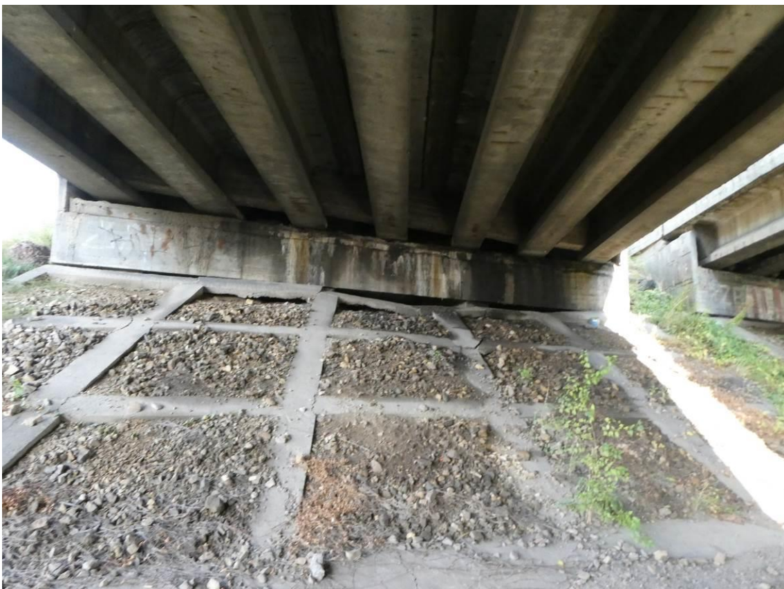
Fot. 8. Widok na podporę skrajną i skarpe pod obiektem. Pęknięcie elementów betonowych umocnienia. Zacieki i wykwyty na przyczółku.
