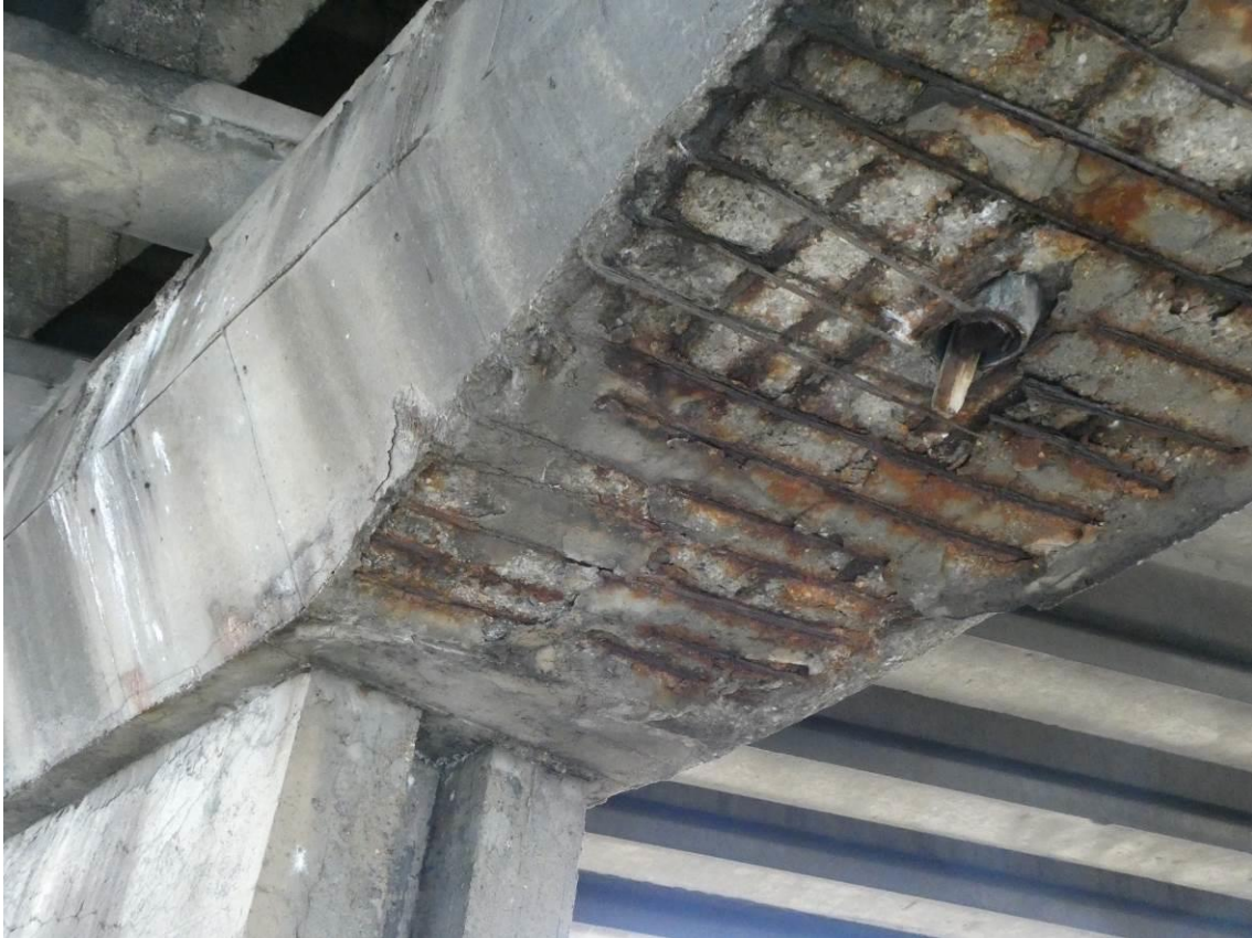
Fot. 7. Widok na oczep filara. Znaczne ubytki betonu oraz korozja stali zbrojeniowej. Rozwarstwienie prętów zbrojeniowych.
