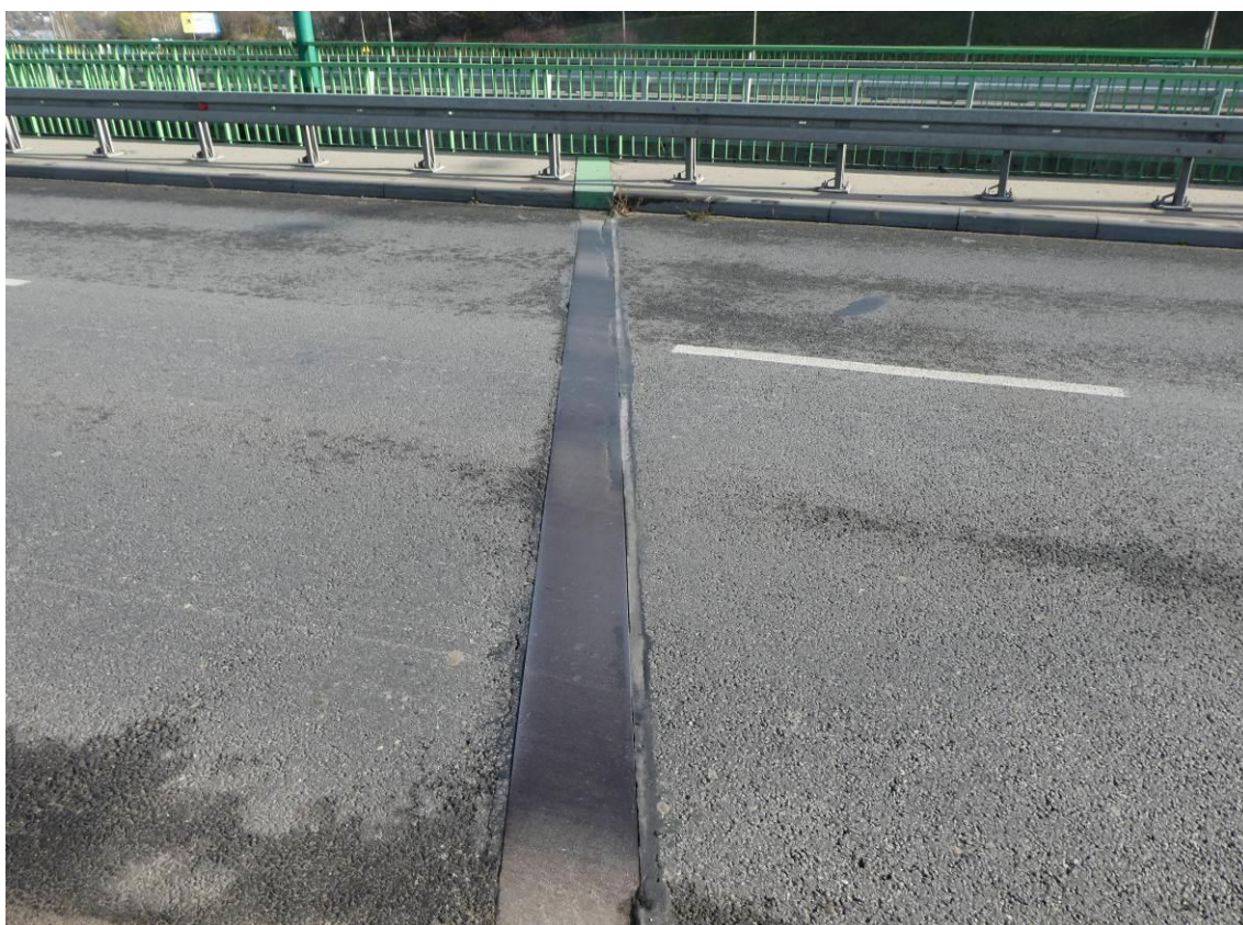
Fot. 6. Widok na urządzenie dylatacyjne. Korozja stali, wegetacja roślin.
