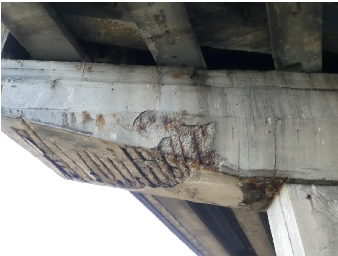
Fot. 14. Degradacja betonu na oczepie, spękania siatkowe na filarze.
