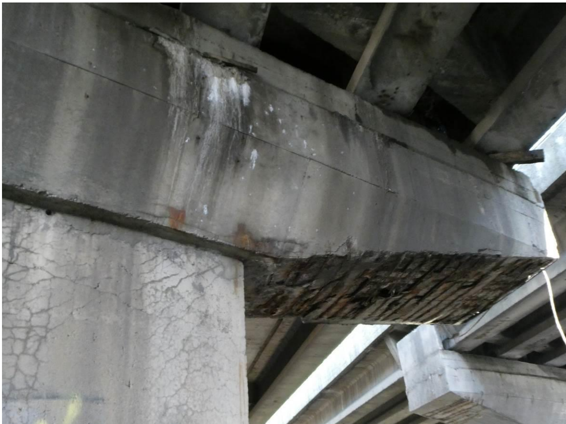
Fot. 10. Degradacja betonu na oczępie. Znaczna korozja prętów zbrojeniowych. Zarysowania siatkowe na filarze. Przecieki i osady na oczępie.
