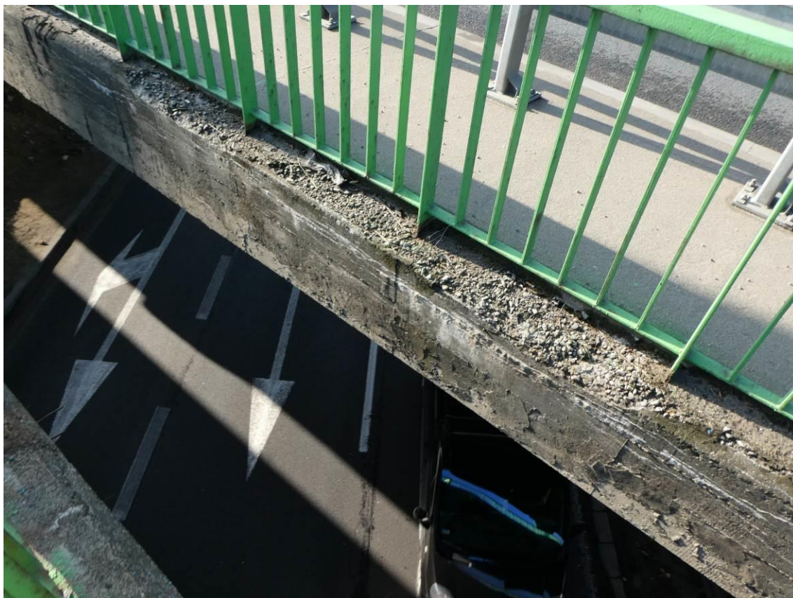
Fot. 13. Degradacja gzymsów. Ryzyko opadania betonu na pojazdy.
