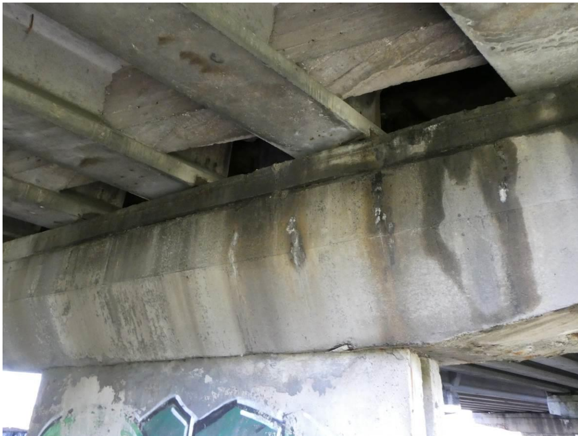
Fot. 9. Znaczne zacieki na oczepie podpory pośredniej. Odspojenie otuliny betonowej na filarze.
