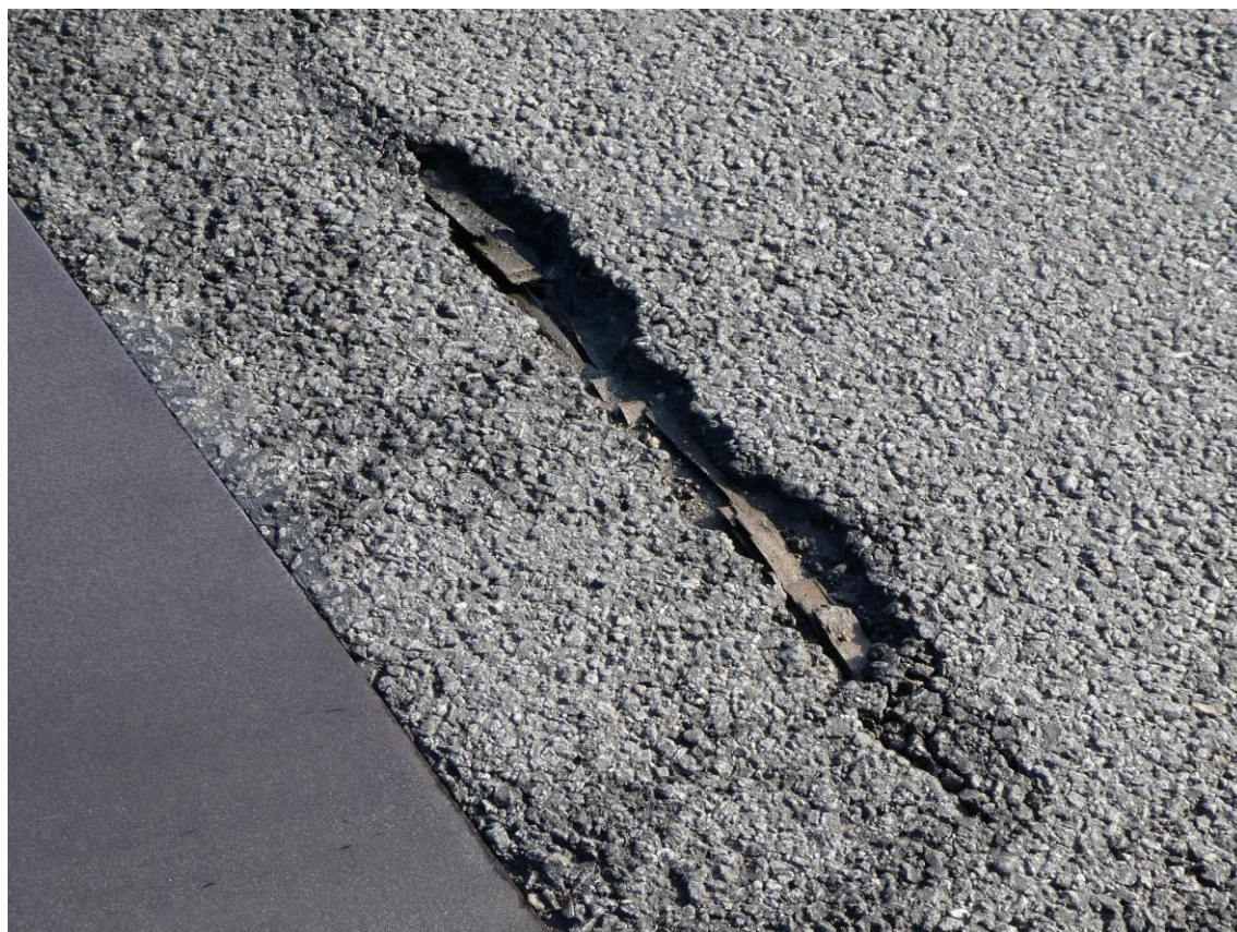
Fot. 14. Ubytki nawierzchni na dojeździe.
