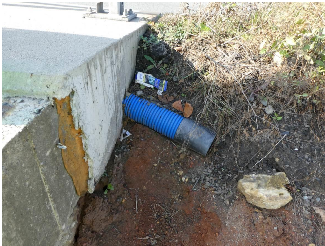
Fot. 15. Ubytek gruntu i odsłonięta osłona urządzenia obcego.
