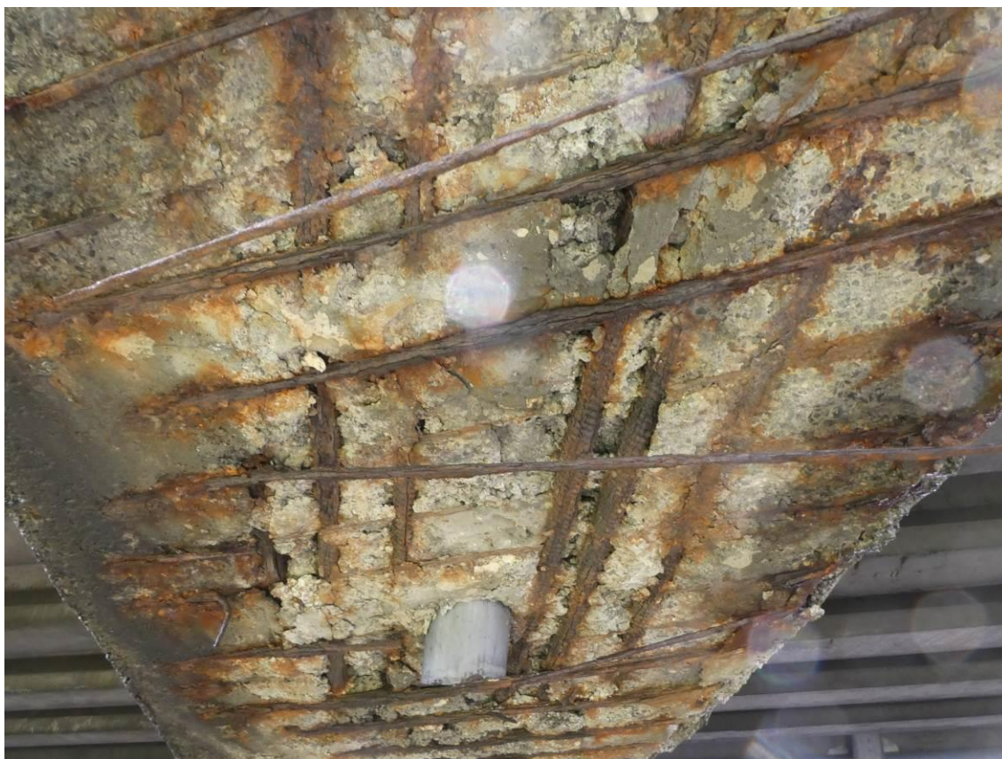
Fot. 10. Degradacja betonu na oczepie. Znaczna korozja prętów zbrojeniowych. Zarysowania siatkowe na filarze.
