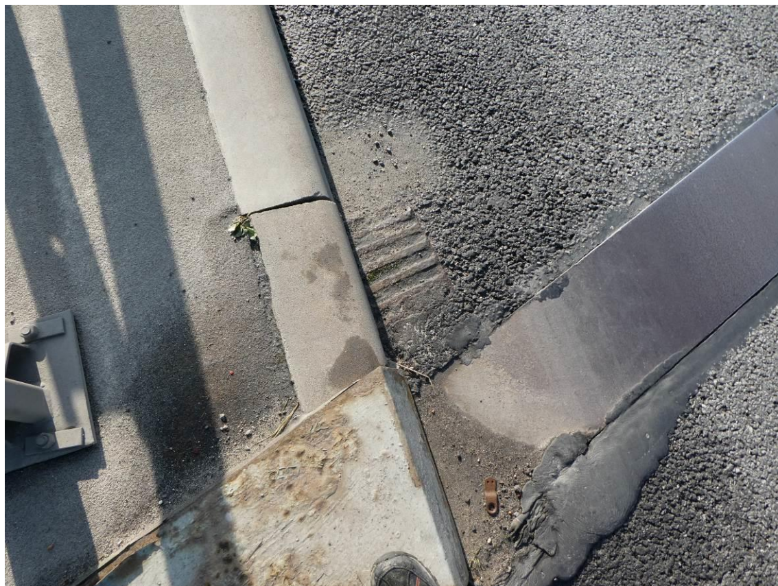
Fot. 13. Całkowicie niedrożne wpusty na obiekcie.
