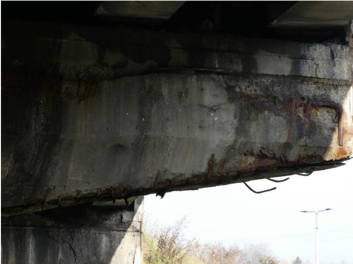
Fot. 7. Widok na oczepek filara. Znaczne ubytki betonu oraz korozja stali zbrojeniowej. Rozwarstwienie prętów zbrojeniowych.
