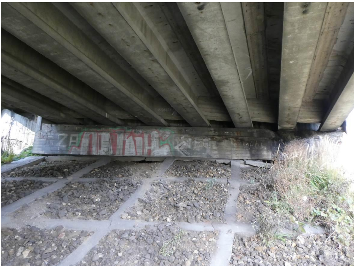
Fot. 8. Widok na podporę skrajną i skarpę pod obiektem. Pęknięcia elementów betonowych umocnienia. Zacieki i wykwyty na przyczółku.
