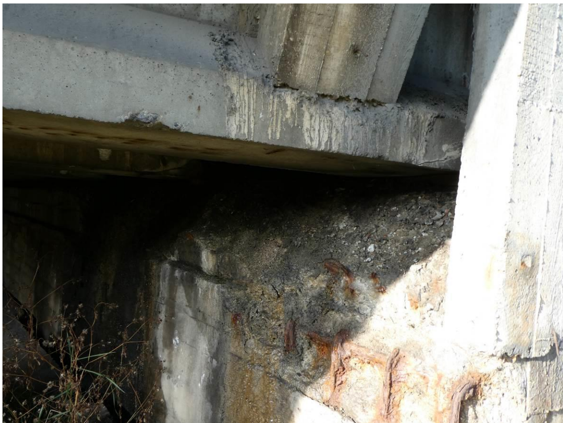
Fot. 12. Degradacja betonu na przyczółku. Korozja stali zbrojeniowej, korozja łożyska dźwigara skrajnego.
