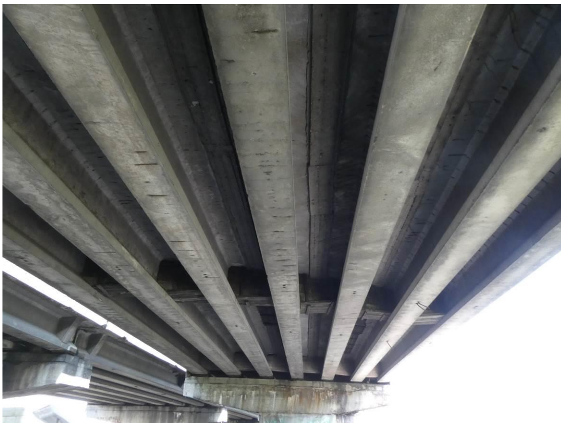
Fot. 2. Widok na dźwigary. Zacieki na dźwigarach, korozja strzemion.
