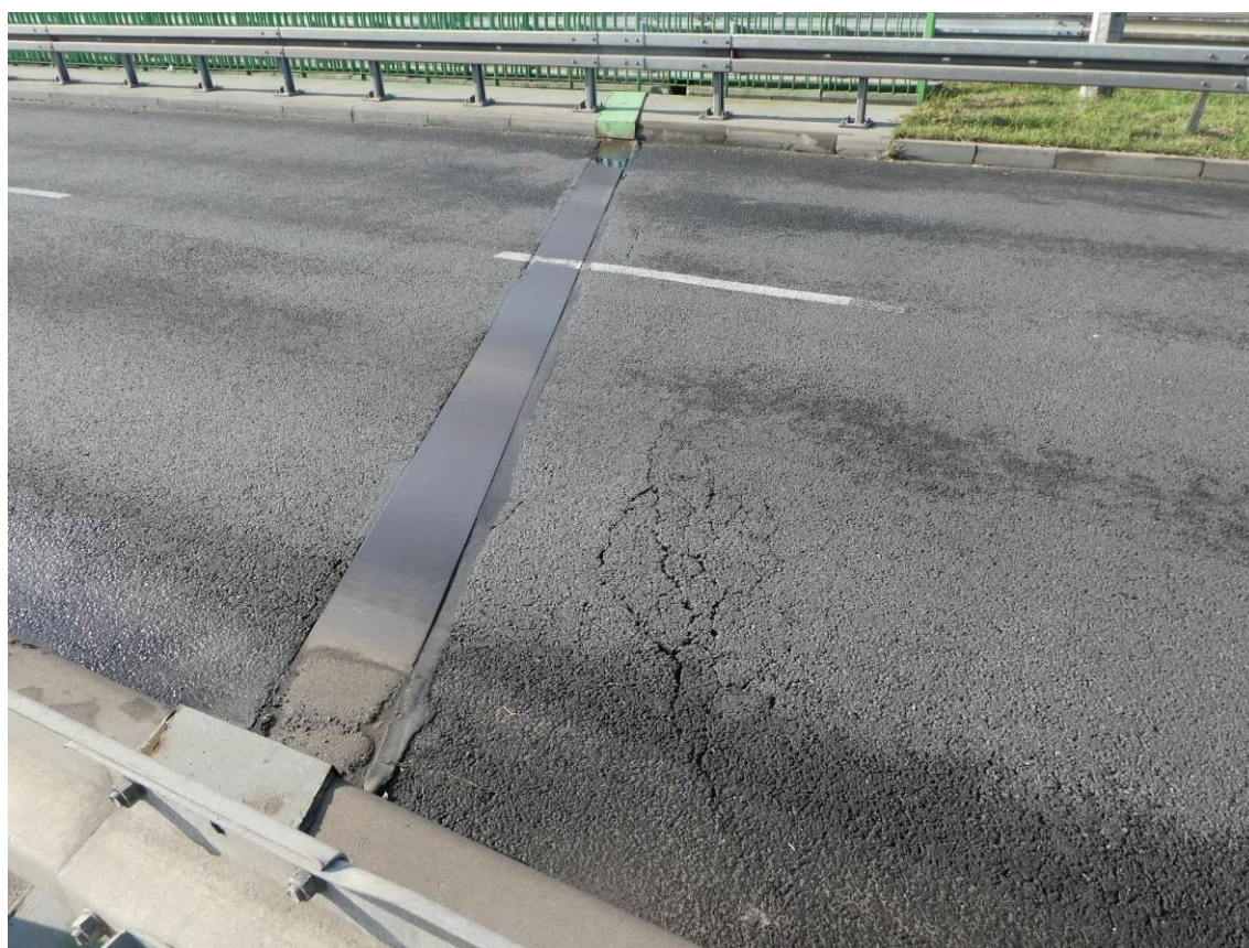
Fot. 4. Nawierzchnia na obiekcie i dojeździe. Spękanie nawierzchni na dojeździe.
