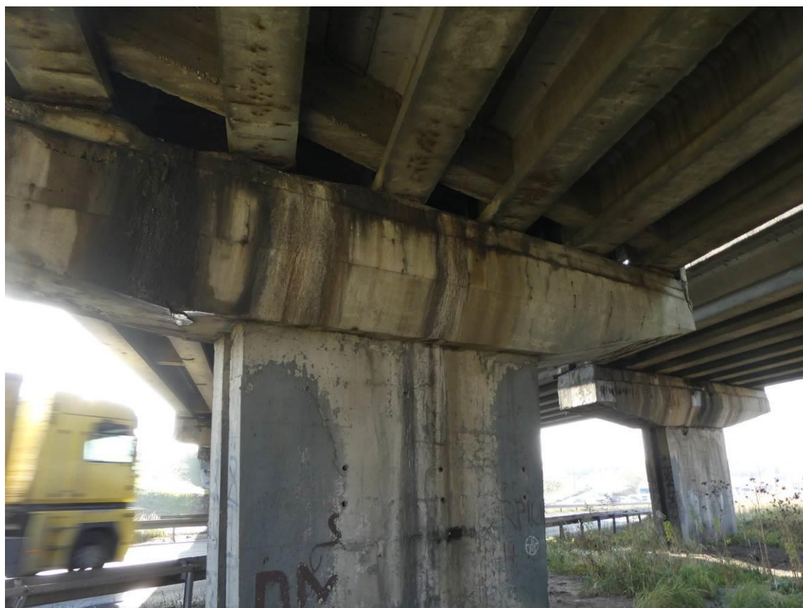
Fot. 16. Znaczne zacieki i korozja betonu na oczepie i filarze.
