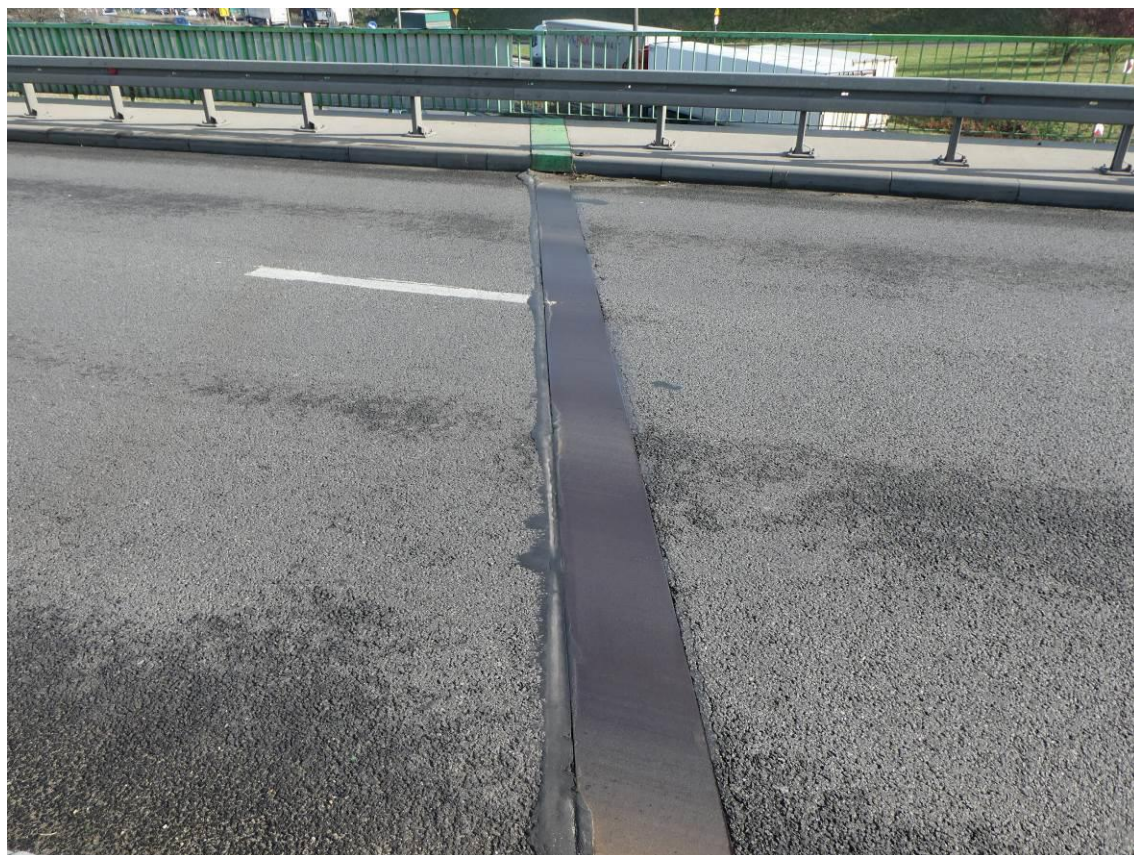
Fot. 6. Widok na urządzenie dylatacyjne. Korozja stali
