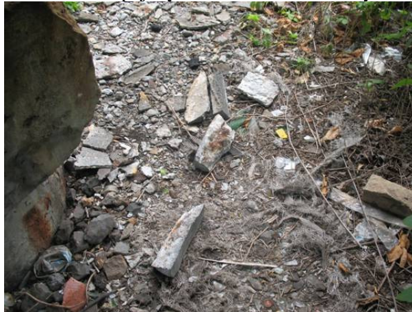
Próbki, odspojonych elementów betonowych
