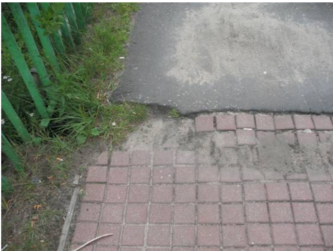
Fot. 37. Widok powierzchni chodnika nad przyczółkiem od strony południowej. Odkształcenia nawierzchni chodnika. Widoczna wegetacja roślin.
