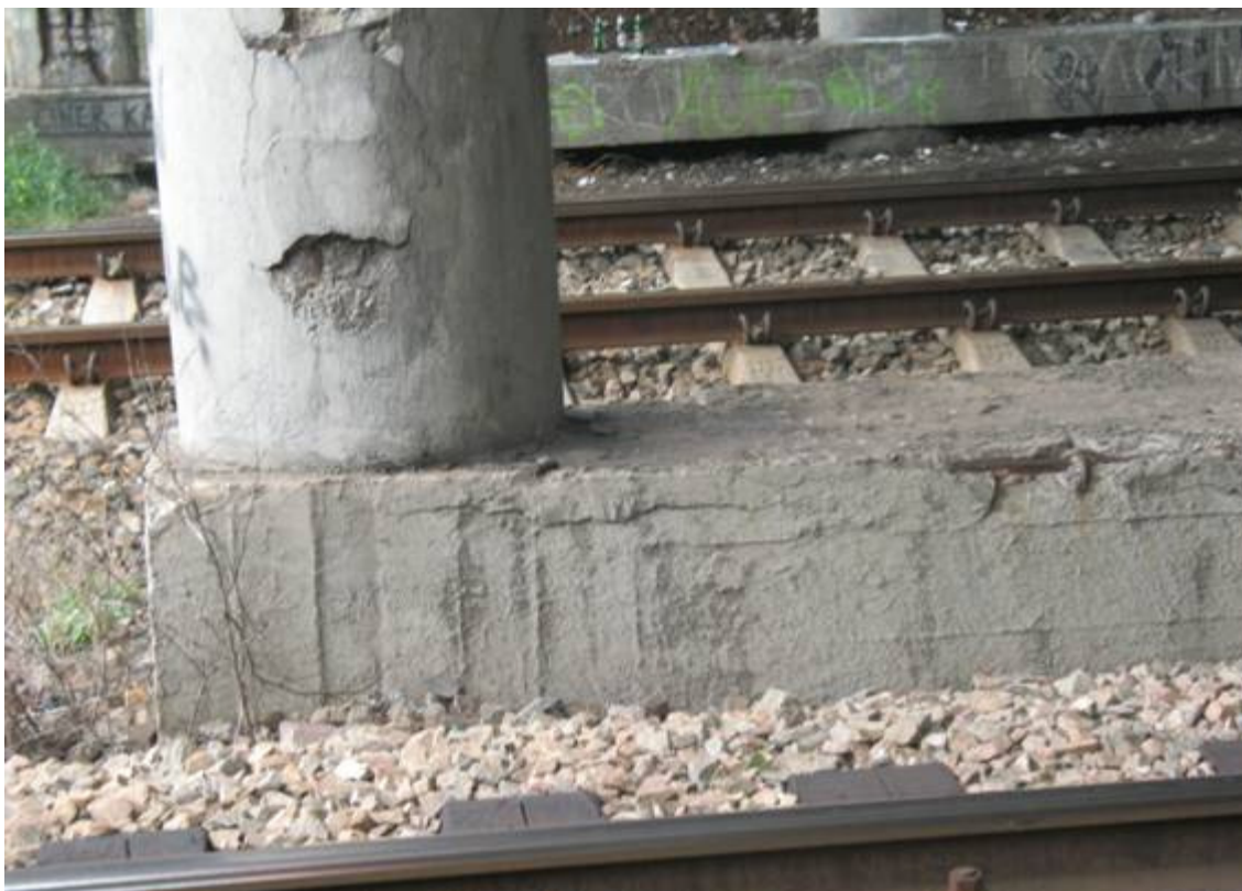
Fot. 27. Widok na filar i podstawę C. Widoczne ubytki betonu z odsłonięciem zbrojenia. Korozja zbrojenia. Zabrudzenia betonu (graffiti). Zarysowania na powierzchni betonu.
