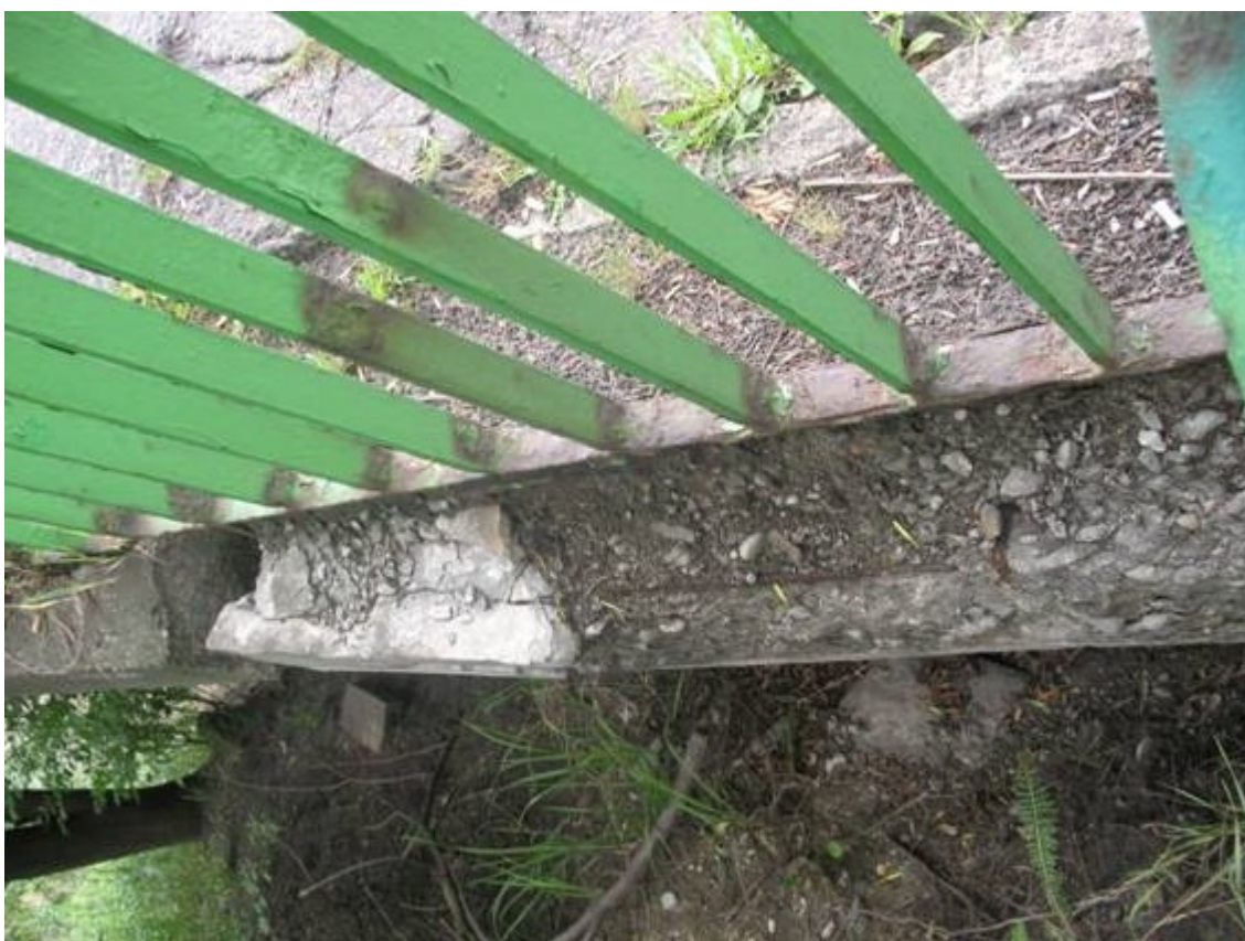
Fot. 32. Widok na gzyms nad przyczółkiem od strony północnej. Ubytki betonu z odstąpieniem zbrojenia.
