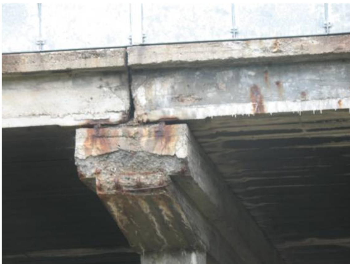
Fot. 16. Szczegół środkowego oczepu po stronie zachodniej. Widoczne ubytki betonu z odstąpieniem zbrojenia. Korozja zbrojenia. Korozja szyn stalowych zastępujących łożyska. Zabrudzenia betonu. Widoczne zacieki i osady na powierzchni betonu.
