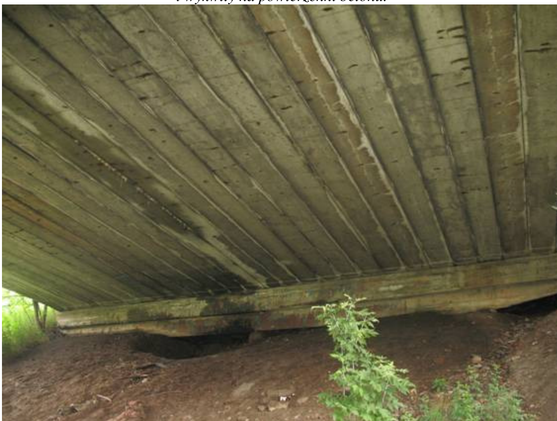
Fot.14. Widok na przyczółek ze strony północnej. Widoczne ubytki gruntu. Widoczne osady i wykwyty na powierzchni betonu.
