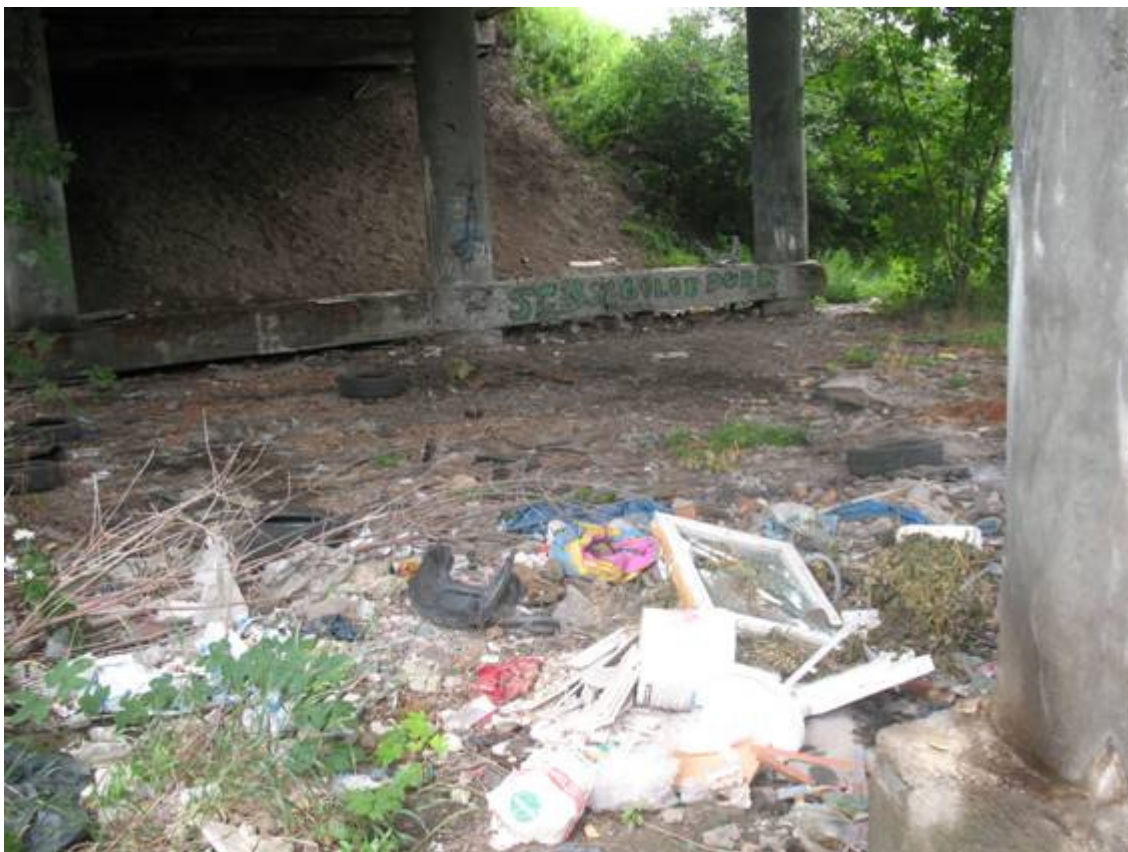
Fot. 30. Widok na przestrzeń pod obiektem. Gromadzenie odpadów pod obiektem. Wegetacja roślin pod obiektem.
