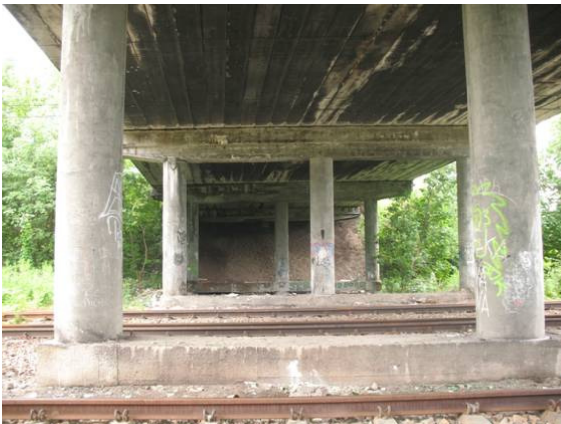
Fot. 9. Widok konstrukcji nośnej. Widoczne wykwity, osady i zacieki. Zabrudzenia na powierzchni filarów. Ubytki betonu na oczepach i podstawie filarów.
