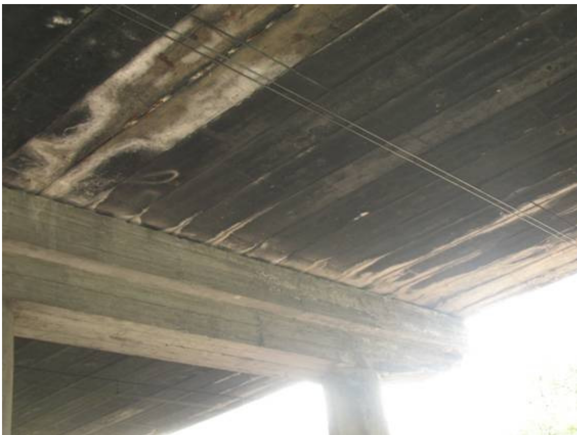
Fot. 11. Szczegół ustroju nośnego. Widoczne wykwity, osady i zacieki.
