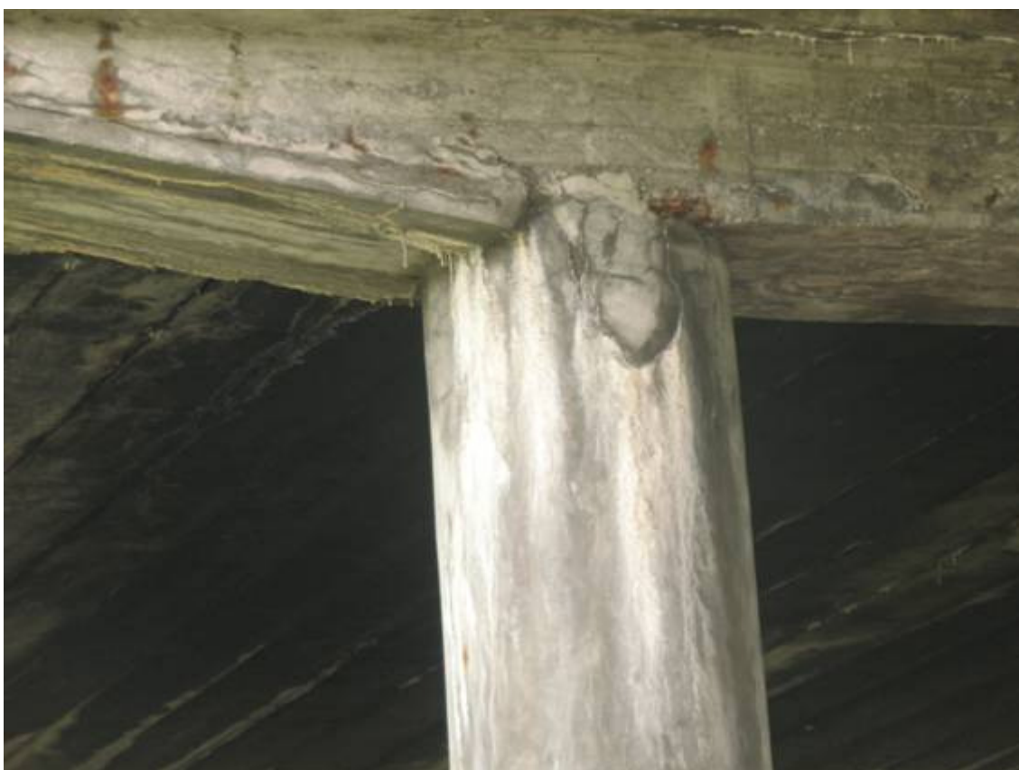
Fot. 22. Szczegół filarów. Widok na filar i oczep. Widoczne ubytki betonu z odsłonięciem zbrojenia. Zabrudzenia betonu. Zacieki i wykwity na powierzchni betonu.
