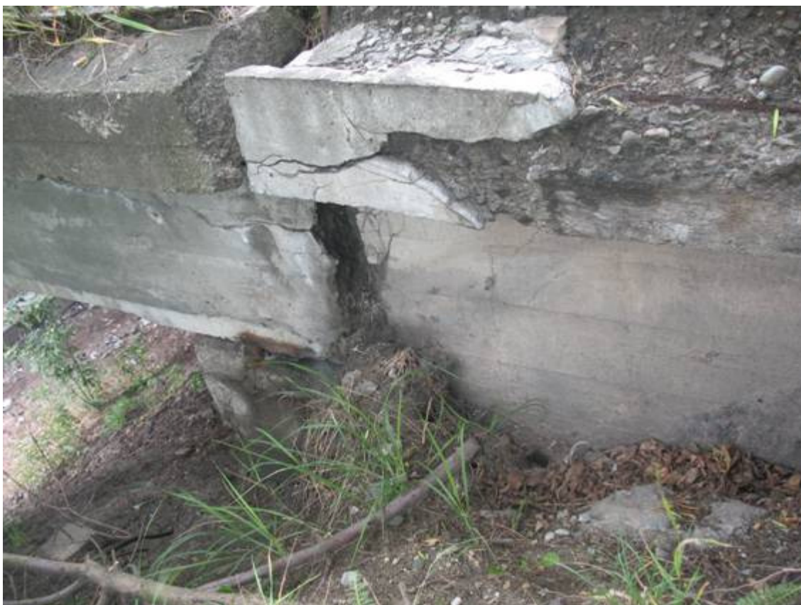
Fot. 31. Widok na dylatacje nad przyczółkiem od strony północnej. Ubytki betonu z odstąpieniem zbrojenia. Zarysowania na powierzchni betonu. Wegetacja roślin.
