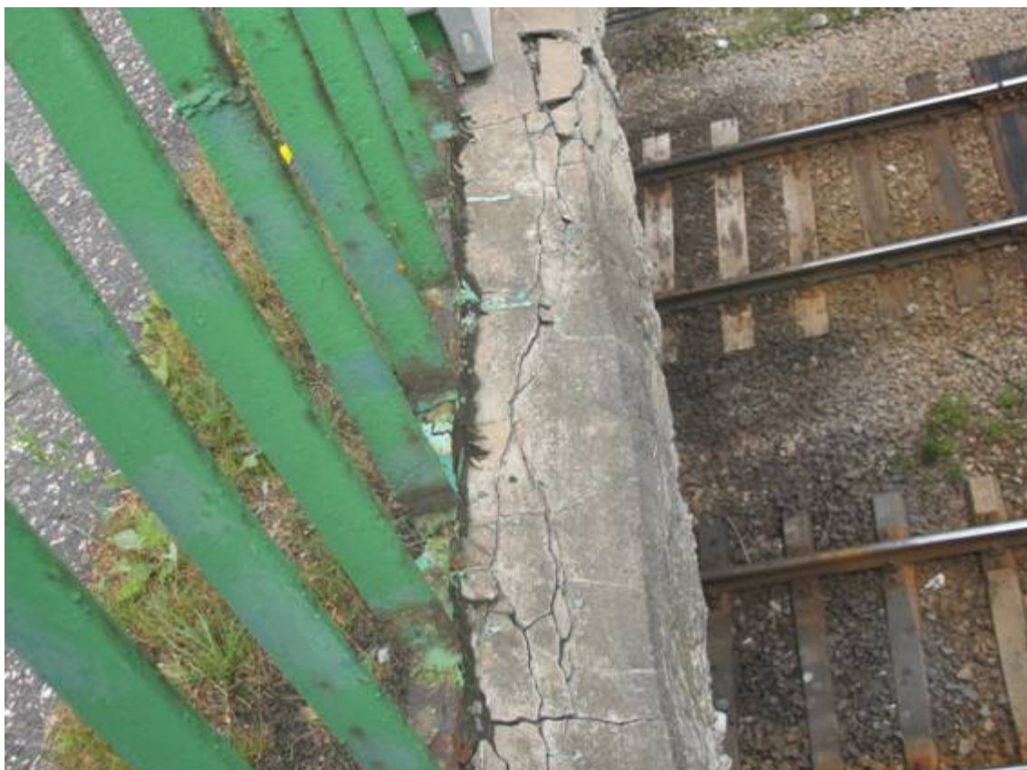
Fot. 33. Widok na gzyms po stronie wschodniej. Widoczne ubytki betonu, zarysowania betonu. Widoczna wegetacja roślin na powierzchni gzymsu. Zabrudzenia na powierzchni barierek. Korozja stali barierek. Deformacja elementów stalowych.
