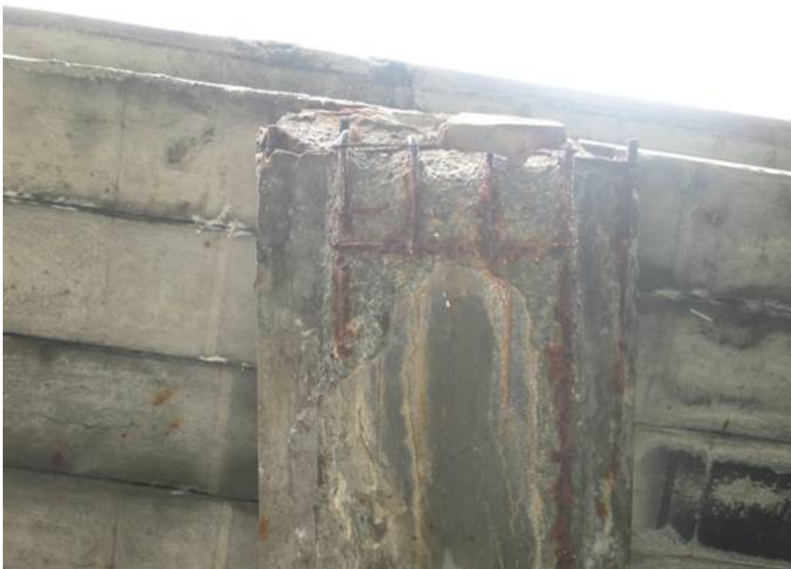
Fot. 19. Szczegół oczepu po stronie wschodniej. Widoczne ubytki betonu z odsłonięciem zbrojenia. Korozja zbrojenia. Zabrudzenia betonu.
