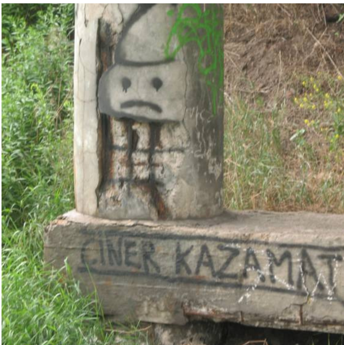
Fot. 26. Widok na filar i podstawę B. Widoczne ubytki betonu z odsłonięciem zbrojenia. Korozja zbrojenia. Zabrudzenia betonu (graffiti). Zarysowania, wykwyty i osady na powierzchni betonu. Ubytki gruntu pod podstawą.
