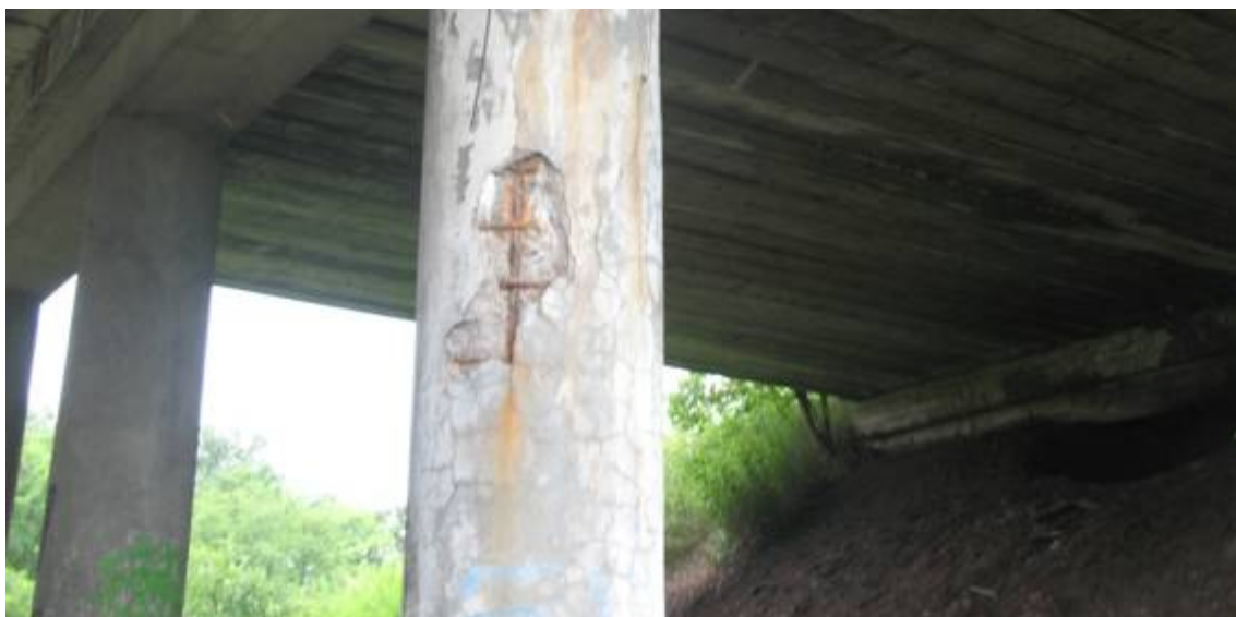
Fot. 25. Widok na filar B. Widoczne ubytki betonu z odsłonięciem zbrojenia. Korozja zbrojenia, zanieczyszczenia (graffiti). Zarysowania, wykwyty i osady na powierzchni betonu.
