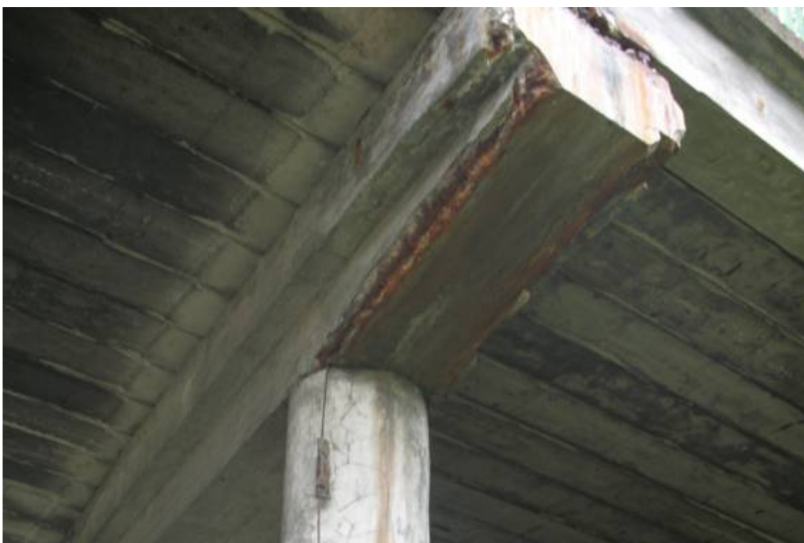
Fot. 20. Szczegół oczepu po stronie wschodniej. Widoczne ubytki betonu z odsłonięciem zbrojenia. Korozja zbrojenia. Zabrudzenia betonu.
