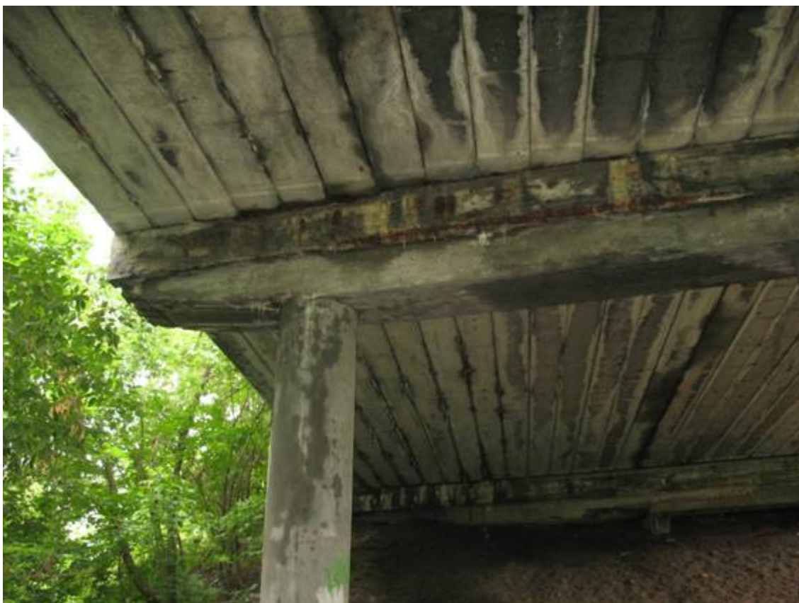
Fot. 21. Widok na filar i oczep B. Widoczne ubytki betonu z odsłonięciem zbrojenia. Korozja zbrojenia. Zabrudzenia betonu. Zacieki i wykwity na powierzchni betonu.
