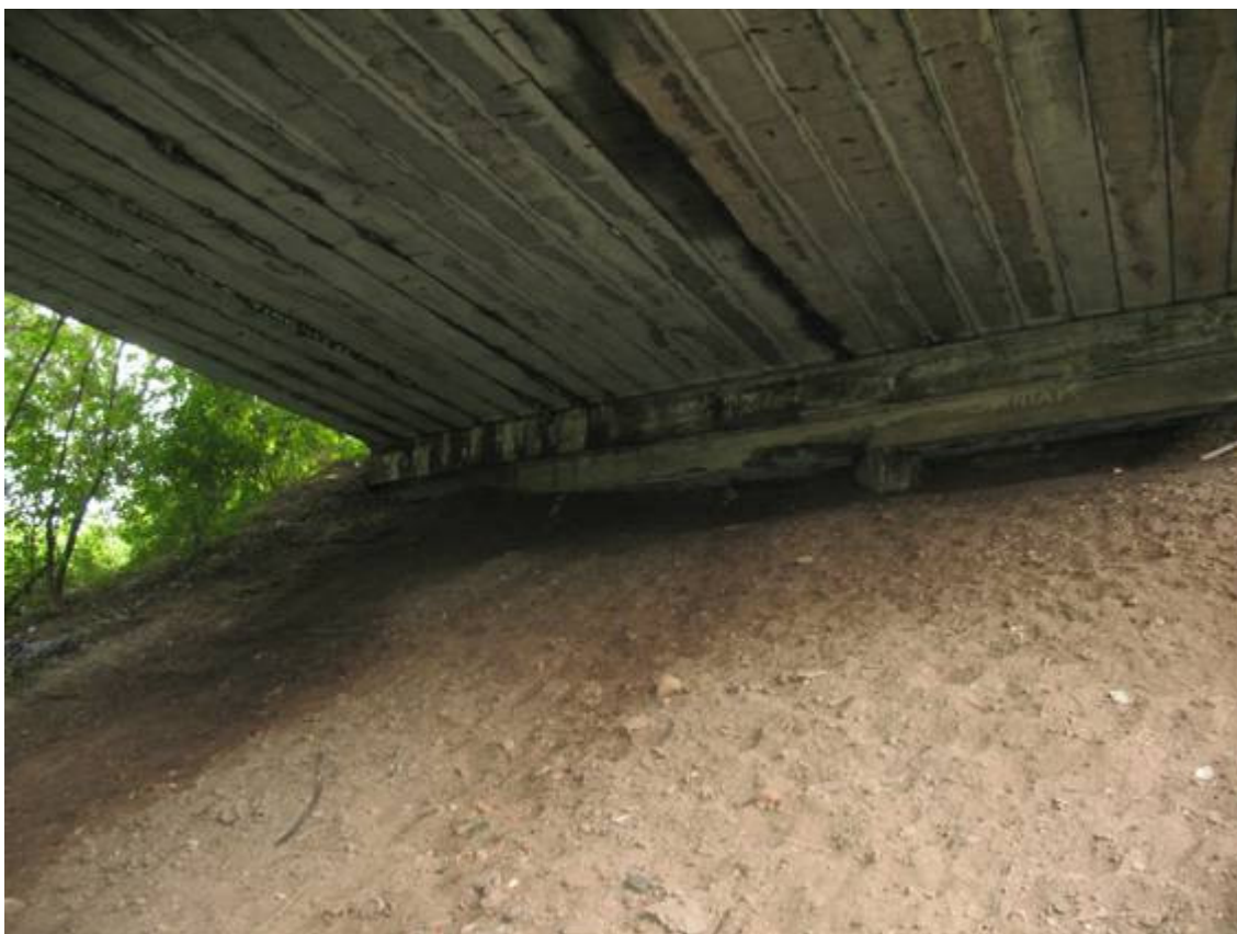
Fot.13. Widok na przyczółek ze strony południowej. Widoczne ubytki gruntu. Widoczne osady i wykwyty na powierzchni betonu.
