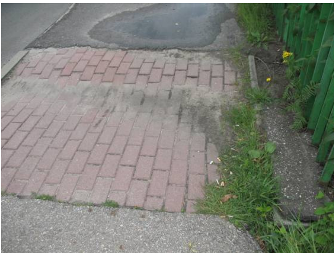
Fot. 36. Widok powierzchni chodnika nad przyczółkiem. Odkształcenia nawierzchni chodnika, zaleganie wody w niszach deformacyjnych. Widoczna wegetacja roślin.
