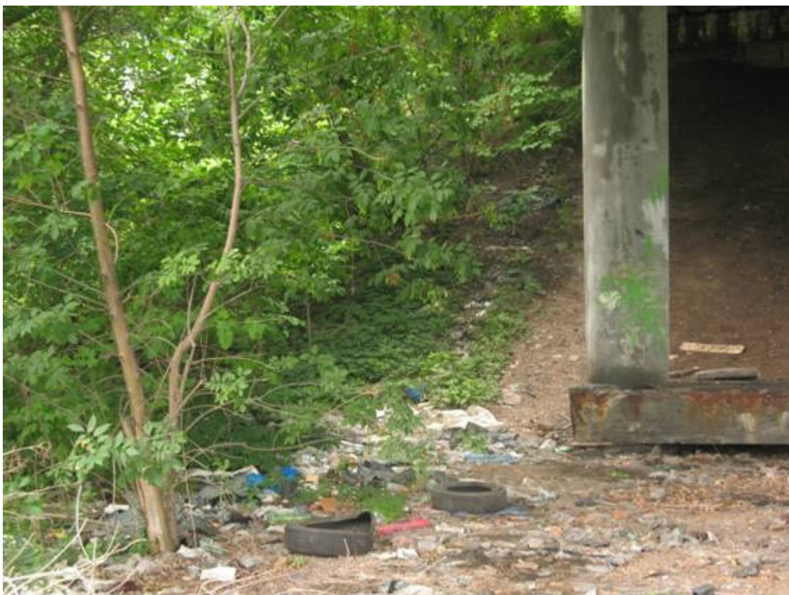
Fot. 5. Widok na stożek skarpowy od strony południowo-wschodniej. Wegetacja roślin na stożku skarpowym. Zanieczyszczenia (śmieci) pod obiektem.
