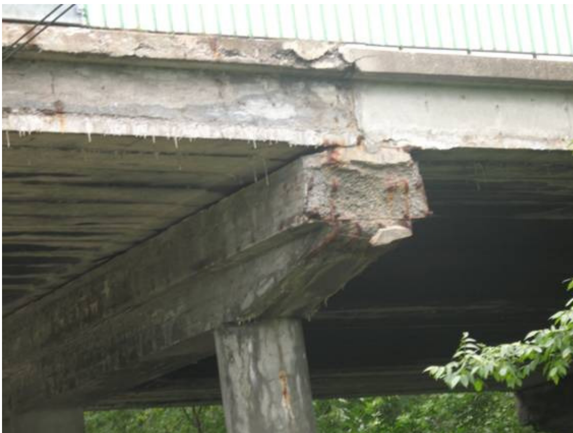
Fot. 17. Szczegół południowego oczepu po stronie zachodniej. Widoczne ubytki betonu z odstąpieniem zbrojenia. Korozja zbrojenia. Widoczne zacieki i osady na powierzchni betonu.
