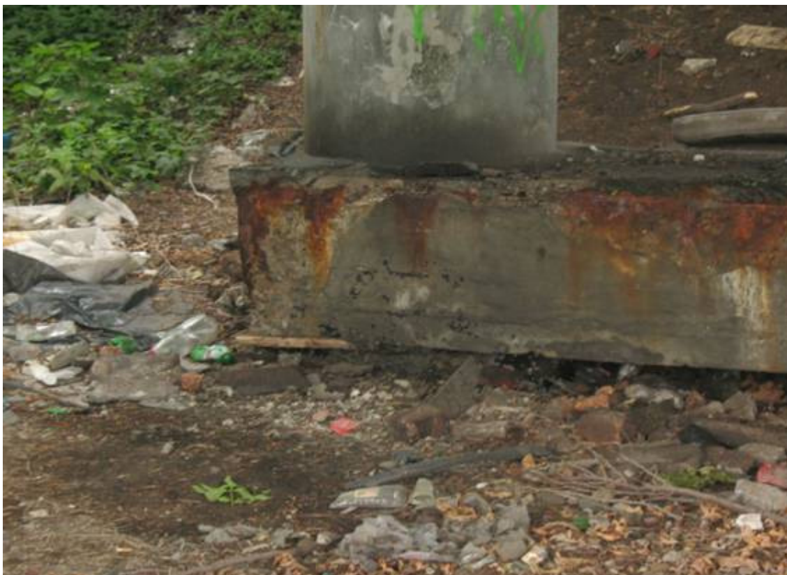
Fot. 29. Widok na filar i podstawę E. Widoczne ubytki betonu z odsłonięciem zbrojenia. Korozja zbrojenia. Zabrudzenia betonu (graffiti). Zarysowania na powierzchni betonu. Zawilgocona powierzchnia podstawy filara. Widoczne wykwity i osady na betonie. Ubytki gruntu pod podstawą. Gromadzenie odpadów pod obiektem.
