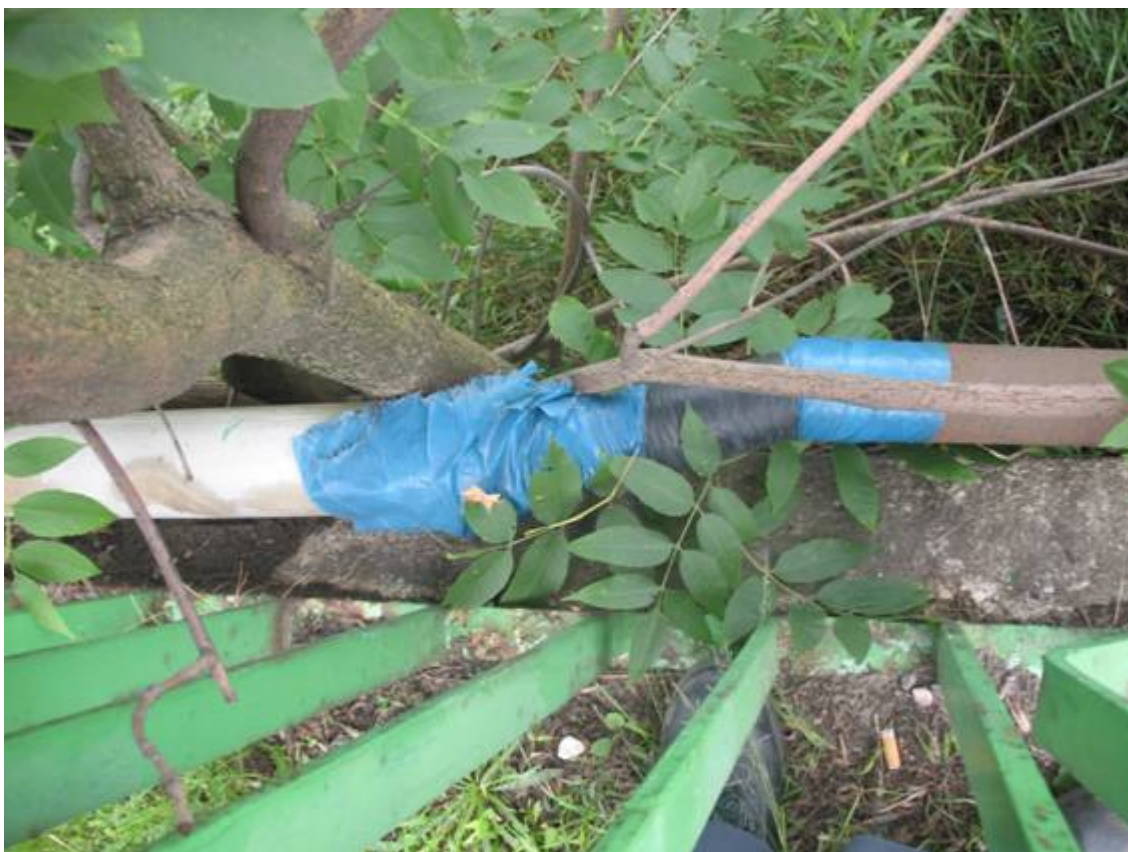
Fot. 37. Nieprawidłowe łączenie rur ochronnych instalacji na obiekcie po stronie północnej.
