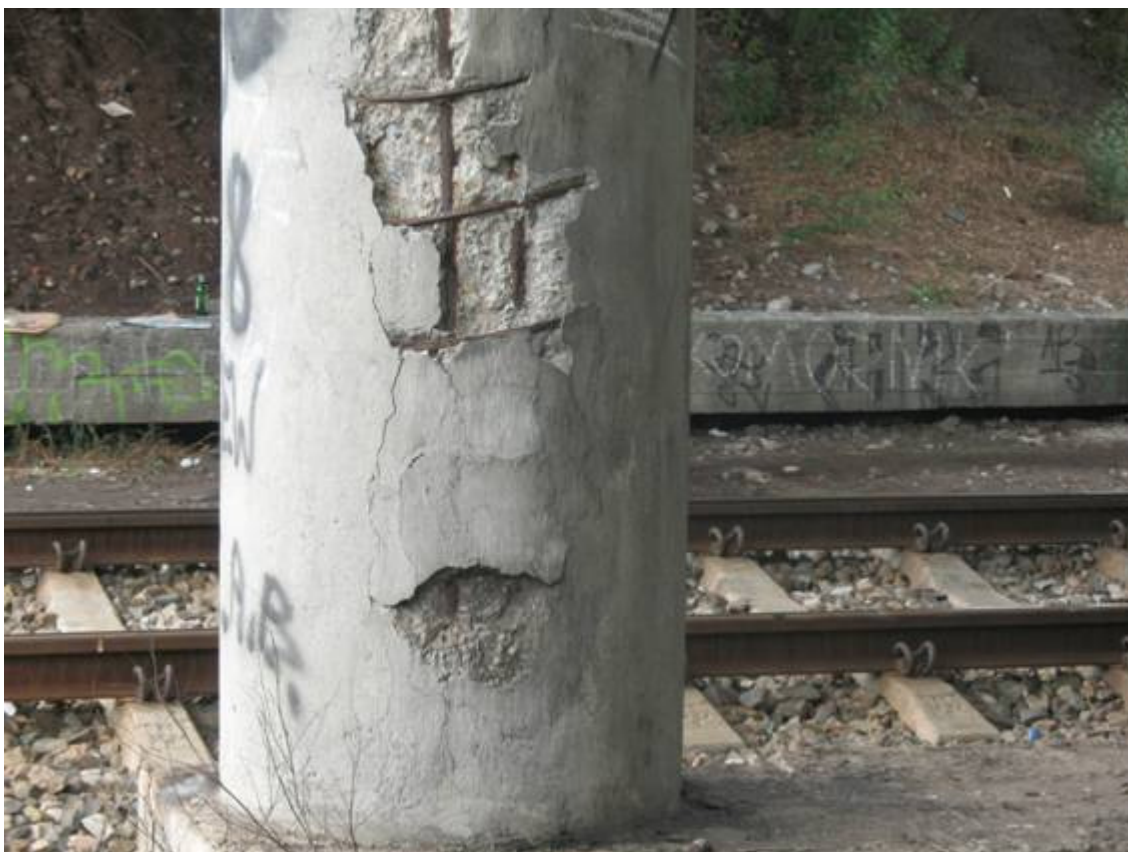
Fot. 23. Widok na filar. Widoczne ubytki betonu z odstąpieniem zbrojenia. Korozja zbrojenia. Zabrudzenia betonu (grafitti). Zarysowania na powierzchni betonu.
