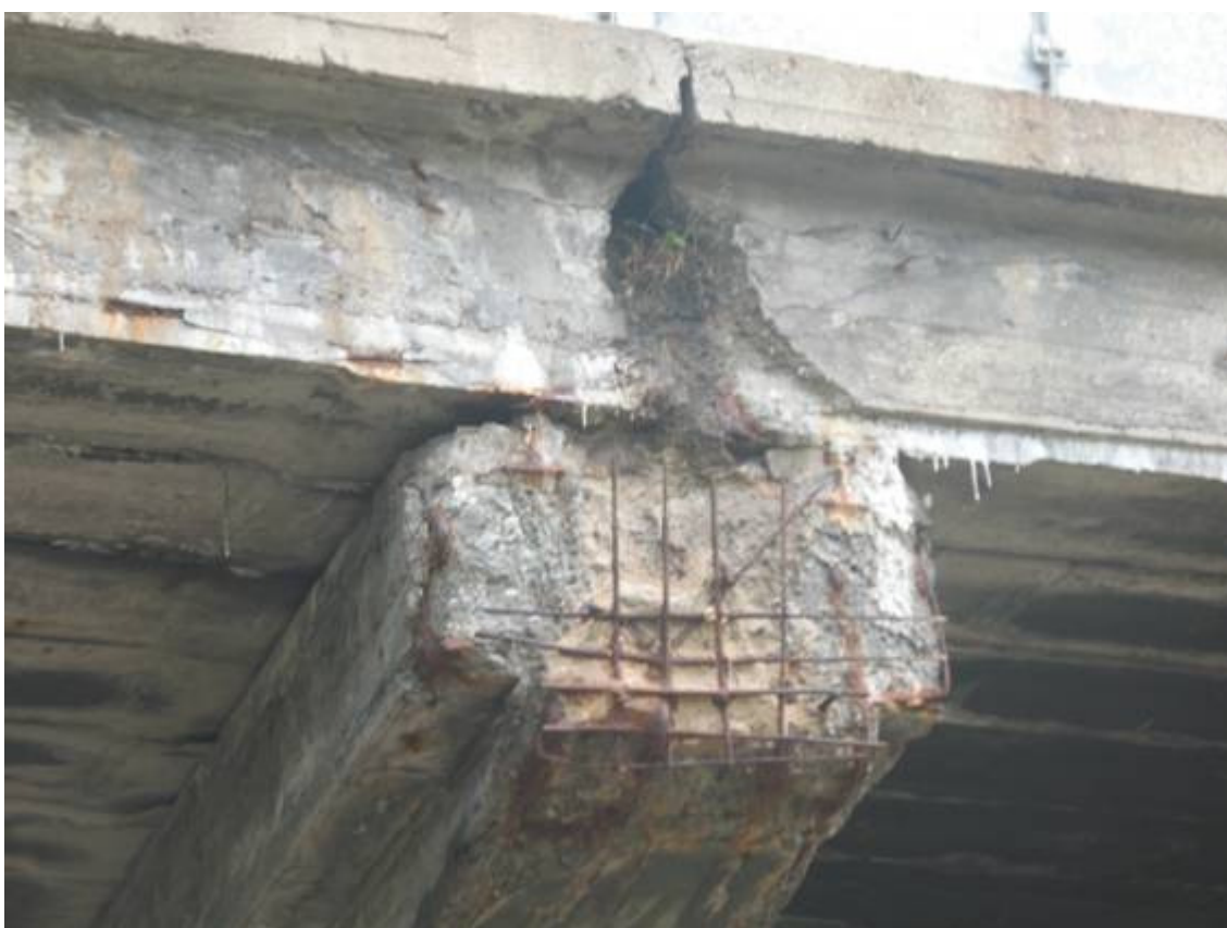
Fot. 18. Szczegół środkowego oczepu po stronie wschodniej. Widoczne ubytki betonu z odstąpieniem zbrojenia. Korozja zbrojenia. Zabrudzenia betonu. Widoczne zacieki i osady na powierzchni betonu. Widoczna wegetacja roślin we wnęce dylatacyjnej
