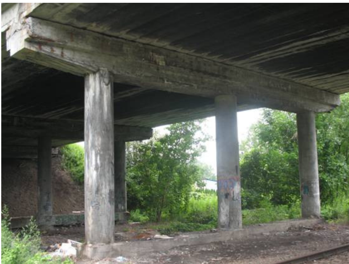
Fot. 12. Ustrój nośny. Widok na belkę oczepową, słup, i podstawę filara. Ubytki betonu na oczepach i podstawie podpory.
