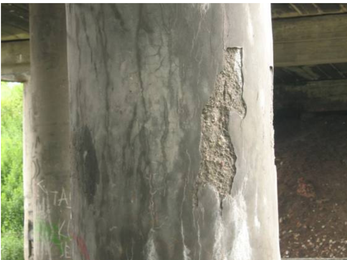
Fot. 24. Widok na filar. Widoczne ubytki betonu. Zabrudzenia betonu (grafitti). Zarysowania na powierzchni betonu. Wykwity i osady na powierzchni betonu.
