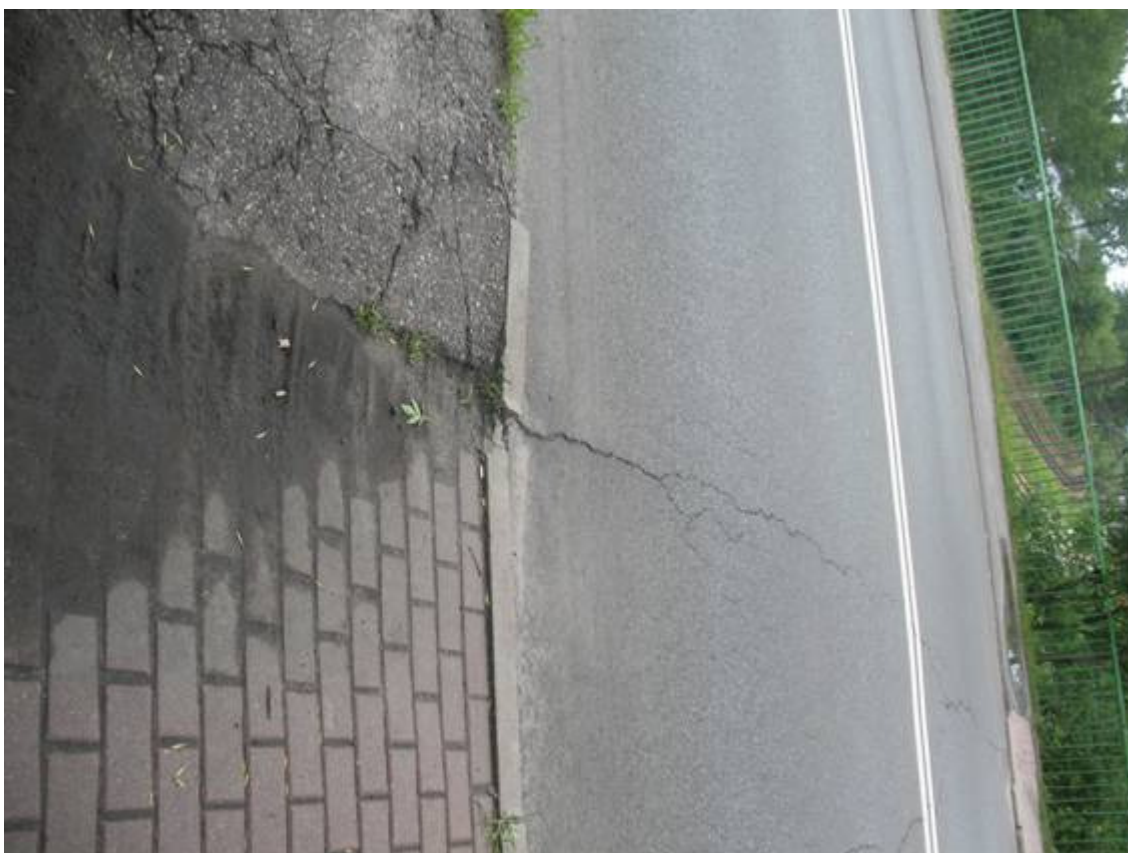
Fot. 36. Widok na powierzchnię chodnika nad przyczółkiem od strony północnej. Odkształcenia nawierzchni chodnika, oznaki zalegania wody w niszach deformacyjnych. Rysy na powierzchni jezdni. Widoczna wegetacja roślin.
