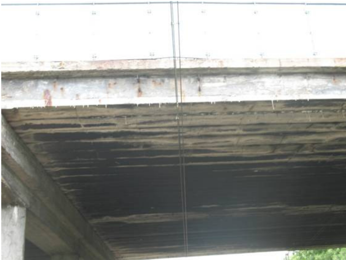
Fot. 10. Szczegół ustroju nośnego. Widoczne wykwity, osady i zacieki.
