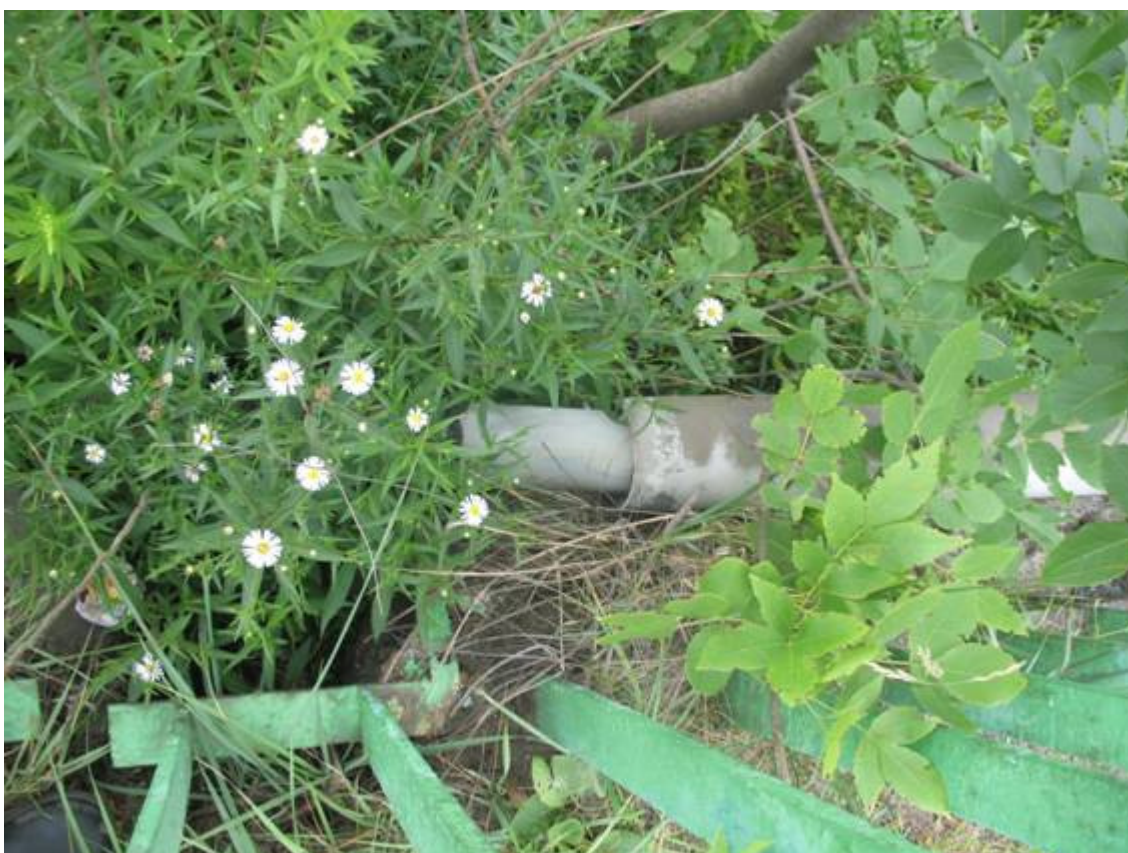
Fot. 38. Nieprawidłowe łączenie rur ochronnych instalacji na obiekcie po stronie południowej.
