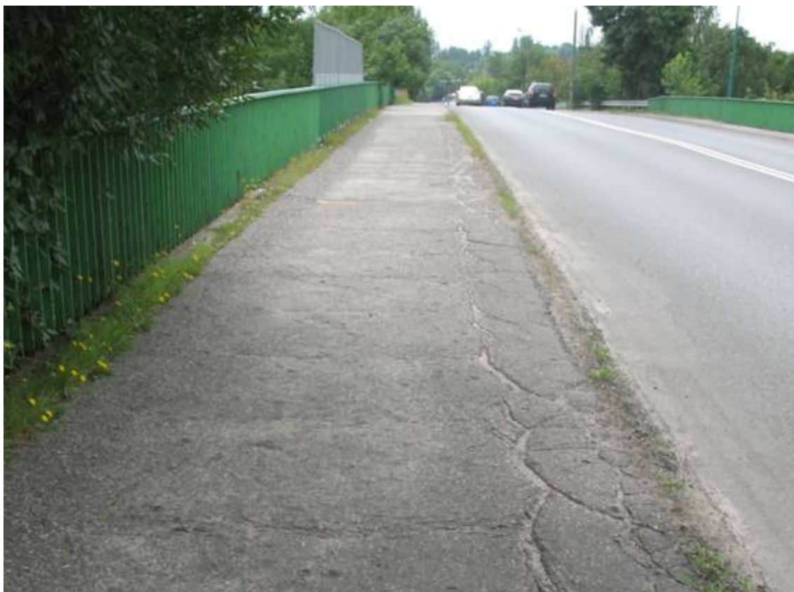
Fot. 7. Widok na chodnik po stronie wschodniej.
