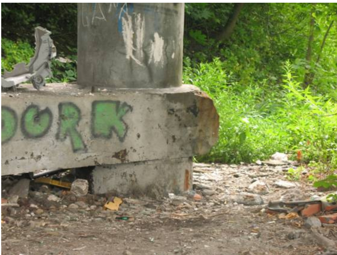
Fot. 28. Widok na filar i podstawę B. Widoczne ubytki betonu z odsłonięciem zbrojenia. Korozja zbrojenia. Zabrudzenia betonu (graffiti). Zarysowania na powierzchni betonu. Zawilgocona powierzchnia podstawy filara. Widoczne wykwity i osady na betonie. Ubytki gruntu pod podstawą.
