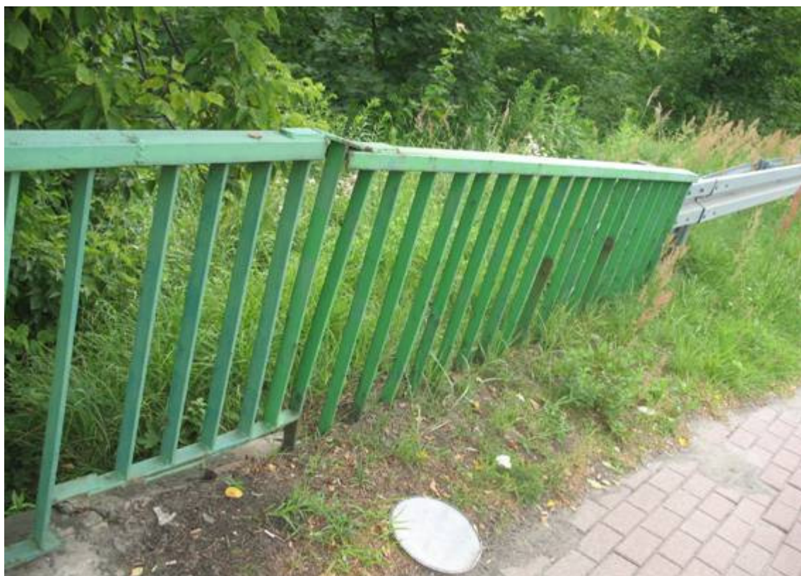
Fot. 34. Widok na barierki nad podporą południową. Deformacja barierek. Braki powłok antykorozyjnych, korozja stali.
