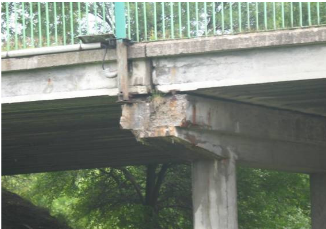
Fot. 15. Szczegół północnego oczepu po stronie zachodniej. Widoczne ubytki betonu. Korozja szyn stalowych zastępujących łożyska. Zabrudzenia betonu. Widoczne zacieki (stalaktyty wapienne) i osady na powierzchni betonu. Wegetacja roślin w wnęce dylatacyjnej.
