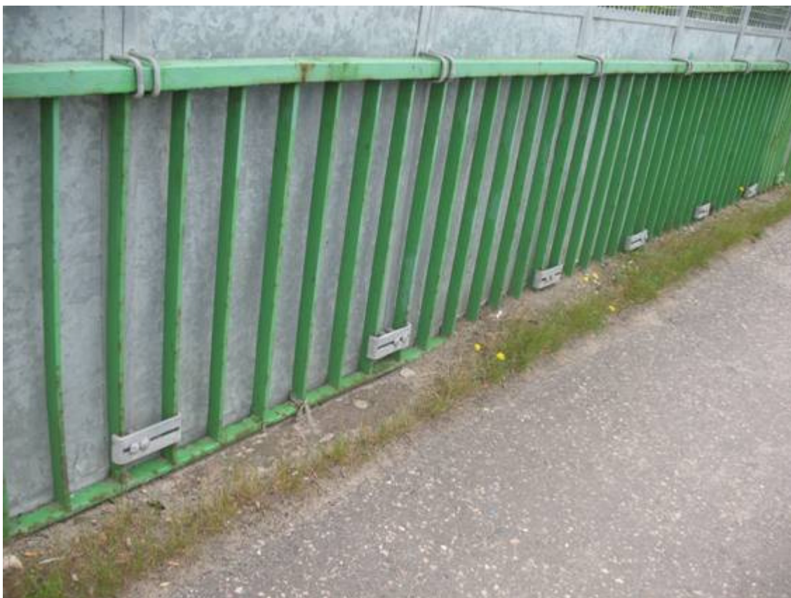
Fot. 35. Widok na mocowanie barier przeciwporażeniowych do barierek. Braki powłok antykorozyjnych, korozja stali. Wegetacja roślin na gzymsie.
