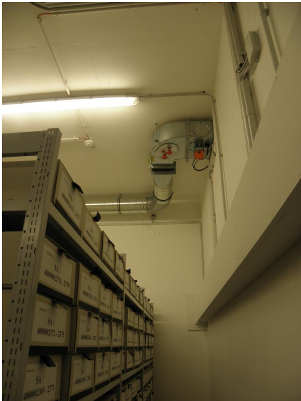
Przewody wentylacyjne odbierające powietrze z magazynu umieszczone po drugiej stronie pomieszczenia pod sufitem
